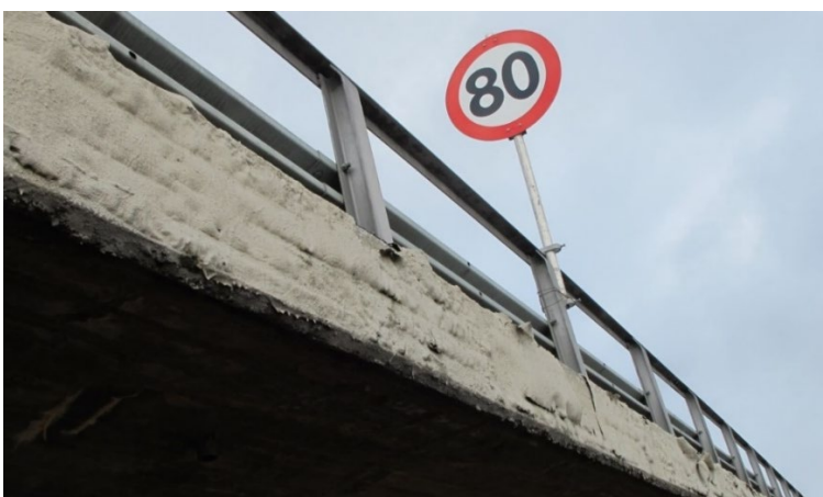
Figur 11 Omfattende avskalling av sementbasert belegg på kantdrager på Hotran bru på E6 sør for Levanger. Foto: Eva Rodum, Statens vegvesen.
