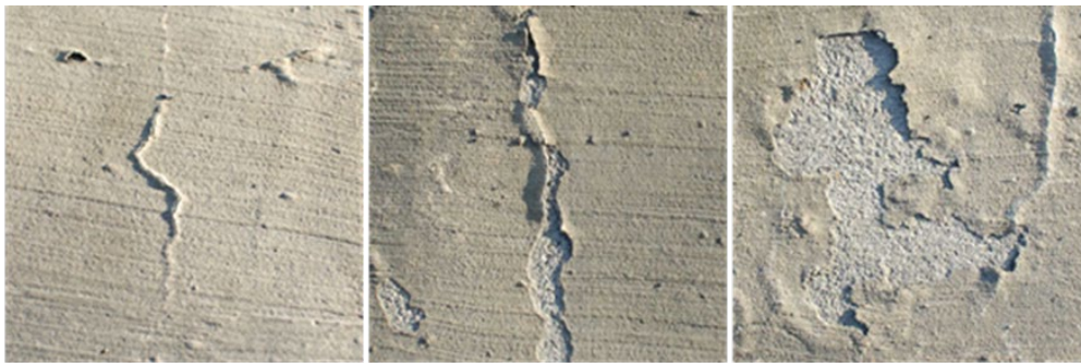
Figur 10 Rissutvikling fra a) initielt riss til b) gradvis hefttap nært riss og c) massiv flassing. Foto: Claus K. Larsen, Statens vegvesen /3/.
