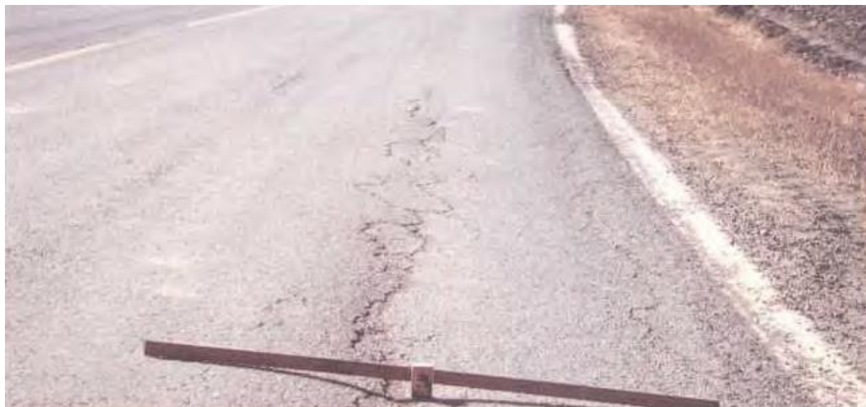
Figur 16 - Ujevnheter på grunn av lokale setninger [11:50]
