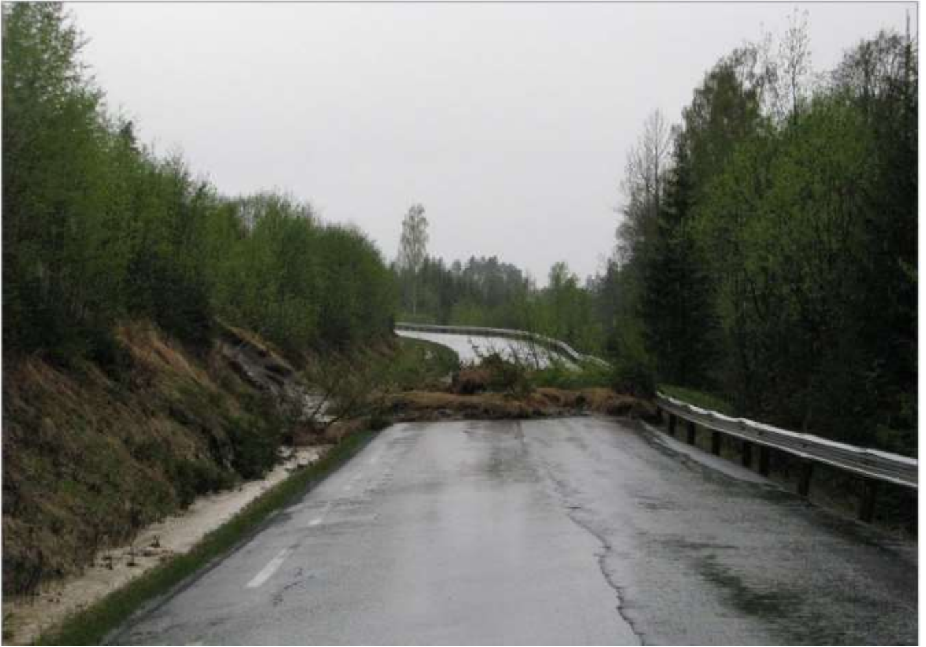
Figur 8.10 Skred 1 ved Fylkesvei 33 i Etnedalen i Etnedal kommune den 22.05.13 (Valdres, 2013b).
