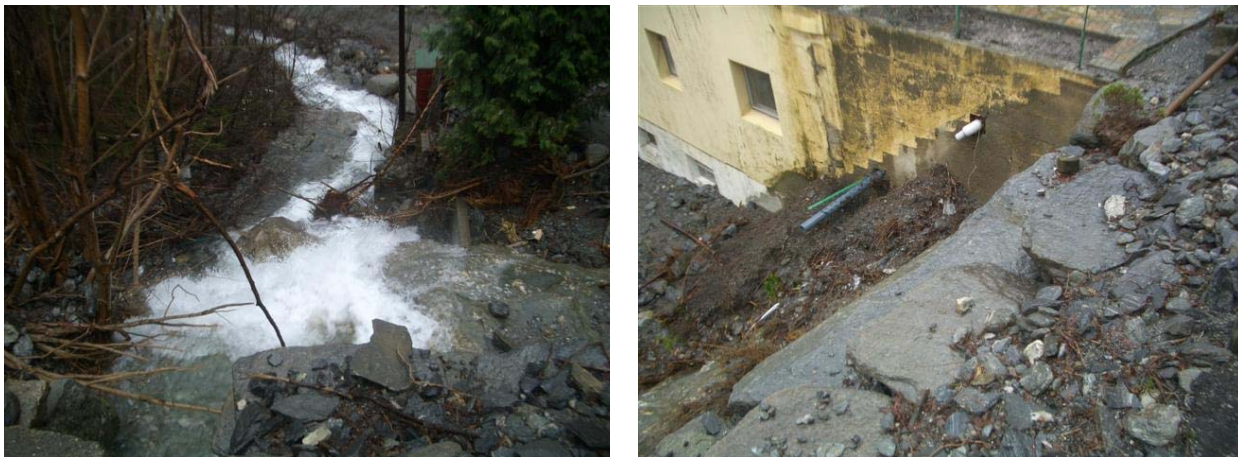
Figur 6-26 Plastret bekkeløp og skade nedstrøms riksveg
