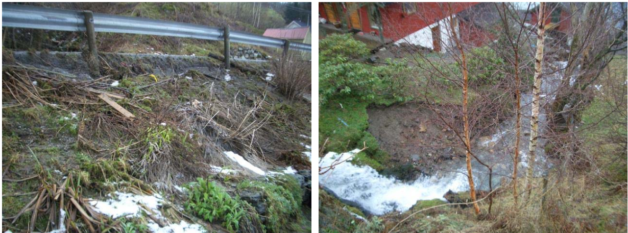
Figur 6-16 Tilstøtende eiendom til riksveg. Bildet til høyre viser bekkeløpet på nedstrøms side
