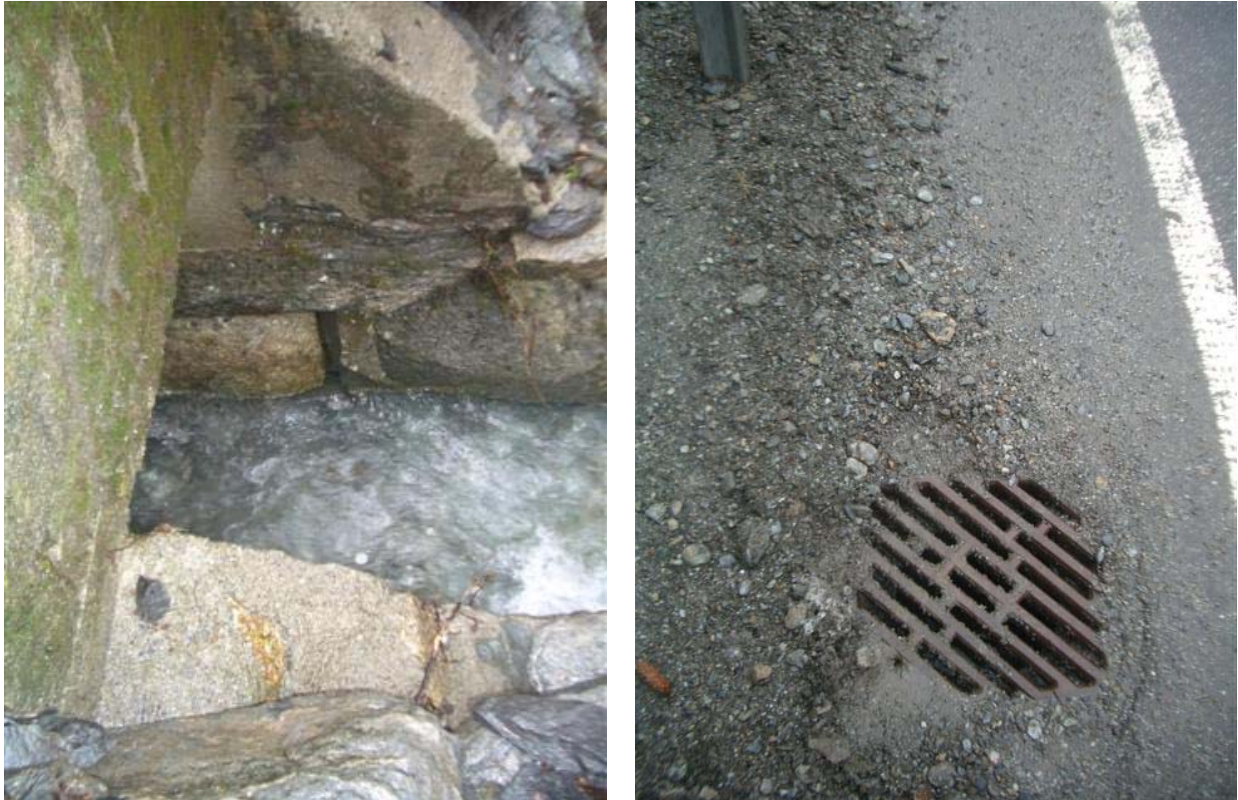
Figur 6-25 Innløp for Grautåbekken og innløp for å ta unna avrenning fra vegbanen
