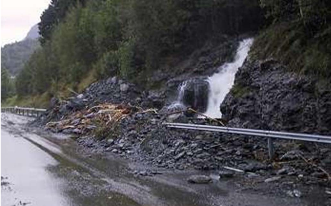
Figur 6-5 Grautåbekken etter delvis opprydding av riksveg (Skaar, 2005)
