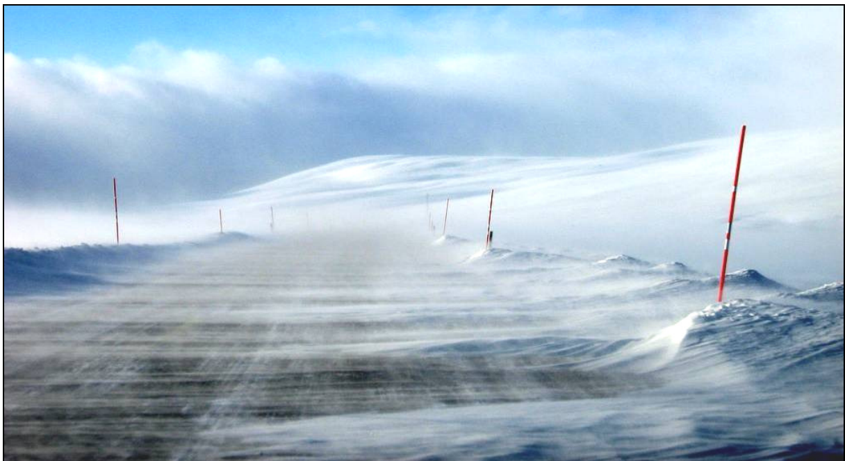
Figur 28 Utfreste brøytekanter på fylling, Saltfjellet
