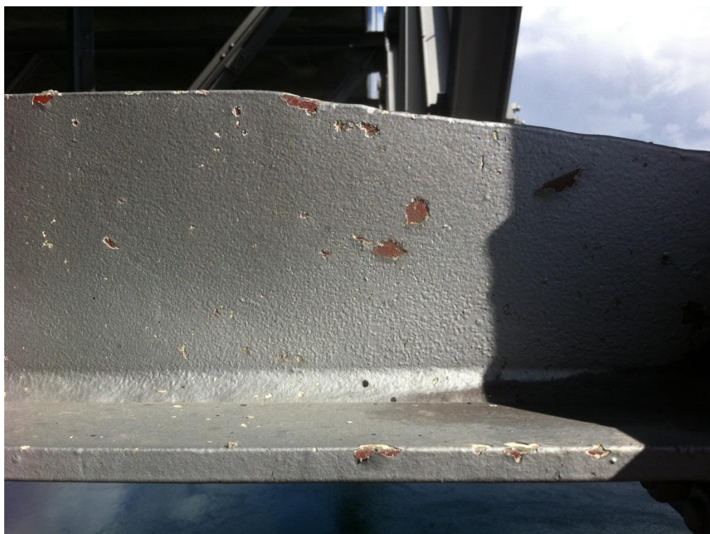
Figur 14. Mekaniske skader i belegget som følge av betongbiter som har falt ned på belegget.
