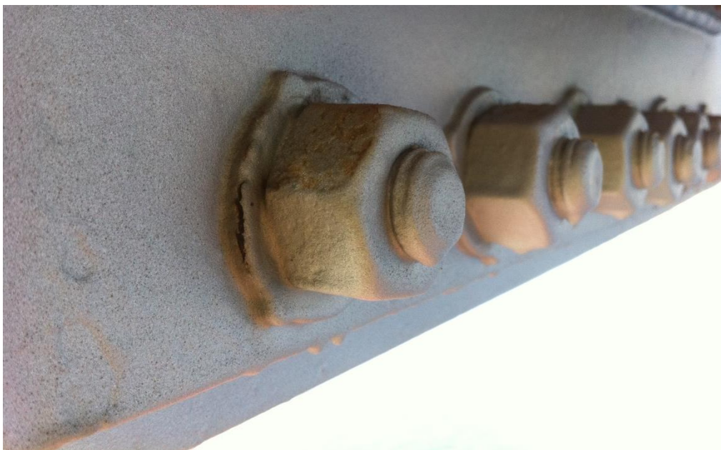
Figur 7. Sprukket belegg ved bolt.
