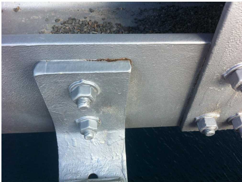
Figur 5. Korrosjon i laskeskjøt.
