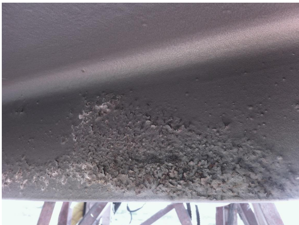
Figur 2. Nedbrutt belegg i undergurt (undersiden) på grunn av lav filmtykkelse
