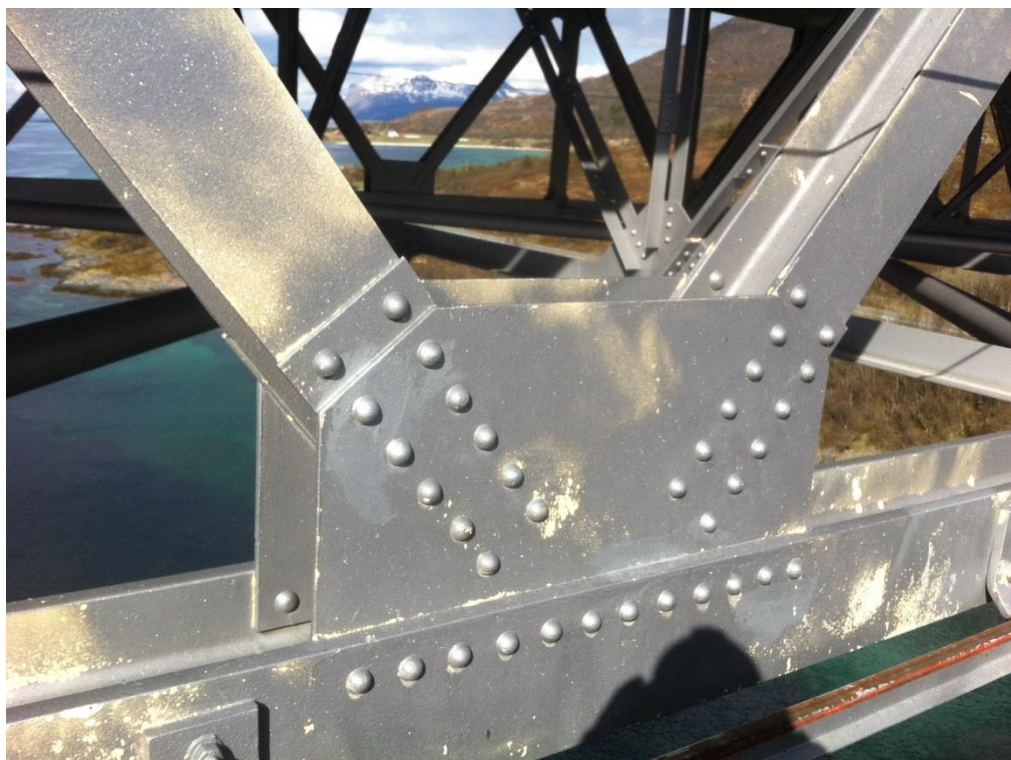
Figur 12. Toppstrøk påført for tynt eller slitt bort så underliggende strøk trer frem.
