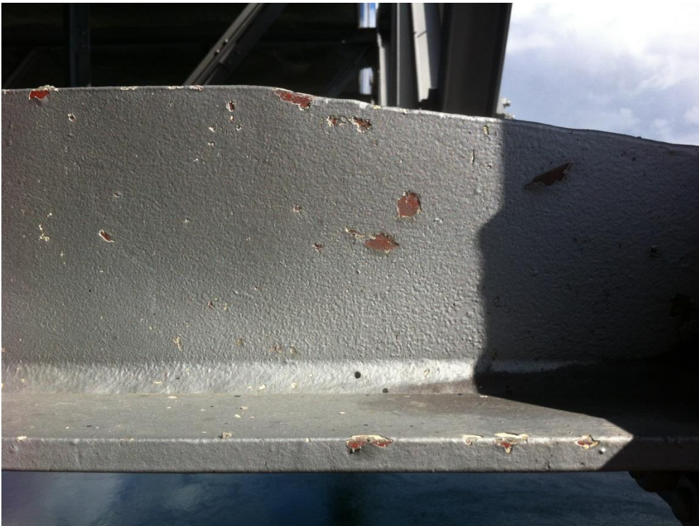
Figur 14. Mekaniske skader i belegget som følge av betongbiter som har falt ned på belegget.
