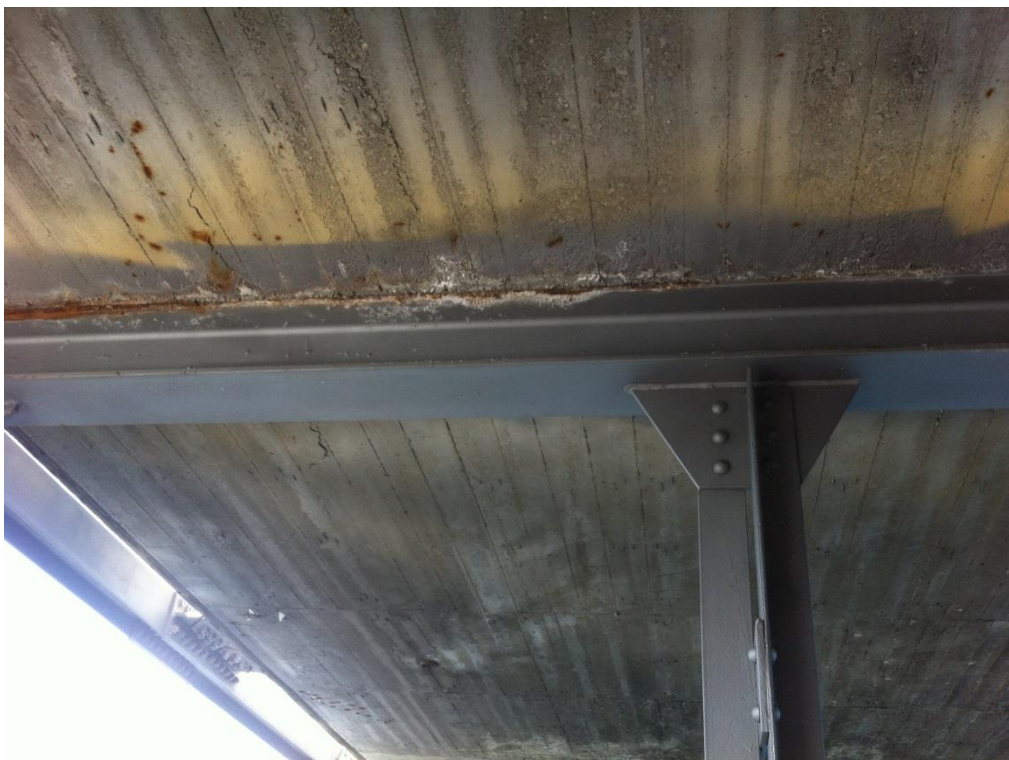
Figur 3. Nedbrutt belegg på I-bjelke mot betong.
