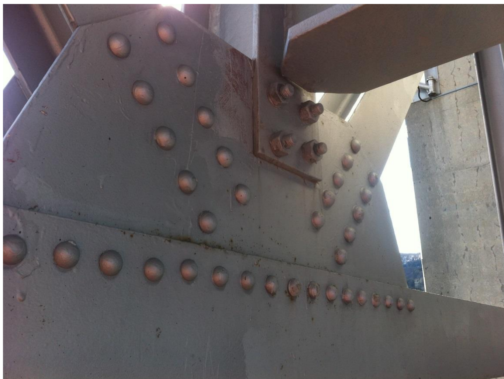
Figur 6. Gjennomslag av rust på kanter og omkring naglehoder.
