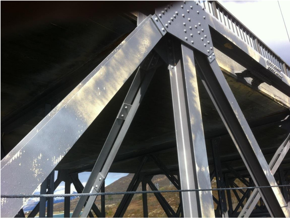
Figur 13. Wire langs sørsiden av brua har slitt av toppstrøket.
