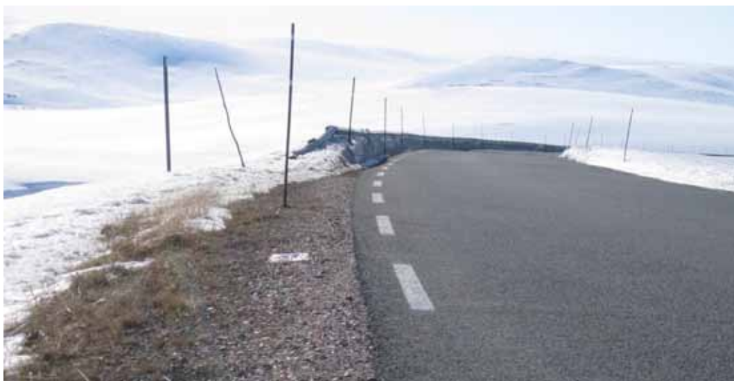
Figur 5-6. Fonndannelse ved rekkverksende. Fv. 891 Gednje-Båtsfjord. (Foto Yngve Øverli)
