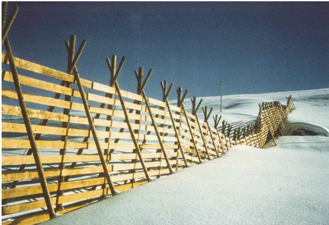
Figur 7-6. Snøskjermer er mest effektive når de står normalt på vindretningen og følger ryggen i terrenget. Ved kryssing av forsenkningen burde denne skjermen vært forhøyet. (Foto: Harald Norem)
