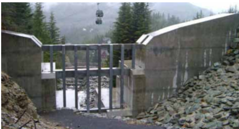
Figur 6.25 Eksempel på åpen kontrolldam med stålbjelker for å retardere og holde igjen skredmassene. Dammen er dimensjonert for et skredvolum på ca 30 000 m 3 . Whistler Mountain, Canada. Unzen, http://step.ipgp.fr/images/e/e3/09_02_Debris_Flow_Mitigation.pdf
