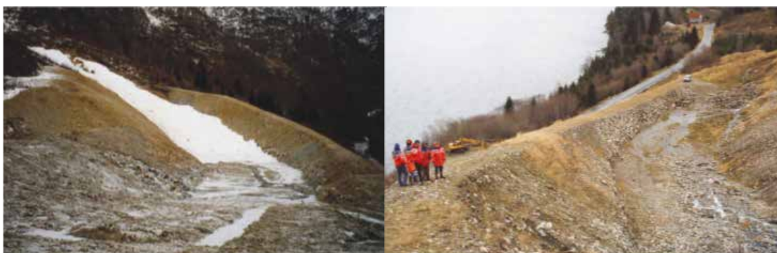
Figur 6.13 Eksempel på ledevoll for sikring mot snøskred og sørpeskred. Vollkrona er dessverre ikke bygget med jamn stigning i øvre delen av vollen, og på dette partiet har skred gått over vollen, Sandvika, Sogn og Fjordane. Foto: Harald Norem
