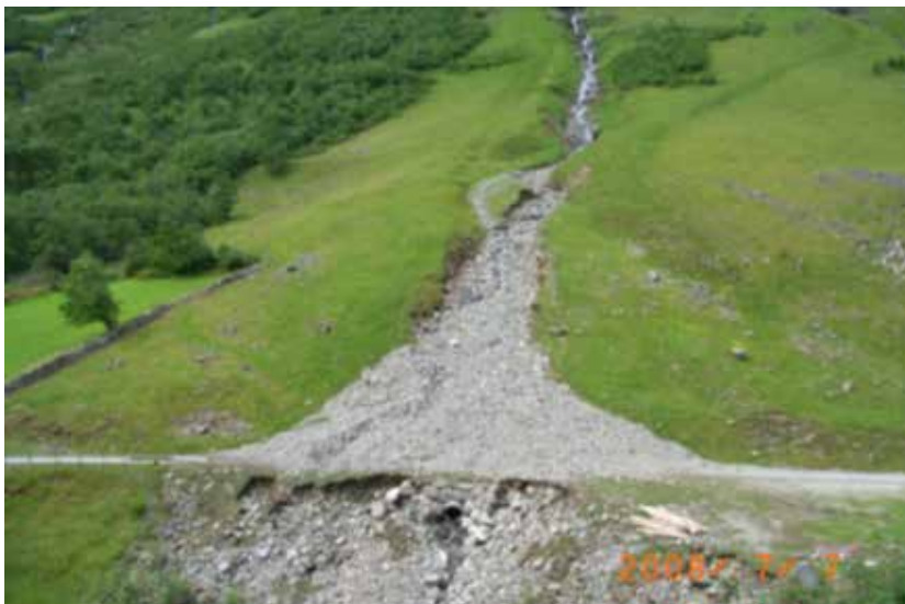
Figur 6.33 Foto av erosjon i flombekk og som har ført steinmasser fram til vegen, sperret stikkrenne og ført til store erosjonsskader. Fv. 241 Gudvangen-Bakka, Sogn og Fjordane. Foto: S. H. Frækaland
