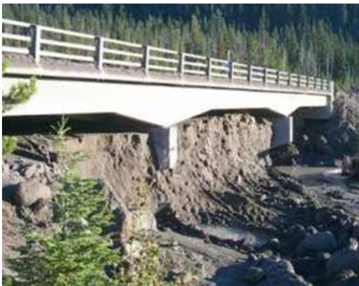
Figur 6.23 Foto av bru hvor skredet har stoppet opp under brua. White River Bridge, Oregon. (Armstrong et al).
