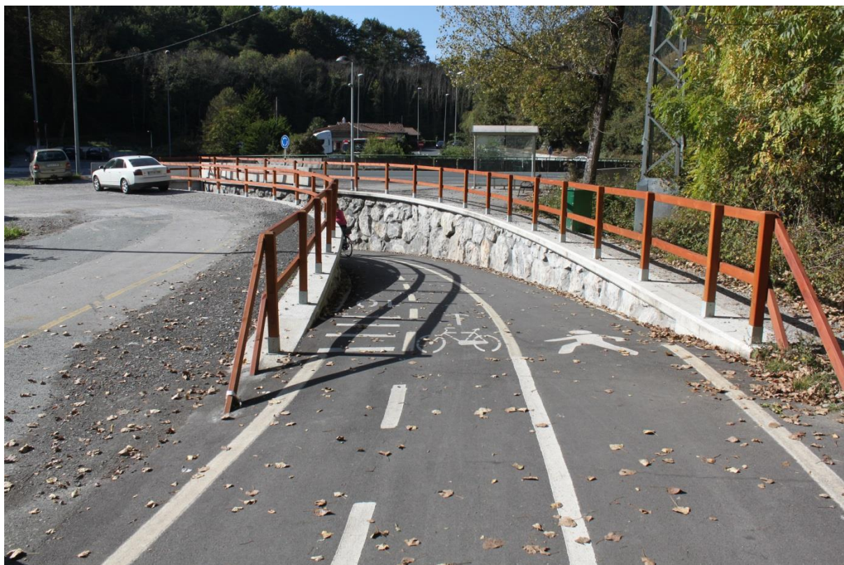
Figur 24: Nedramping mot kulvert under en trafikkert hovedveg. Krapp nedramping med dårlig sikt.
