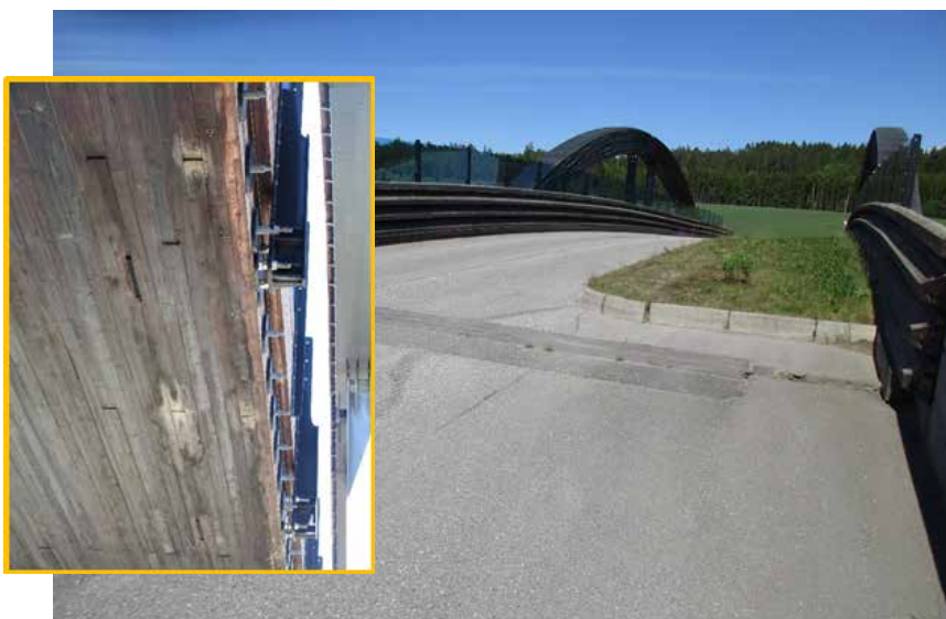
Eksempel V1.5-3 Lekkasje/fuktbelastning
