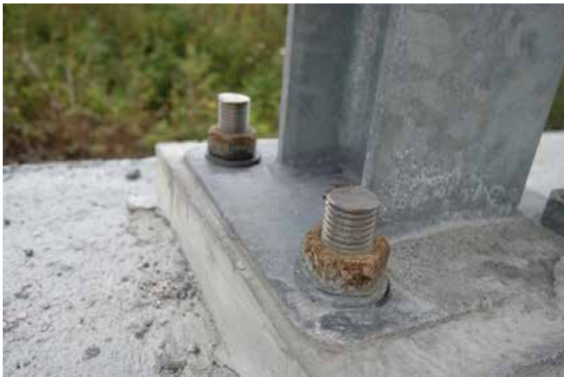
Eksempel V4.4-2 Korrosjon
