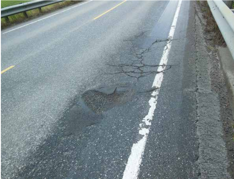
Eksempel V7.3-2 Krakelering/hull
