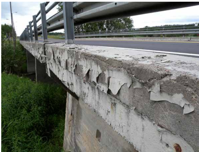
Eksempel V3.2-2 Skade på overflatebehandling
