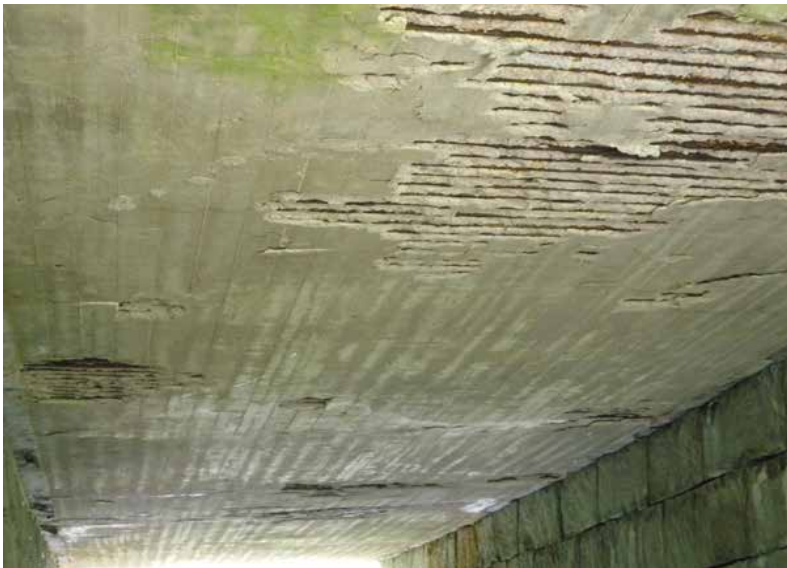
Eksempel V3.8-2 Armeringskorrosjon
