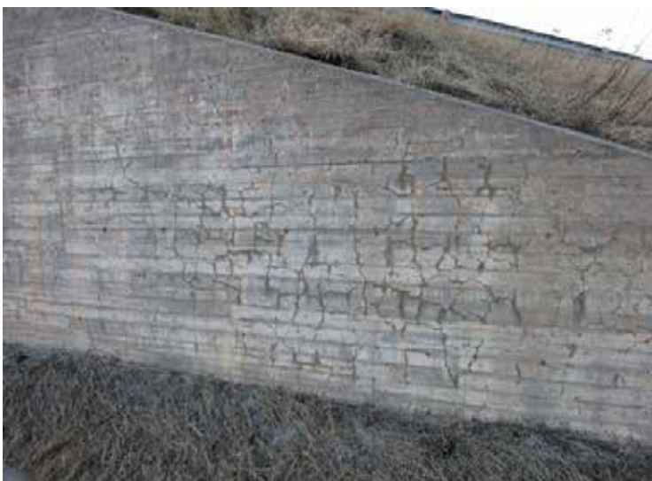
Eksempel V3.1-1 Riss/sprekk i betong
