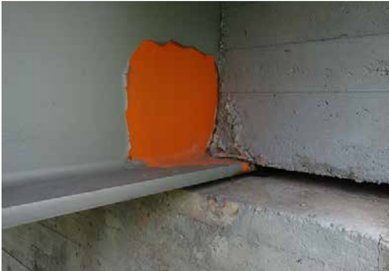
Eksempel V4.2-2 Skade på overflatebehandling
