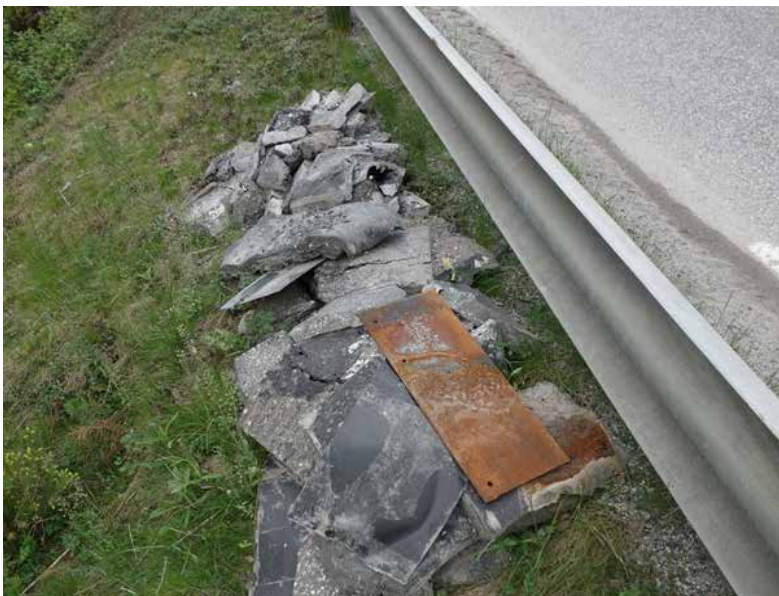
Eksempel V8.3-4 Manglende opprydding/fjerning
