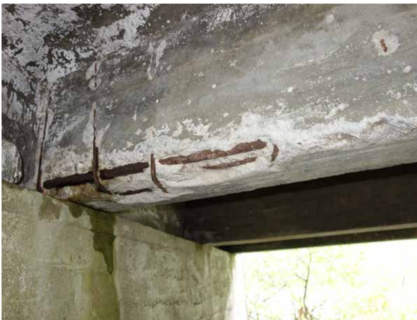
Eksempel V3.8-1 Armeringskorrosjon
