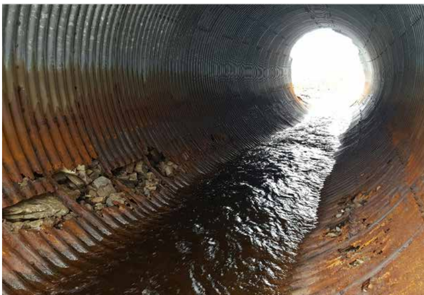
Eksempel V4.4-1 Korrosjon
