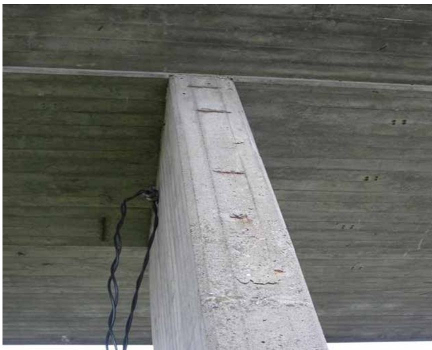
Eksempel V3.8-4 Armeringskorrosjon
