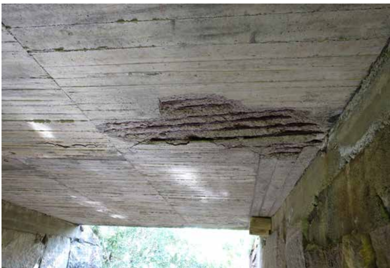
Eksempel V3.8-3 Armeringskorrosjon
