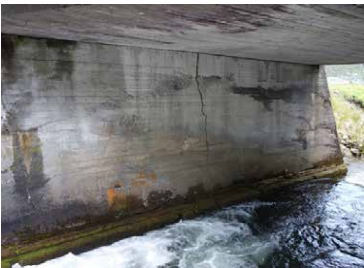
Eksempel V3.1-2 Riss/sprekk i betong
