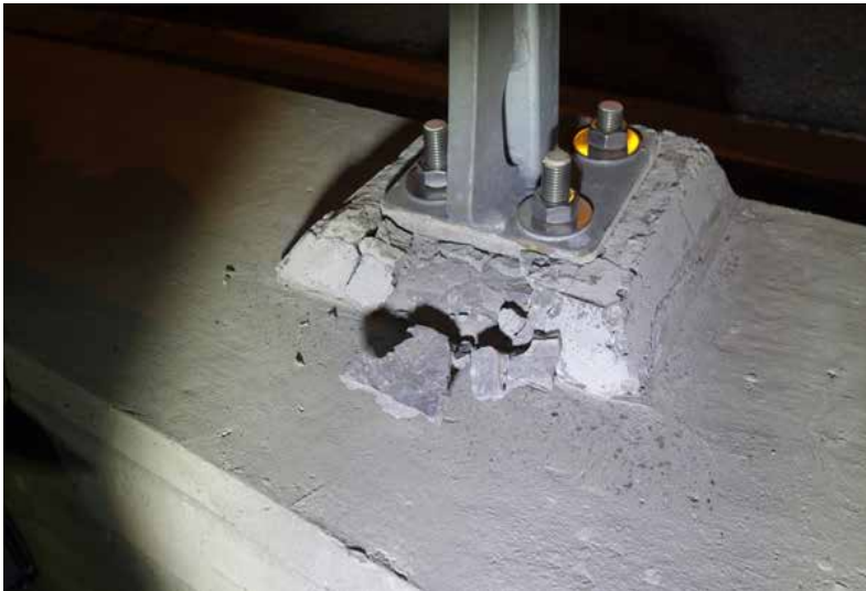
Eksempel V3.7-2 Avskalling
