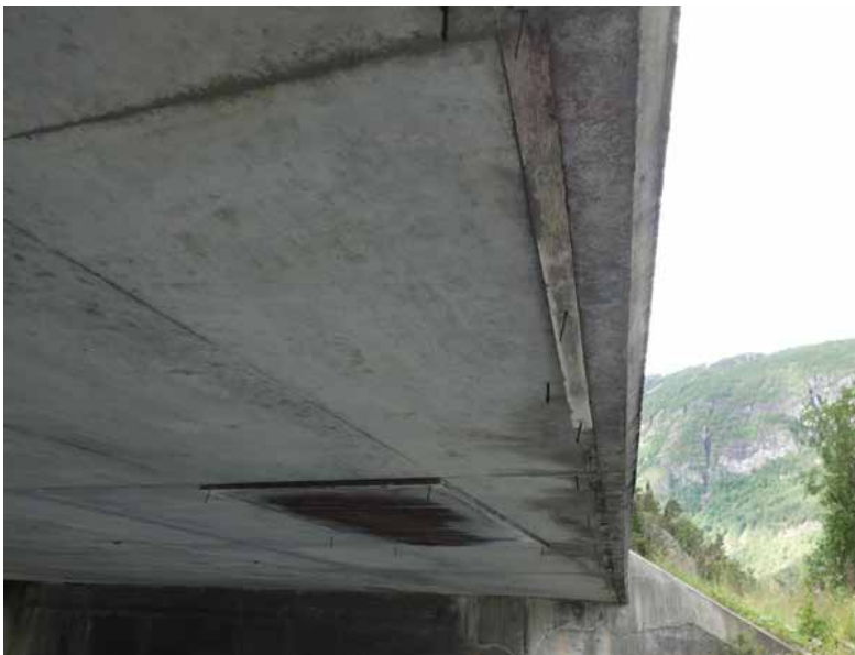
Eksempel V8.3-3 Manglende opprydding/fjerning
