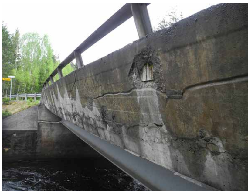
Eksempel V3.7-1 Avskalling
