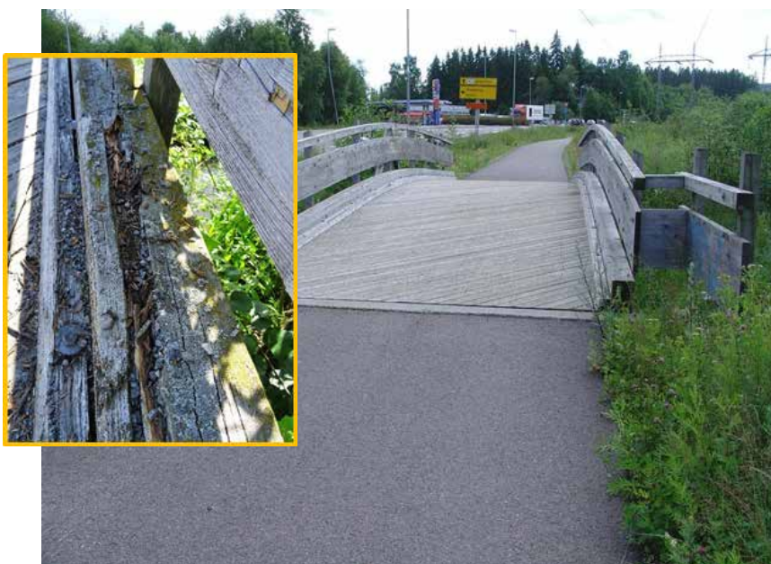
Eksempel V6.4-1 Råte/nedbrytning
