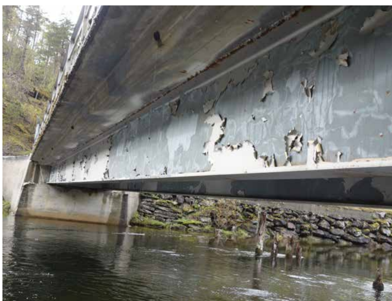
Eksempel V4.2-1 Skade på overflatebehandling
