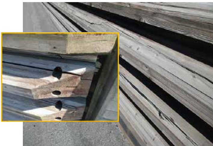
Eksempel V6.1-1 Riss/sprekk i tre
