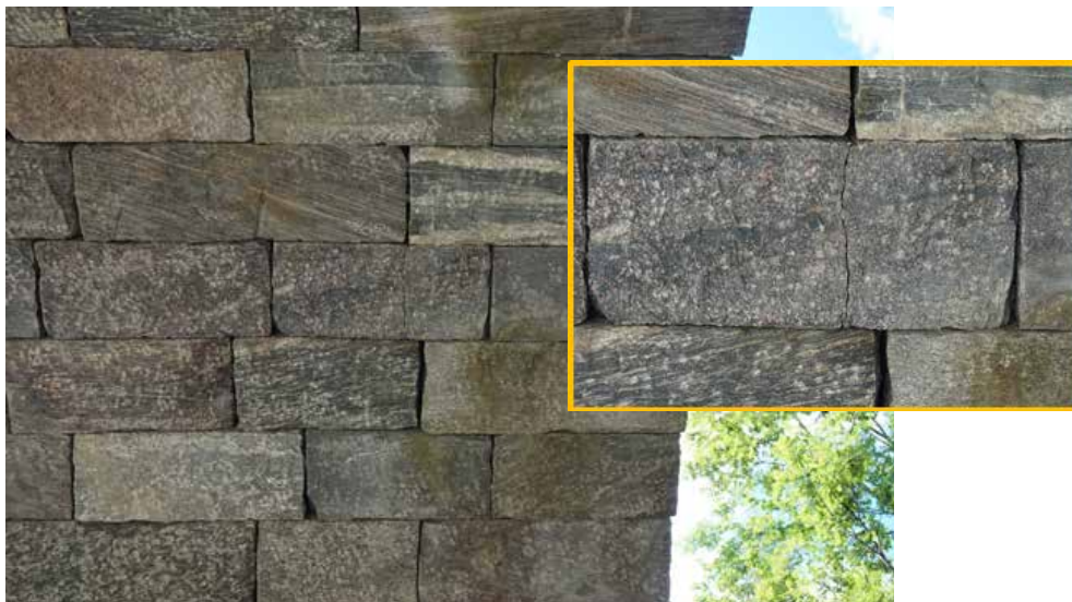
Eksempel V5.1-1 Riss/sprekk i stein
