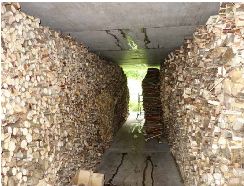
Eksempel V8.3-5 Manglende opprydding/fjerning
