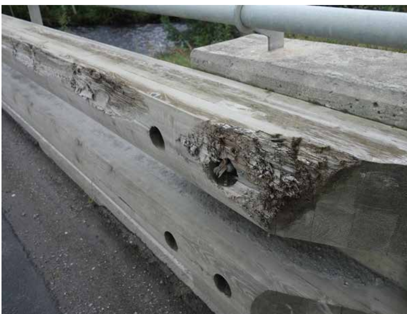
Eksempel V6.3-1 Mekanisk skade
