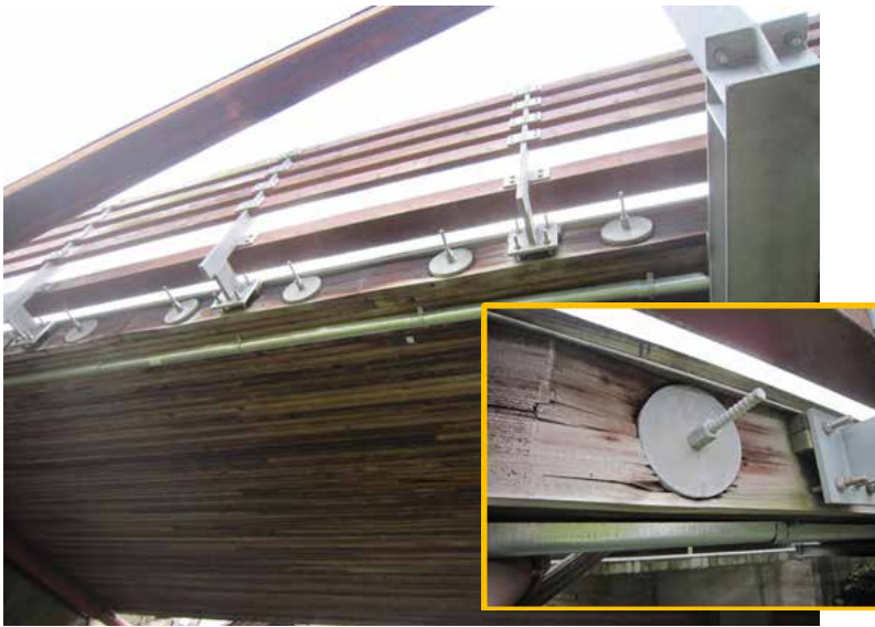
Eksempel V6.3-2 Mekanisk skade
