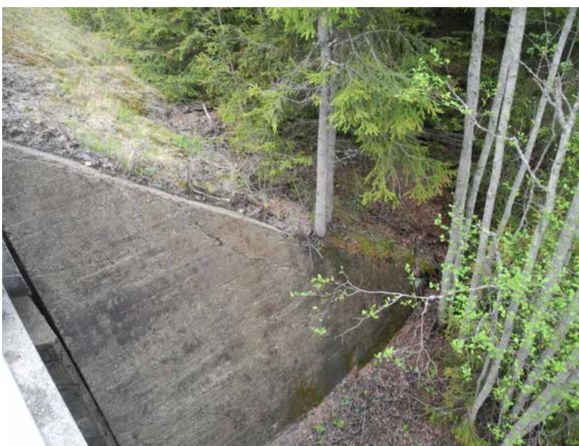
Eksempel V8.3-1 Manglende opprydding/fjerning
