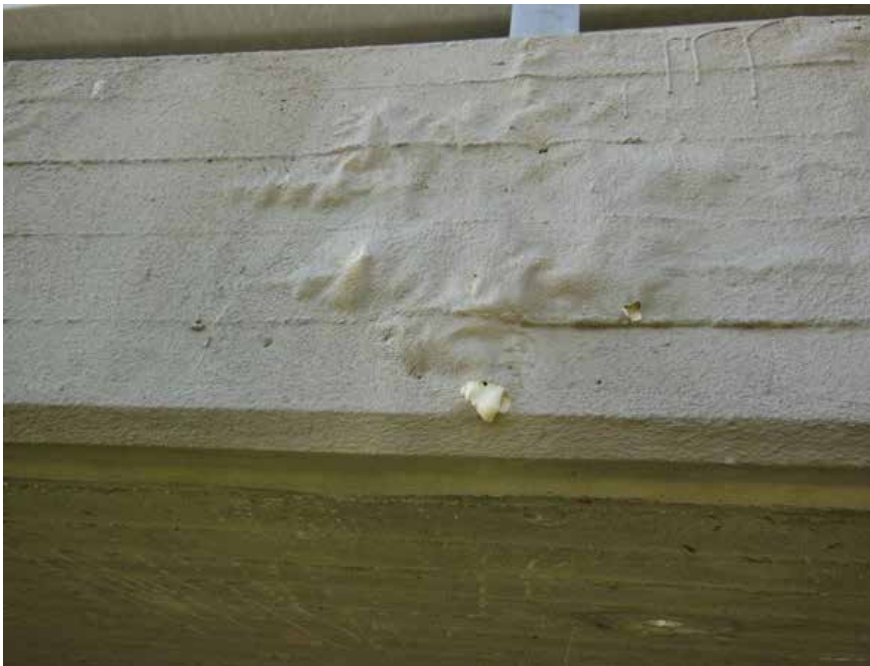
Eksempel V3.2-1 Skade på overflatebehandling
