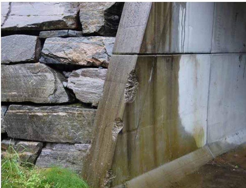
Eksempel V3.7-3 Avskalling
