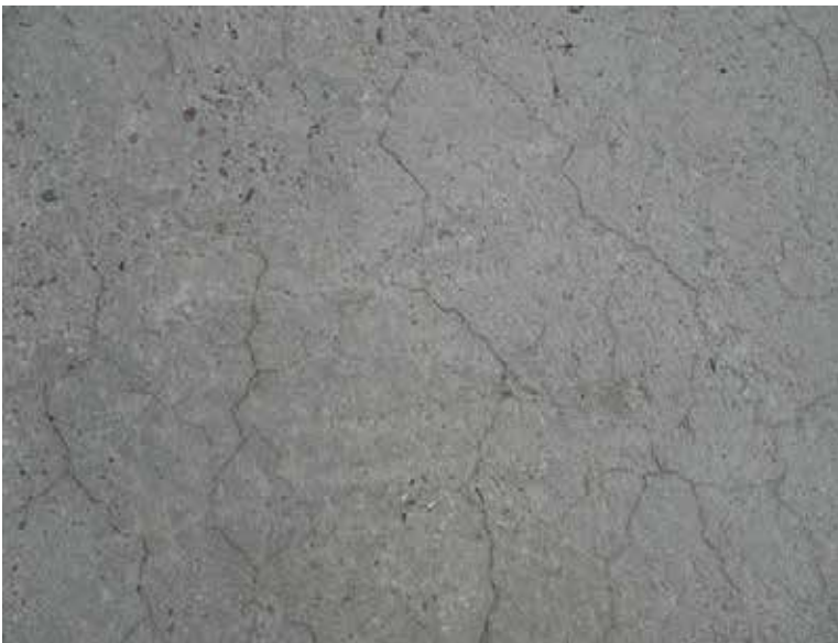
Eksempel V7.4-3 Riss/sprekk i betongslitelag
