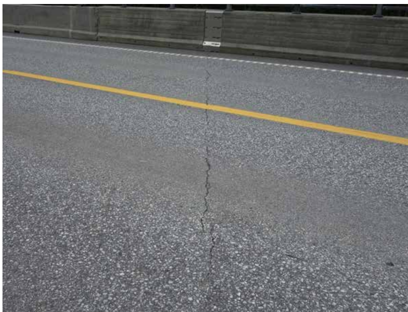
Eksempel V7.4-1 Riss/sprekk i slitelag
