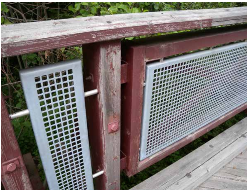
Eksempel V6.2-1 Skade på overflatebehandling
