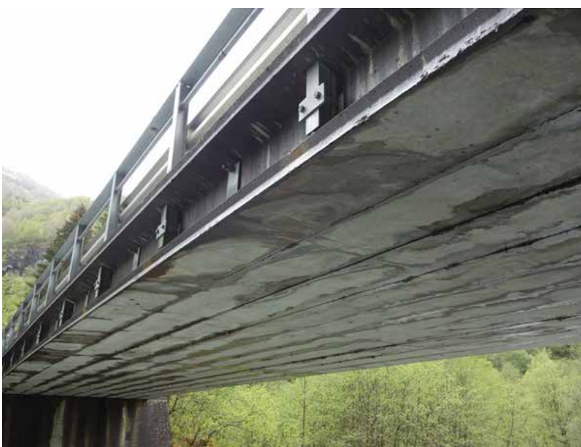
Eksempel V1.5-1 Lekkasje/fuktbelastning
