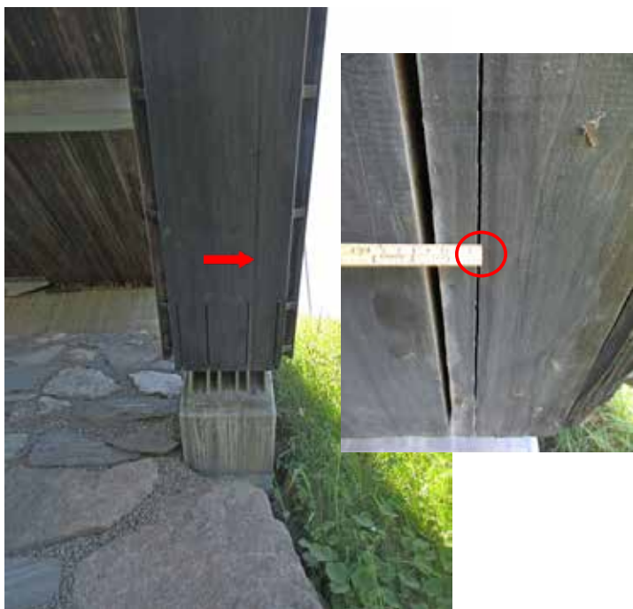
Eksempel V6.1-2 Riss/sprekk i tre
