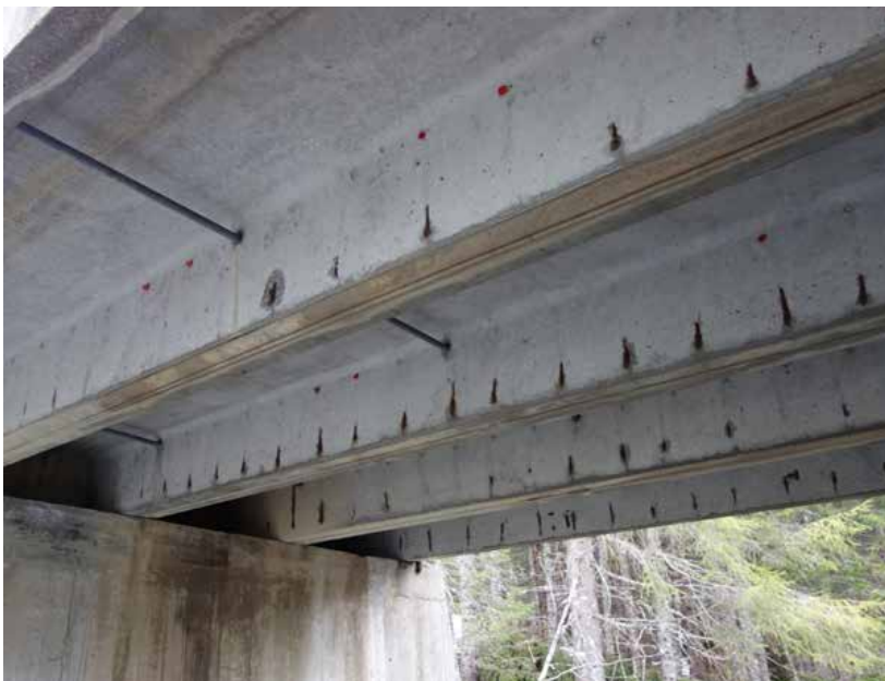
Eksempel V3.3-1 Liten/skadet overdekning
