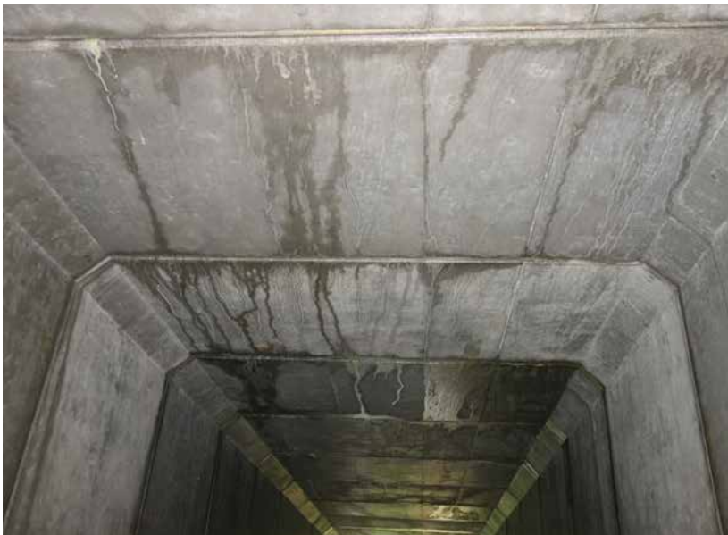
Eksempel V1.5-2 Lekkasje/fuktbelastning
