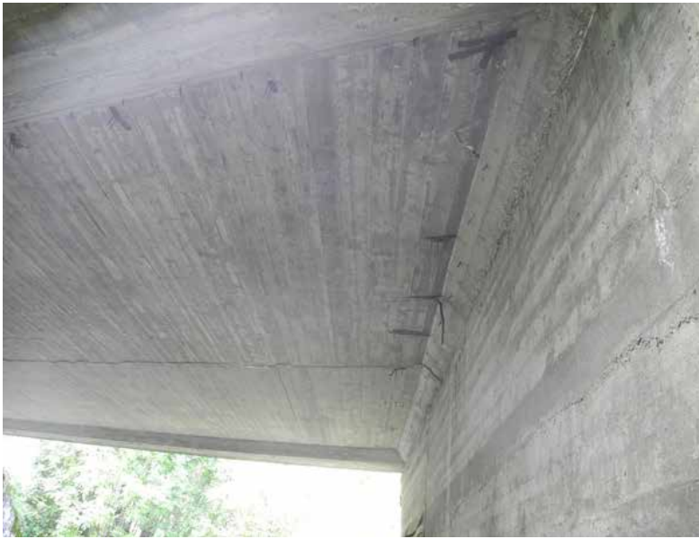
Eksempel V8.3-2 Manglende opprydding/fjerning
