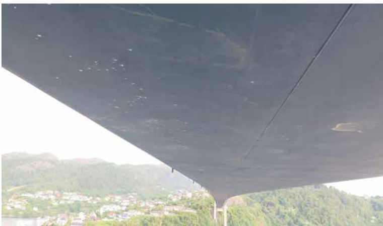
Eksempel V4.2-3 Skade på overflatebehandling
