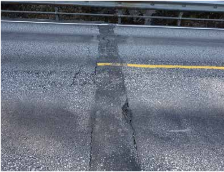
Eksempel V7.4-2 Riss/sprekk i slitelag
