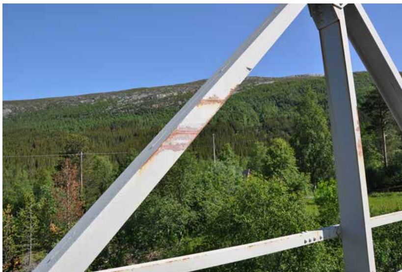
Eksempel V4.2-4 Skade på overflatebehandling
