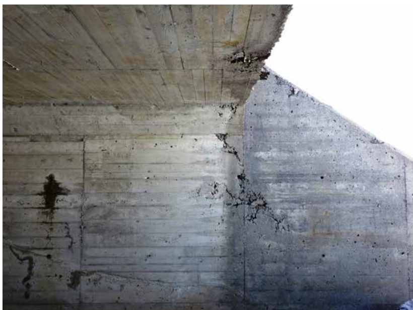
Eksempel V3.5-1 Støpesår
