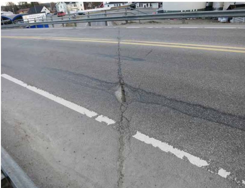
Eksempel V7.3-1 Krakelering/hull
