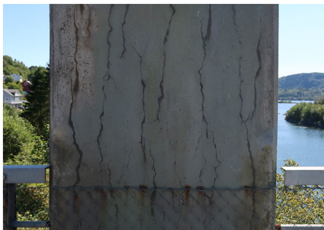
Figur 12 Hengebrutårn med vertikale riss på grunn av alkalireaksjoner (Foto: Eva Rodum, Statens vegvesen)
