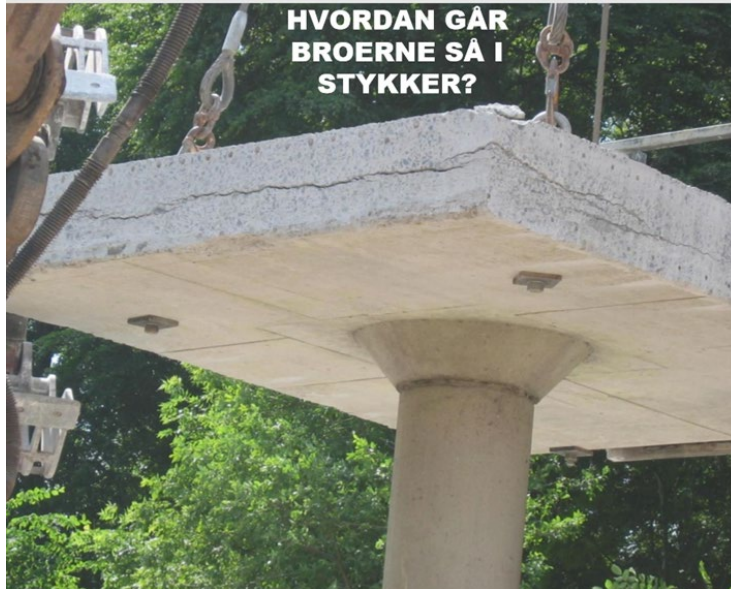
Figur 15 Deler av demontert brudekke med horisontal delaminering på grunn av alkalireaksjoner (Ref: Arne Henriksen, Vejdirektoratet/DK)
