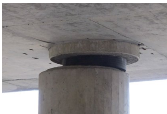
Figur 14 Lager på Fiborg bru skjøvet ut av stilling på grunn av alkalireaksjoner i bruplata (Foto: Eva Rodum, Statens vegvesen)
