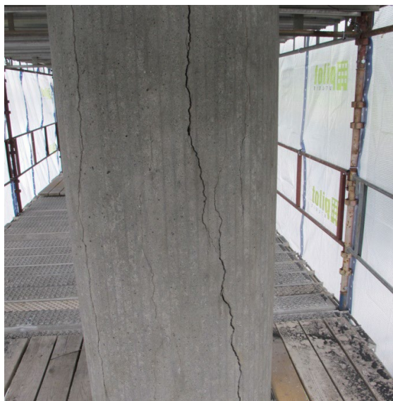
Figur 11 Søyle på Elgeseter bru med vertikalt riss på grunn av alkalireaksjoner (Foto: Eva Rodum, Statens vegvesen)
