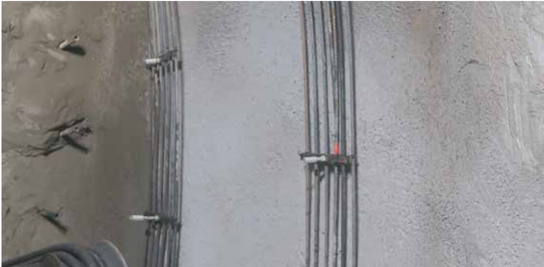
Figur 4.29 Første lag armering er lagt på avjevningen nær stuff, og med skjøtehylser er det klargjort for senere dobling. Legg merke til pluggen i skjøtehylseåpningene, og at konturen allerede er boret og isatt foringsrør for lading etter sprøyting av buene. Fra E39 Råtunnelen i Bergen. (Foto: Statens vegvesen)
