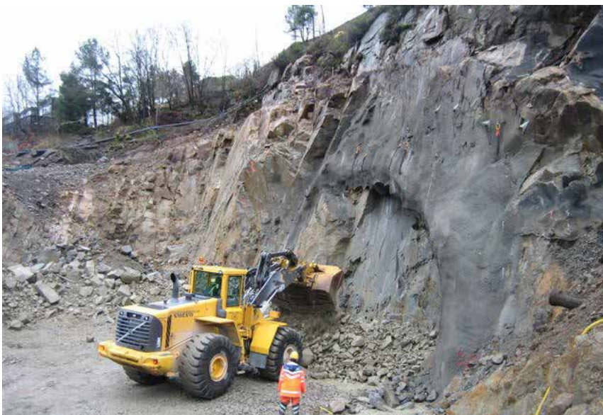
Figur 4.4 Skrått påhugg, flaten står omtrent 45^\circ på tunnelens retning. Påhuggsflaten er også tilpasset markerte sprekkeplan (med steilt fall mot venstre). Det er satt en bue med kamstål på forbolter rundt åpningen. Ringveg Vest Bergen, 1.byggetrinn (Foto: T. Kirkeby).
