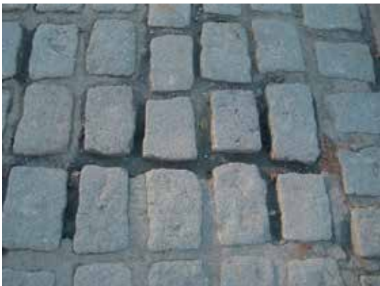
Figur V1.1 Manglende fugemørtel i øvre del av fugen (foto: René Kierstein)
