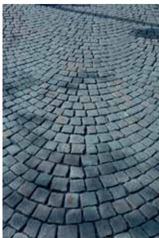
Fuge av sand uten finstoff, krever hyppig etterfuging
