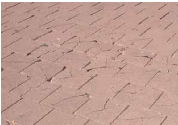
Lokale skader etter arbeidsmaskin
