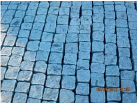
Figur V1.8 Mangelfull forband før ferdigstilling vil resultere i at belegget ikke vil holde (foto: René Kierstein)
