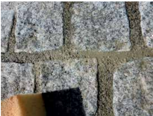
Figur 7.7 Refuging med reparasjonsmørtel (foto: Rudi Grimelid)
