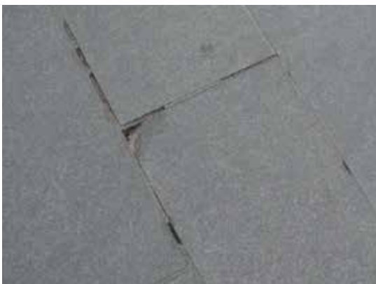
Figur V1.6 Avskallinger grunnet spenninger (foto: René Kierstein)
