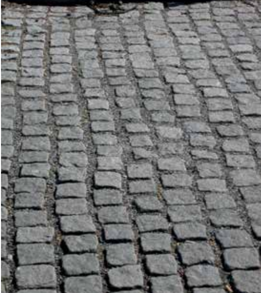
Figur V1.7 Dårlig linjeføring, løst sittende stein, ujevn overflate (foto: René Kierstein)
