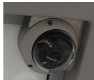
Figur 5 Overvåkingskamera på holdeplassene
