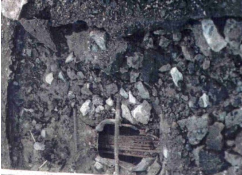
Figur 3.1 Bilde av frostsprengning av kabelkanal (oversiden) på Herøysund bru – fra 1992.
