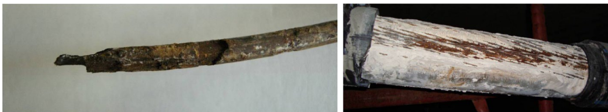
Figur 5.4 Korrosjonsangrep på kabeltråd etter 2 års drift. 24
