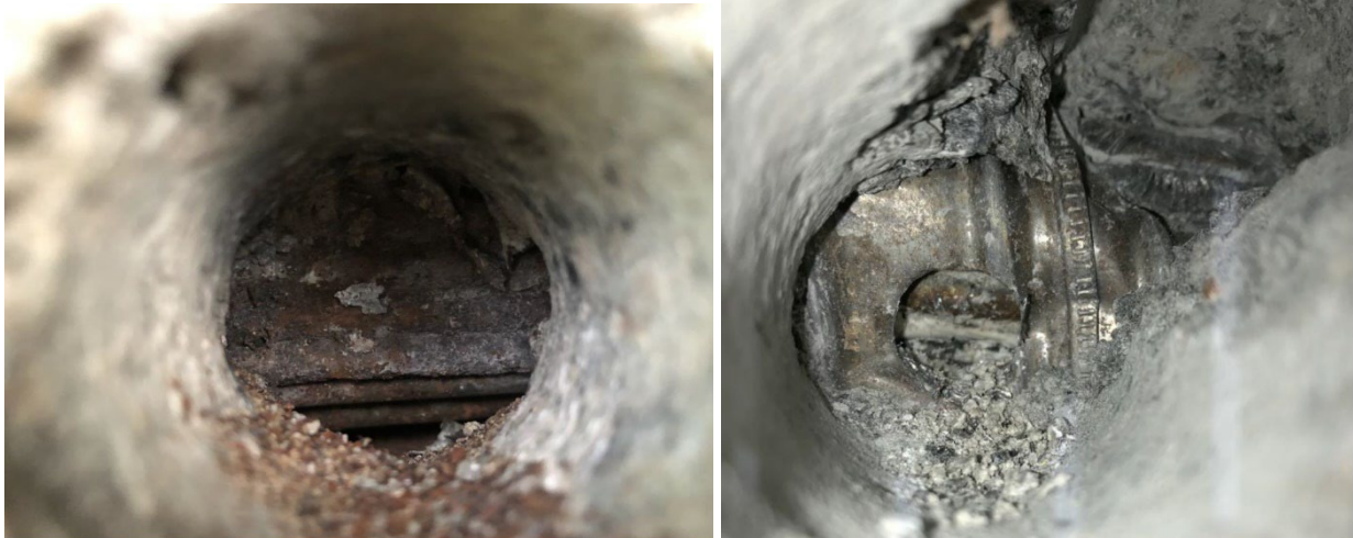
Figur 3.2 Kabelkanal og spenntråd – Venstre : Manglende injeksjonsmasse og korrosjon på kabelkanal og spenntråd. Høyre : Fylt med injeksjonsmasse, ingen synlig korrosjon på kabelkanal eller spenntråd. 5
