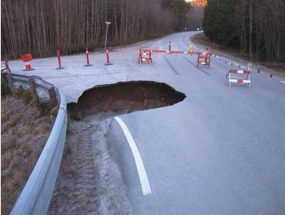
Figur 14.18 Utvasket vegbane etter punktering og endret artesisk trykk – Valebø, Telemark (foto: B.K. Dolva)
