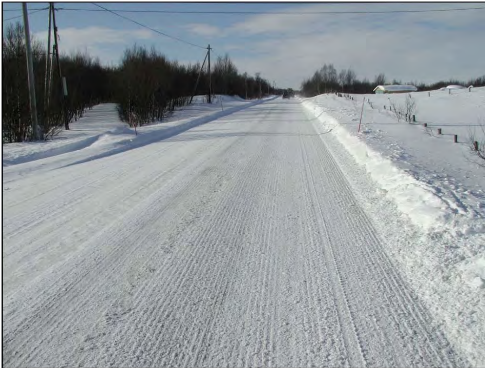
Figur 4-78 Snø- og isdekke etter høvling. Merk manglende utkast av ranke. Dette må gjøres for å hindre nedkjøring og dermed etablering av iskant på skulder. I tillegg bidrar manglende utkast til smalere veg.
