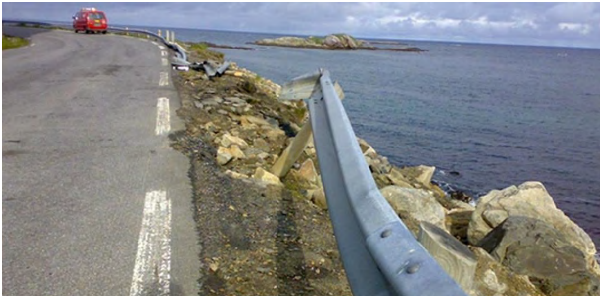
Figur 9-26 Skade på rekkverk (Foto: Statens vegvesen)
