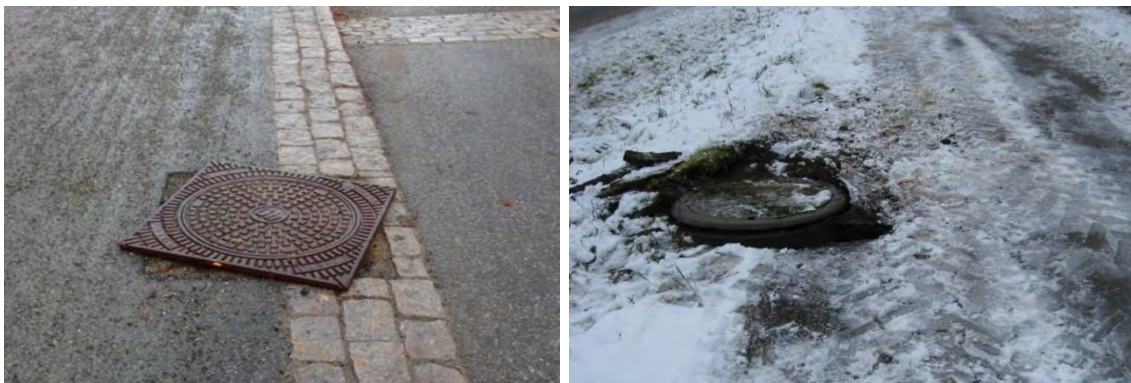
Figur 4-4 Kumlokkramme ute av stilling (t.v.), kum med overhøyde (t.h.). Fare for hekking. (Foto: Øystein Larsen)
