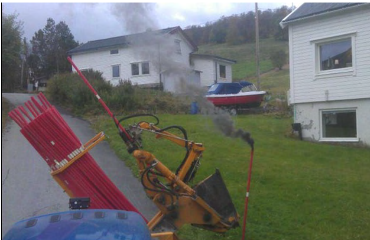
Figur 9-15 Stikksetter treffer høyspentkabel (Foto: Harstad Kommune)
