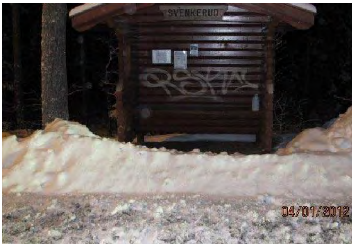
Figur 4-74 Mangelfull rydding foran leskur (Foto: Kjetil A. Bø, Statens vegvesen)
