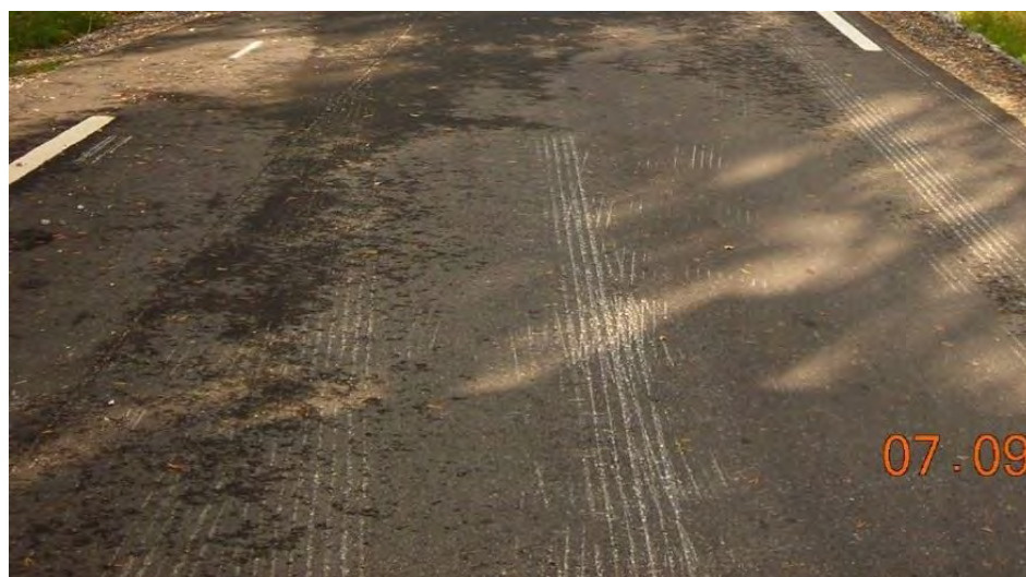
Figur 4-44 Skader på fast dekke (Foto: Statens vegvesen)
