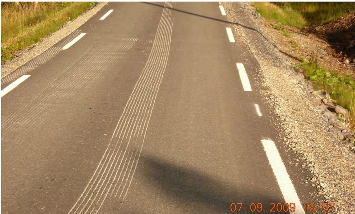
Figur 1-2 Skade på veg skal unngås
