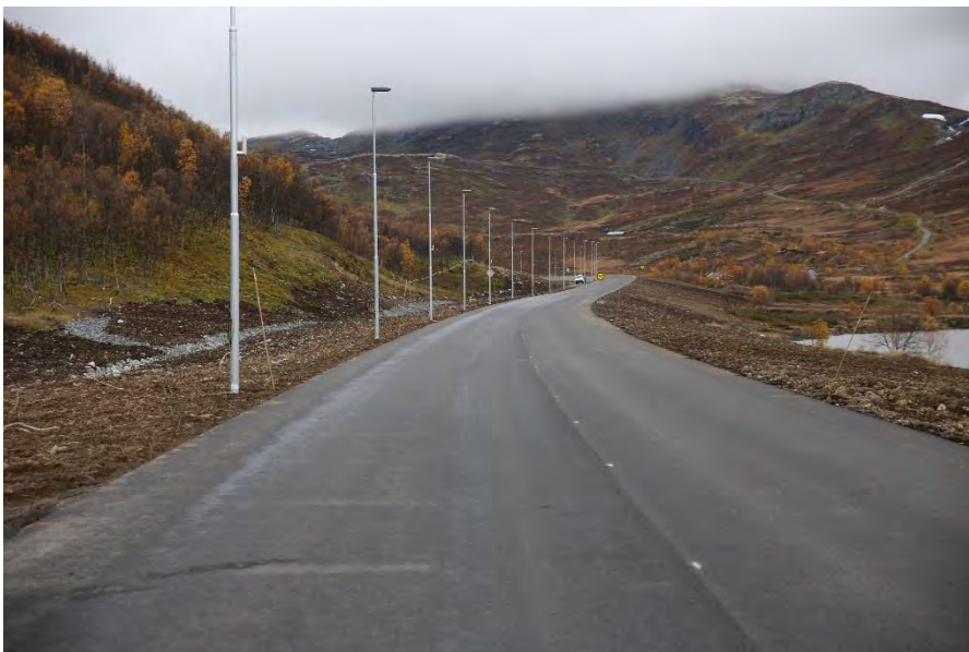
Figur 4-103 Vegbelysning på E16 Filefjell (Foto: Åsmund Espe, Statens vegvesen)
