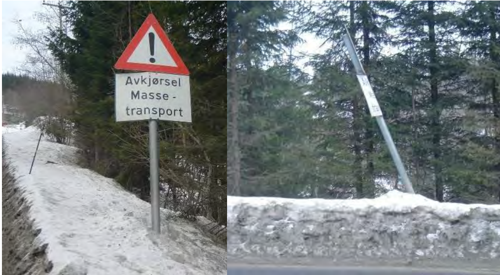
Figur 9-25 Skade på skilt (Foto: Statens vegvesen)
