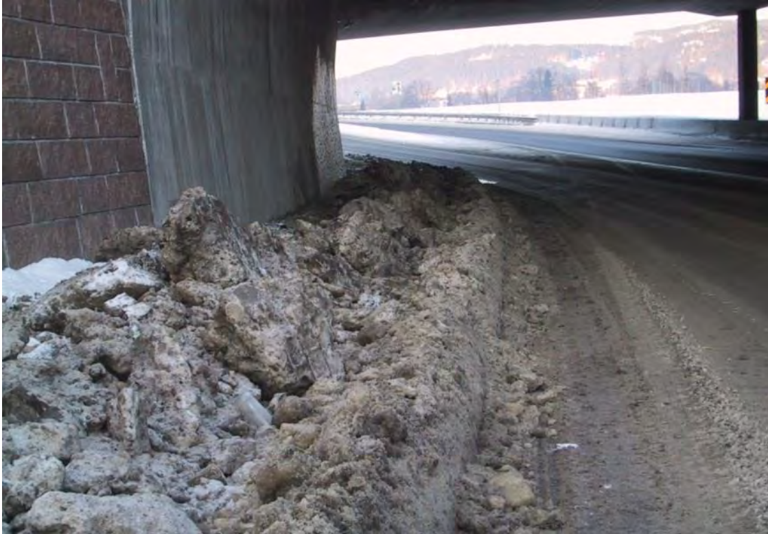
Figur 2-43 Ubrøytet fortau i undergang (Foto: Statens vegvesen)
