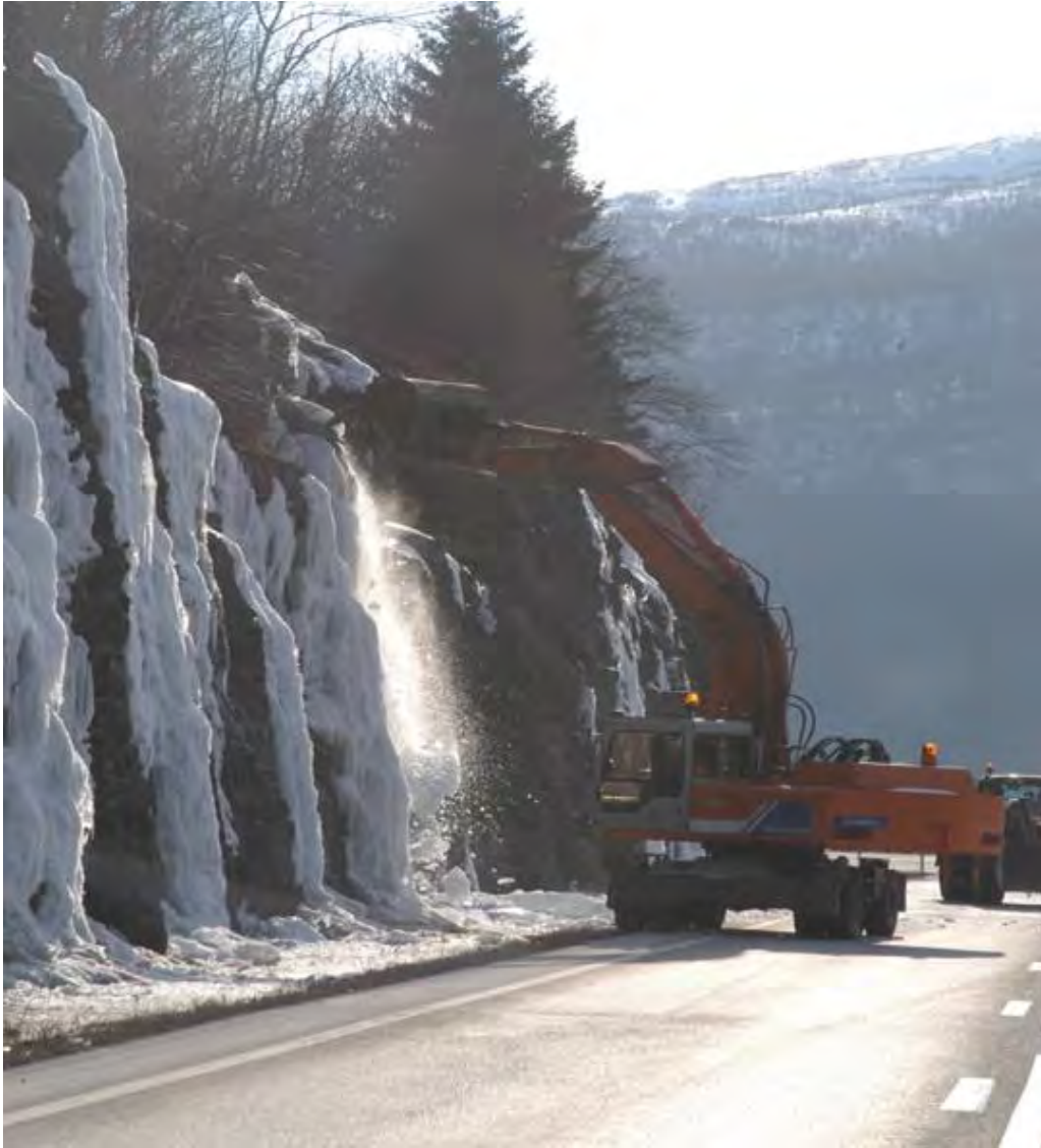
Figur 9-6 Rensk av is i skjæring (Foto Statens vegvesen)
