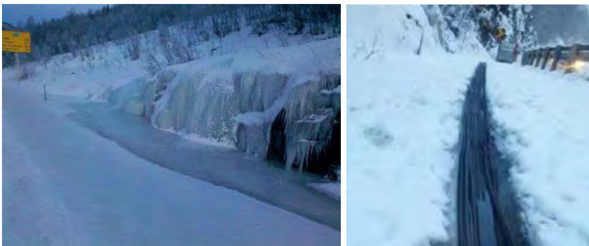
Figur 9-35 Problemer med is i grøfter og bruk av slanger for tining (Foto: Håkon Svendsen og Karl Olav Dahlberg, Mesta)
