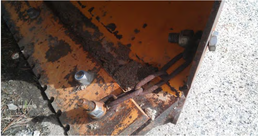
Figur 4-90 Sikring av vegstål (Foto: Kjetil Bø, Statens vegvesen)
