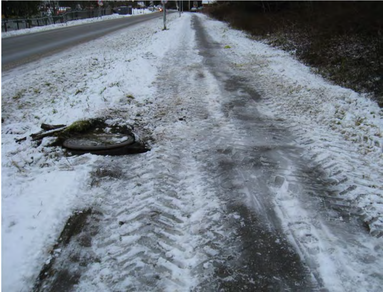
Figur 9-27 Skade på kummer/sluk (Foto: Øystein Larsen)
