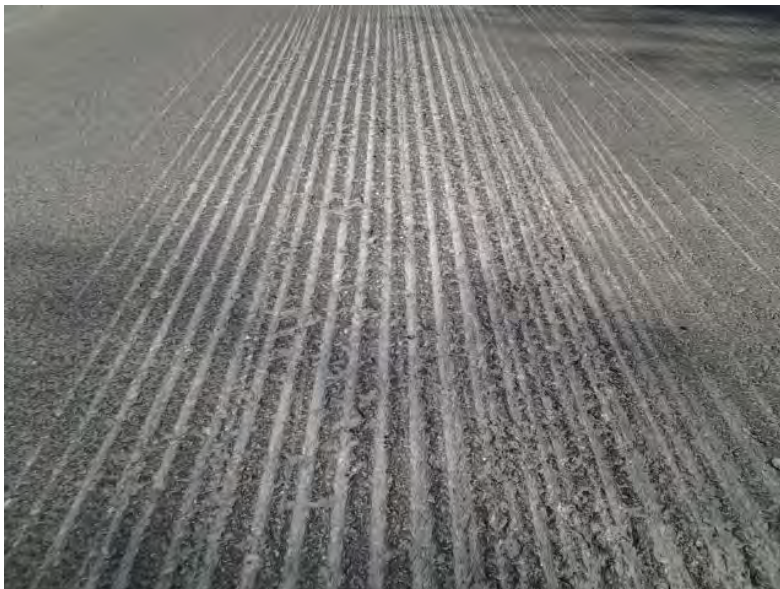
Figur 4-81 Dekkeskade grunnet uforsiktig høvling (Foto: Håkon Svendsen)
