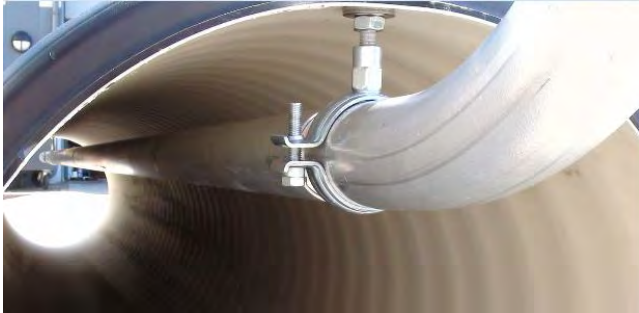
Figur 9-33 HeatWork. Tinerør montert inni stikkrenne (Foto: HeatWork)
