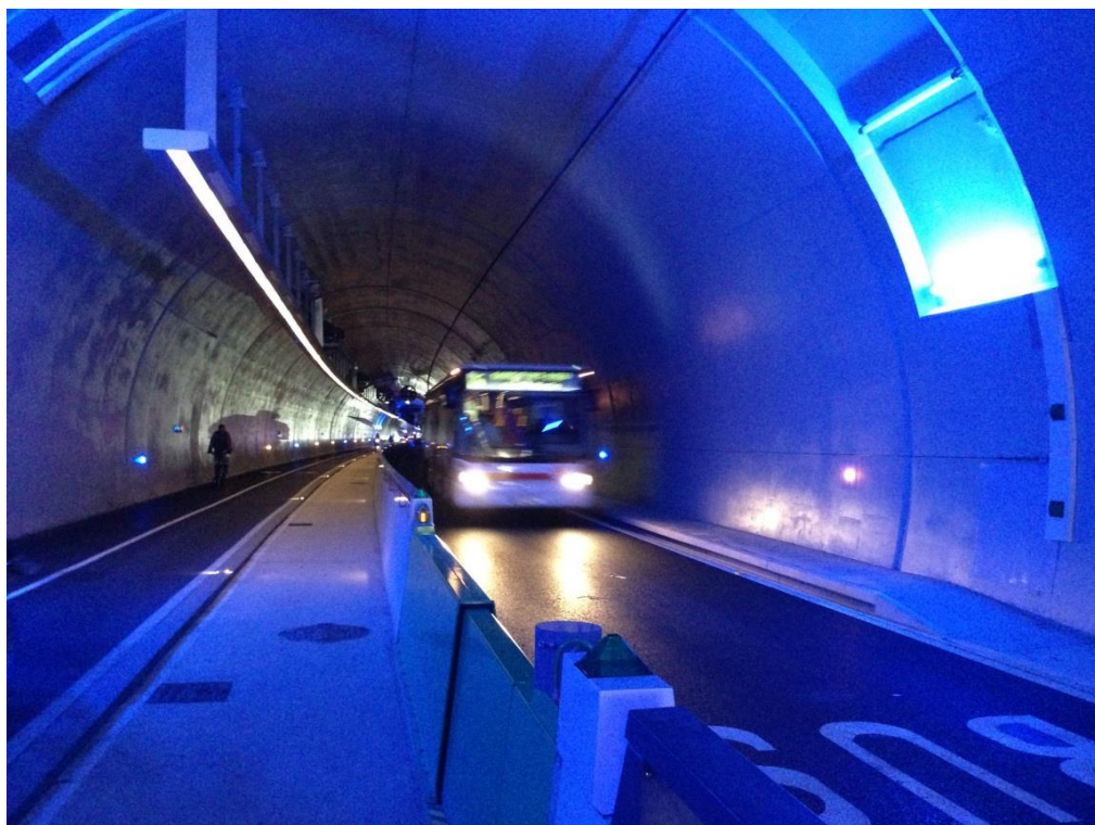
Figur 18: Midtrekkverk med hydraulisk slusesystem for evakuering.
