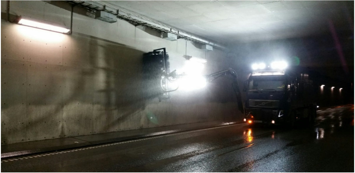
Figur 33: Vaskearm foran med tunnelvaskeborste (Uniarm 700) (Foto: Terje Engstrøm)
