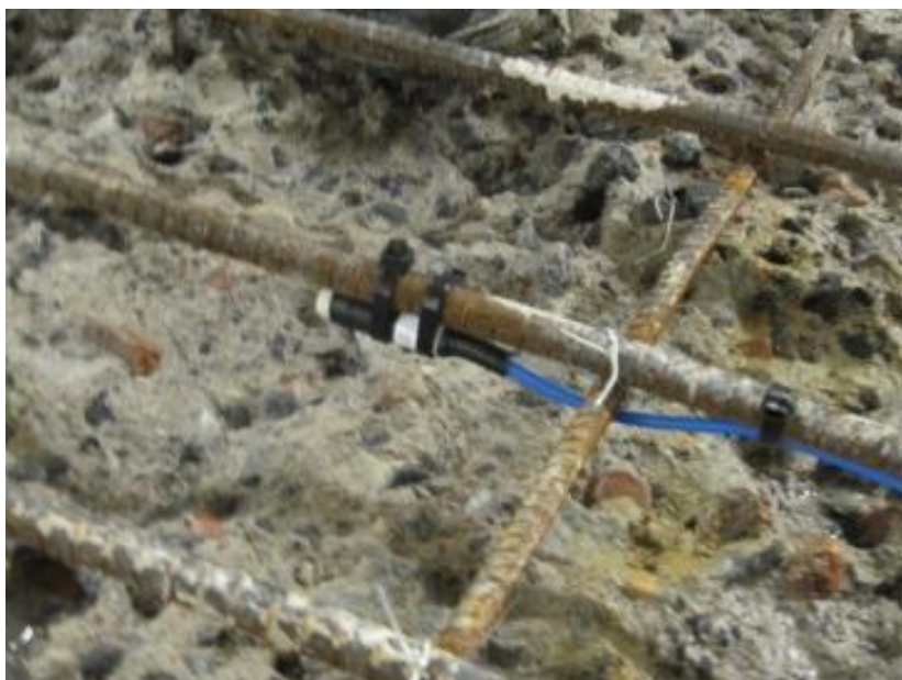
Figur 63B. Monterad referenselektrod av \text{MnO}_2 före ingjutning. Referenselektroden används för bestämning av det katodiska skyddets skyddsförmåga.
