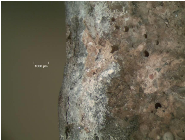
Figur 20B. Tvärsnitt av korroderat zinksikt där zinkjoner transporterats in i betongen ca 3 mm.
