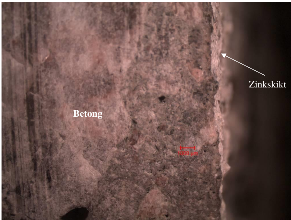
Figur 31B. Tvärsnitt av betongkärna 2A (vid vattenyta) med zinkskikt. Zinkskiktet har omvandlats till vitrost.
