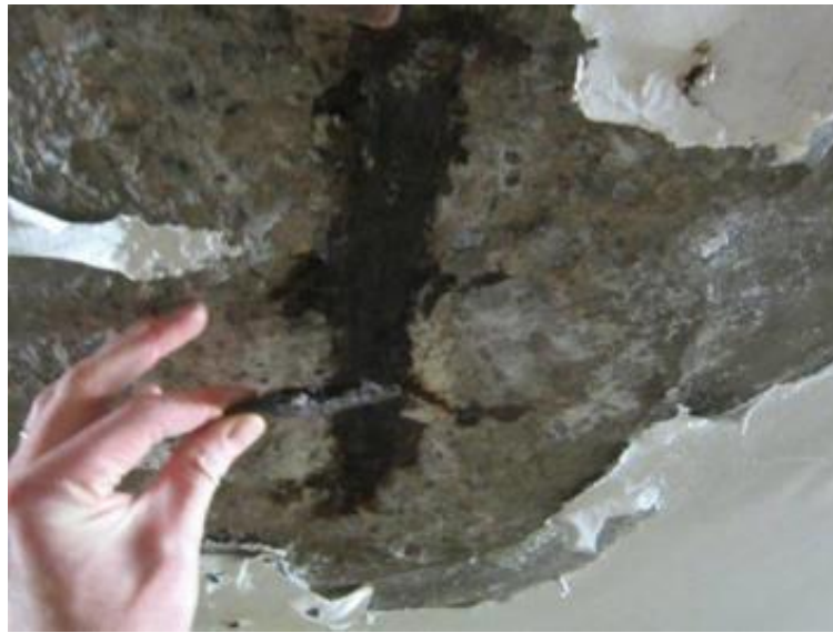
Figur 61B. Delaminerad betong p g a armeringskorrosion i betonggolv
