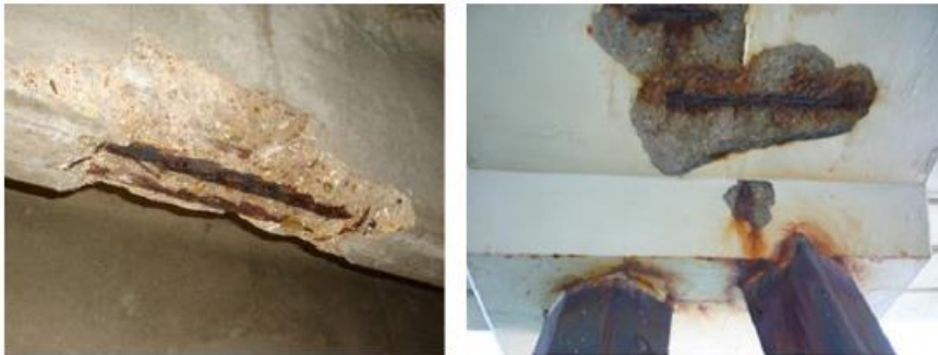
Figur 18. Korrosionsskada på parkeringsdäcket till vänster och den mindre bron till höger. Skadorna var orsakade av höga kloridhalter i betongen.
