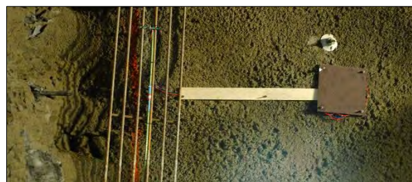
Figur 1.4.11-2: Såkalte «søsterjern» og «bikkjebein» i sprøytebetongbue i Lørentunnelen
