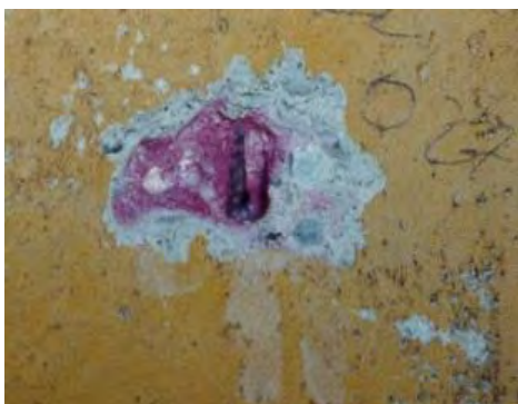
Figur 3.4.3-2: Opphugging og påføring av indikatorvæske (her fenolftalein)
