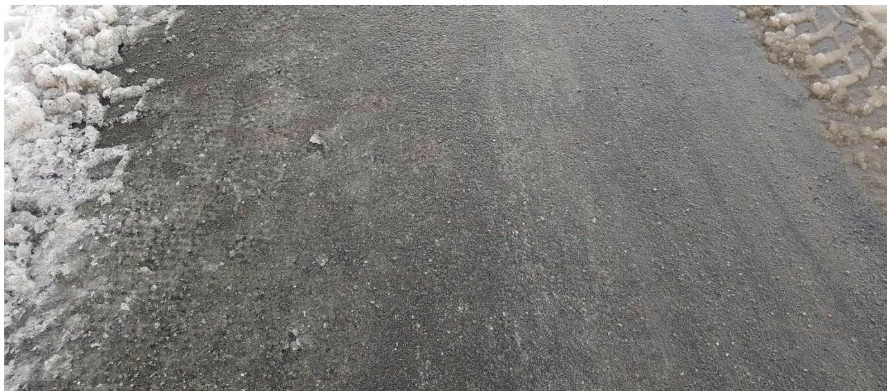
Figur 17: GsB Jonsvannsveien observasjon 2.
