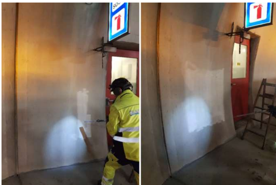
Figur 10 Effekten av tørris i tunnelvegg (betong).
