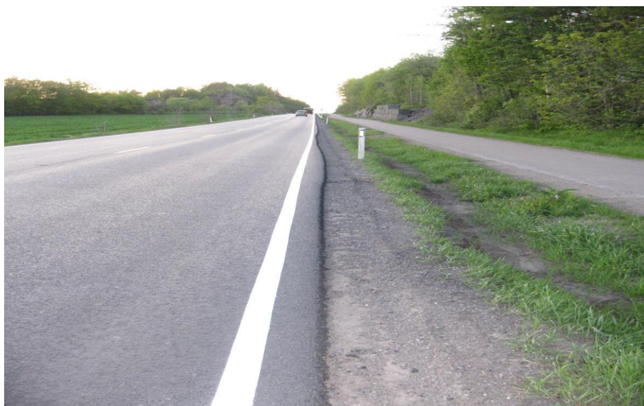
Figur 7: Feil utført ytterkant
