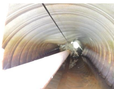
Figur 4. IGS-rør henger sentralt i stikkrenna. En liten skade på stikkrennerøret. Foto KM Reitan
