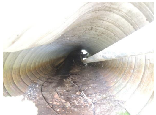
Figur 3. Stikkrenna er sammenklemt. Foto: KM Reitan
