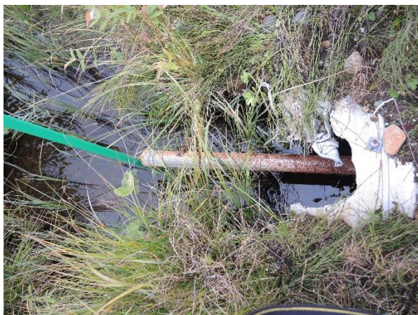
Figur 2. Utstikk, Renne ødelagt av gravemaskin under graving av is. IGS-rør med overflaterust etter første vinter . Foto KM Reitan
