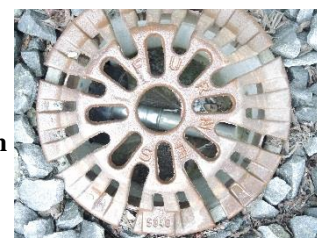
Figur 4. IGS-røret går ubrutt gjennom kummene. Foto: KM Reitan
