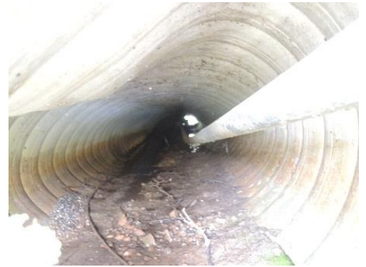
Figur 2. Sammenklemt stikkrenne. Foto KM Reitan
