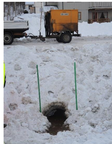
Figur 2 Eksempel på merking av stikkrenne. Foto: Knut Magne Reitan, Siving. Reitan AS
