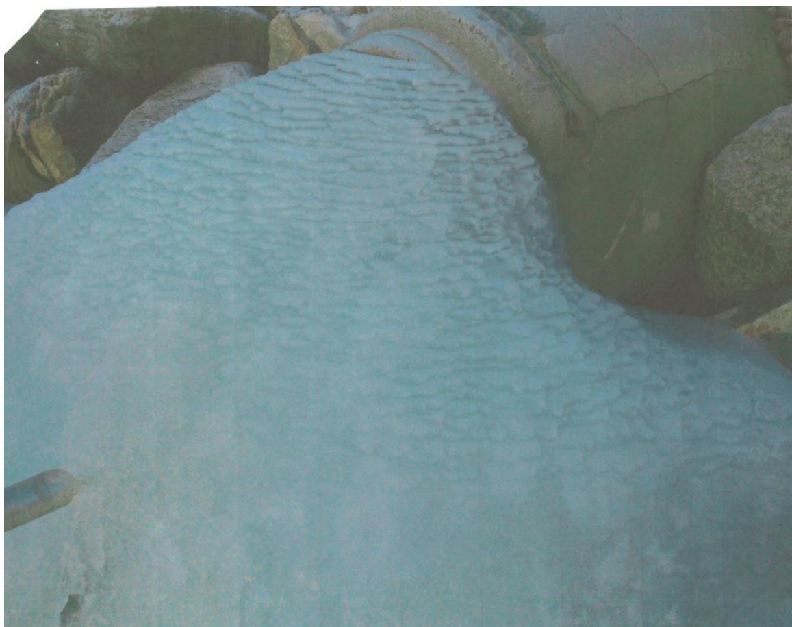
Figur 1 Tett stikkrenne. Foto: Lars-Olaf Bratland, Mesta
