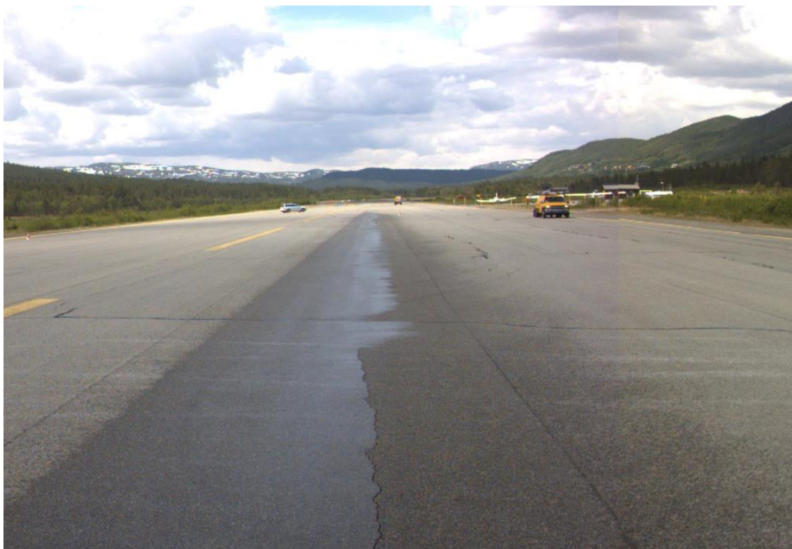
Figur 5: Dagali flyplass etter friksjonsmåling med vannfilm.
