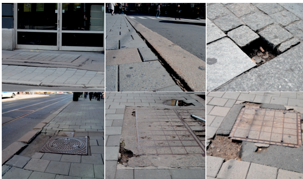
Figur 6.26. Eksempler på manglende vedlikehold av dekke (Foto: M. Sørensen).
