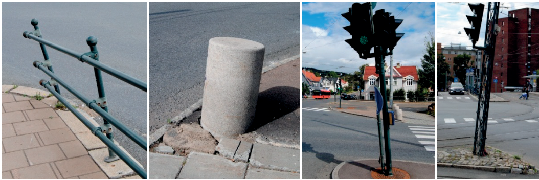
Figur 6.6. Ulike gateutstyr som er ødelagt og skjev trolig som følge av at det er blitt påkjørt eller som følge av snøbrøyting (Foto: M. Sørensen).
