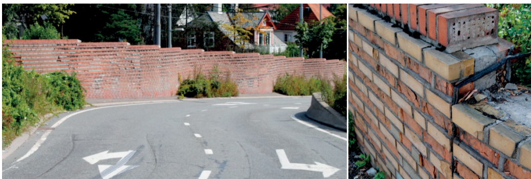
Figur 6.8. Falleferdig støyskjern ved rampe fra Rings 3 (Foto: M. Sørensen).
