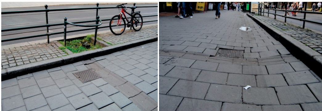
Figur 6.29. Anlegg for drenering på fortau (Foto: M. Sørensen).
