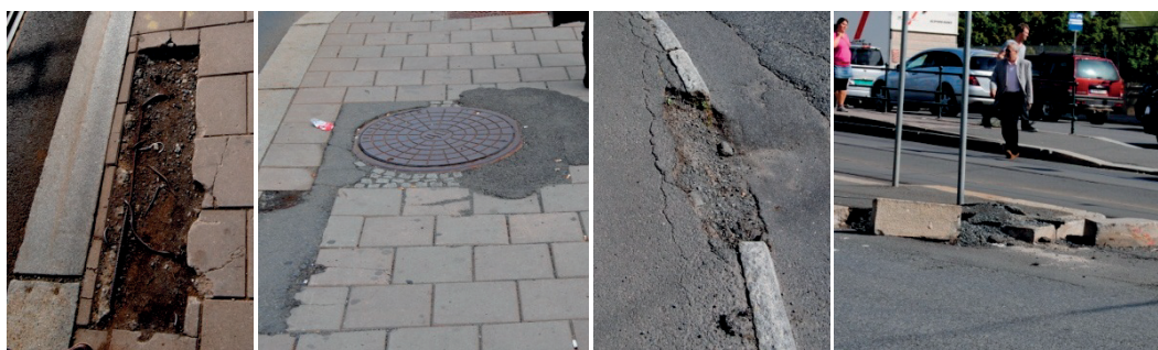
Figur 6.4. Ødelagt og reparert dekke, kantstein og trafikkøyer (Foto: M. Sørensen).
