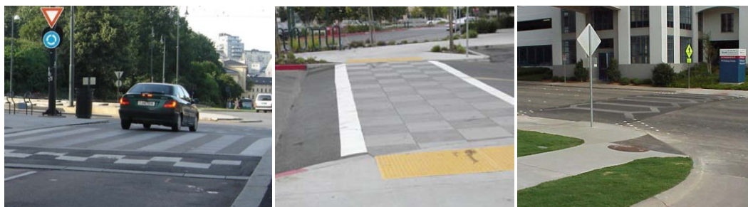
Figur 14. Eksempel på opphøyd gangfelt i Oslo (Foto: M. Mosslemi), i Canada (MTC, 2010b), og i USA (PBIC, 2010).
