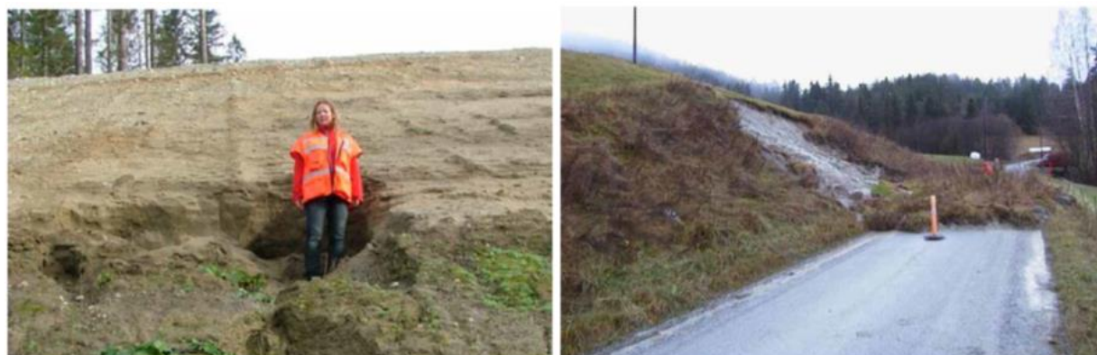
Figur 3.33 Eksempel på grunnvannserosjon (t.v.) og overflateglidning (t.h.) /4/ (Foto: Thorbjørn Hansen, Bjørn Dolva)
