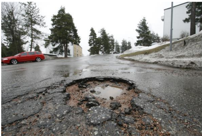
Figur 6.44 Slaghull i asfaltdekker er ikke noe uvanlig syn /3/
