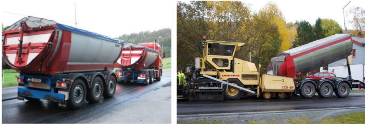
Figur 6.84 Baljebiler bør brukes ved transport av asfalt (Foto: Statens vegvesen)
