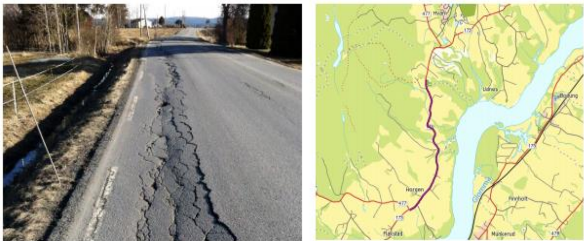
Figur 11.35 Kantskader på fv. 173 i Akershus (t.v.) /2/
