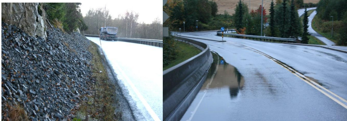
Figur 11.16 Kult helt inn til vegkanten gir en grøft med liten hydraulisk kapasitet og for liten plass for snø (t.v.). Vanddam dannes pga. for små drenshull i betongmuren (t.h.). (Foto: Statens vegvesen)
