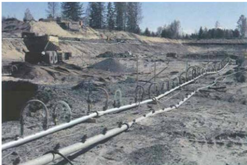
Figur 3.23 Anlegg for grunnvannssenking /4/
