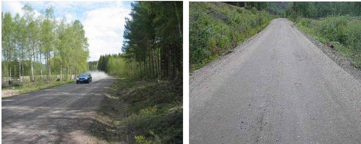
Figur 7.4 Støvskyer kan redusere sikten kraftig på grusveger, også omgivelsene er ofte plaget av støv (t.v.)/1/. Lignin-stabilisert veg i Flå kommune (t.h.) (Foto: Statens vegvesen).
