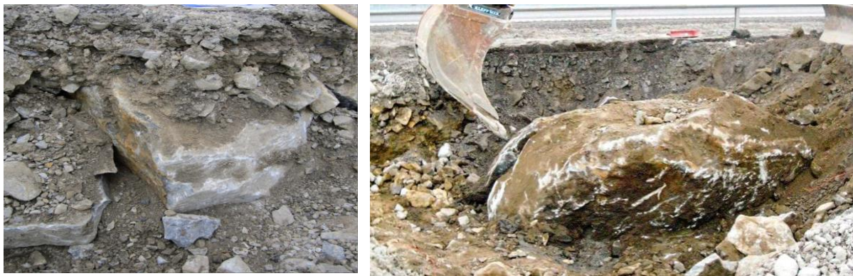
Figur 9.21 Inhomogenitet i forsterkningslag som har medført telehivsproblem (Foto: Statens vegvesen)
