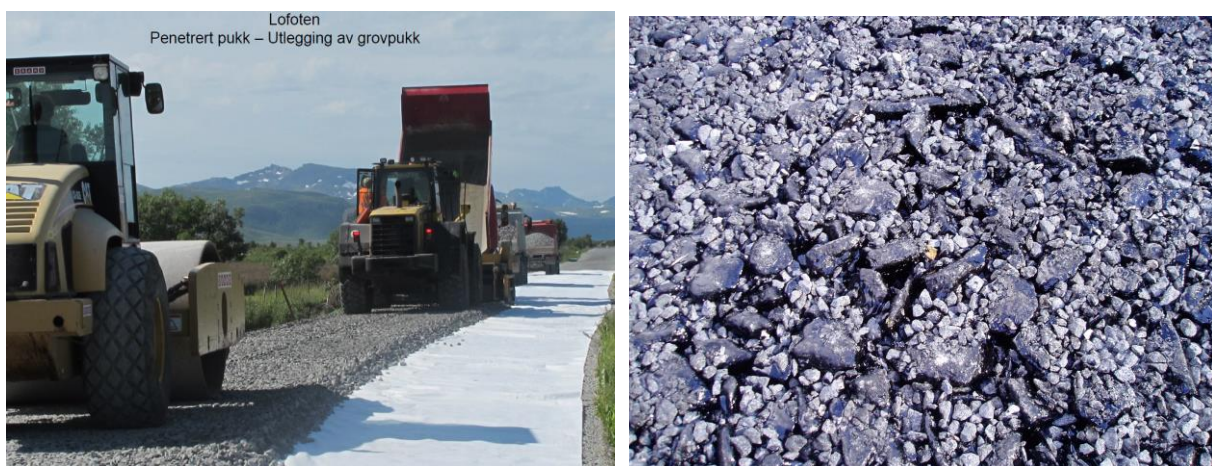
Figur 11.20 Utlegging av grovpukk med utlegger (t.v.), med nærbilde av forkiling og penetrering (t.h.). (Foto: Kai Frode Solbakk)
