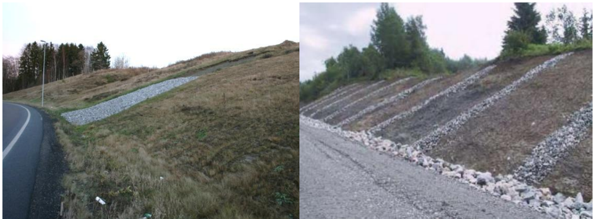
Figur 11.17 Før vegetasjonen er godt etablert er vegskråninger særlig utsatt for erosjon og utglidning (t.v.). Lukket drenering og pukkestrenger etablert som erosjonssikring i skråningen (t.h.). (Foto: Statens vegvesen)
