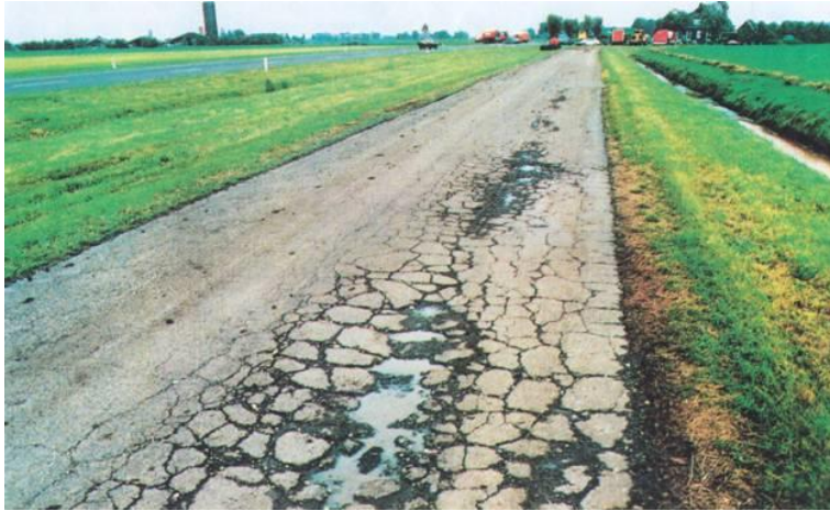
Figur 6.42 Gammelt, krakelert dekke med dårlig bærelag under /3/
