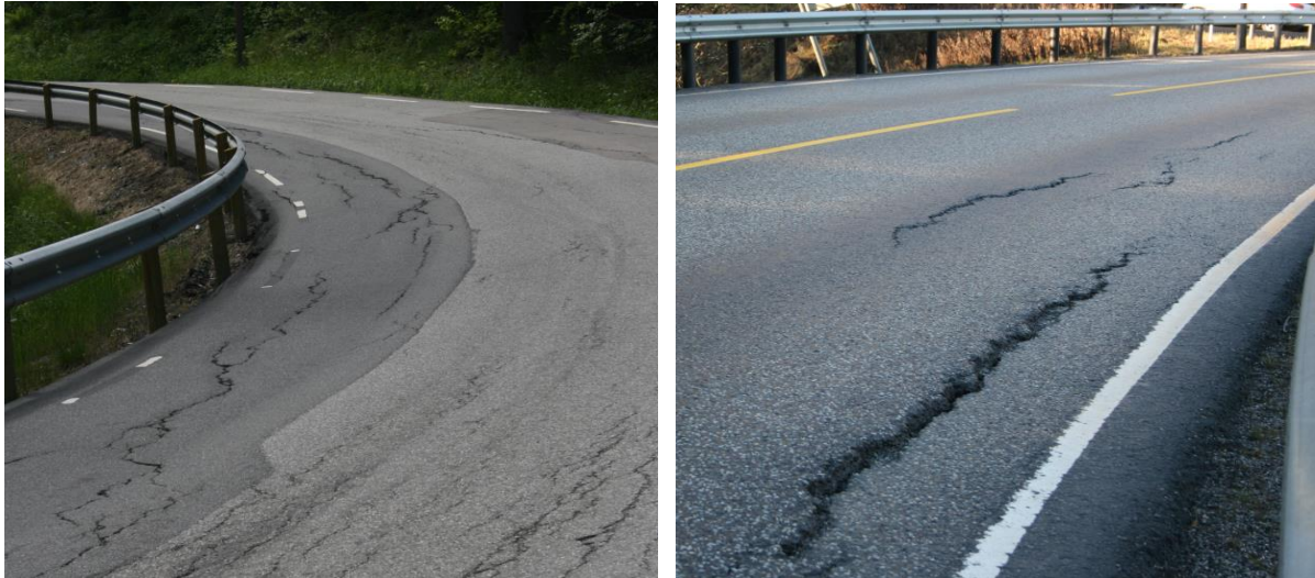
Figur 11.23 Refleksjonssprekker i flatelapping mens asfalten ennå er svart (t.v.). Langsgående sprekker med høydeforskjell er trafikksfarlige (t.h.) (Foto: Statens vegvesen)
