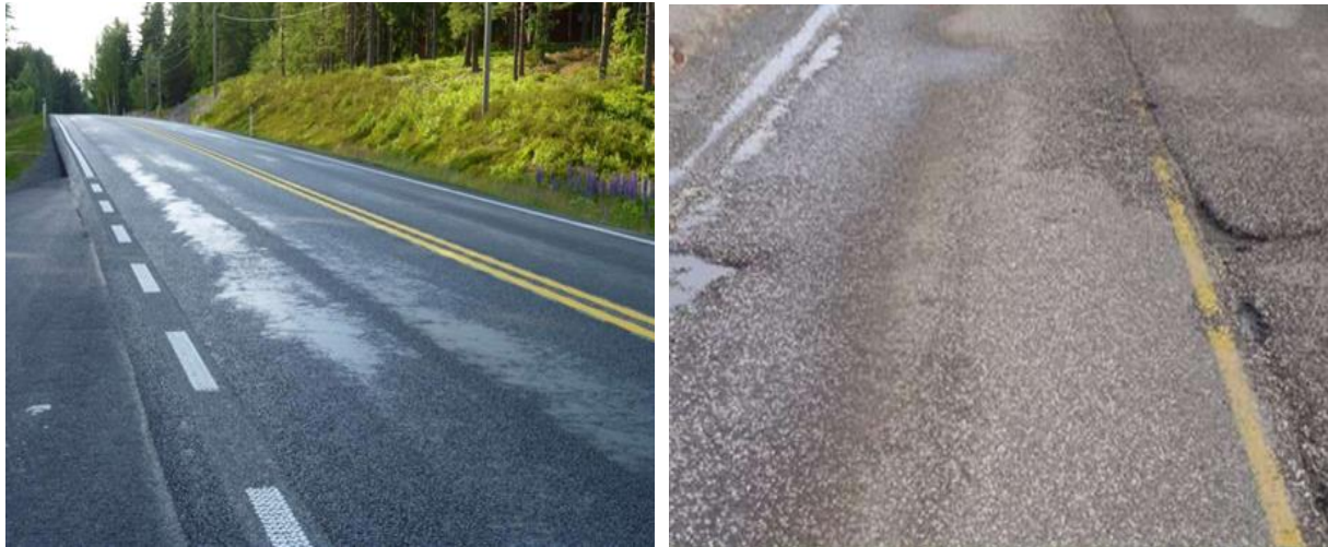
Figur 6.29 For høyt bindemiddelinhold kan føre til blødning (t.v.) og for lavt bindemiddelinhold til steinlipp (t.h.) (Foto: Veiteknisk Institutt)
