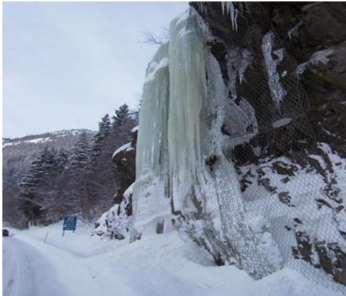
Figur 11.31 Iskjøving i fjellskjæring med monterte issikringsnett (Foto: Audun Langelid)
