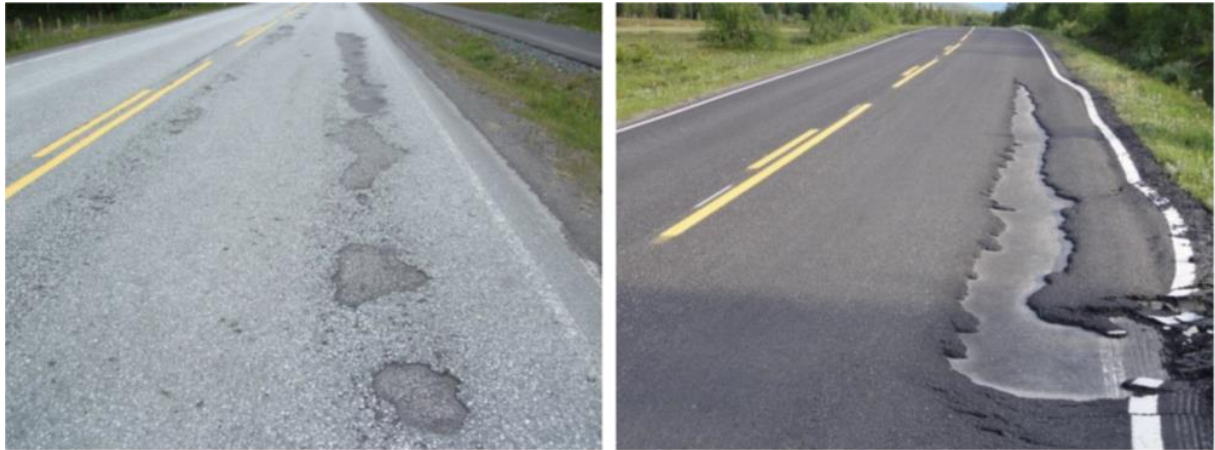
Figur 6.88 Resultat av dårlig klebing; slipp av masse i hjulspor og/eller glidning mellom asfaltlagene (Foto: Statens vegvesen)
