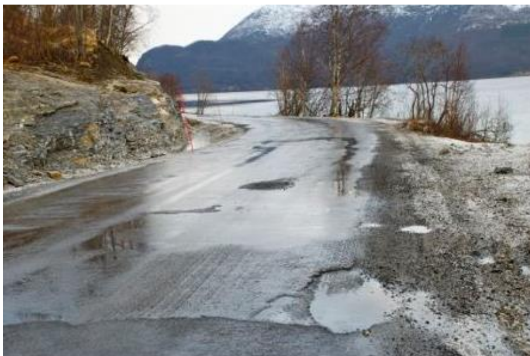
Figur 11.4 Et dårlig vegdekke er ikke ensbetydende med at vegen trenger forsterkning (Foto: Statens vegvesen)
