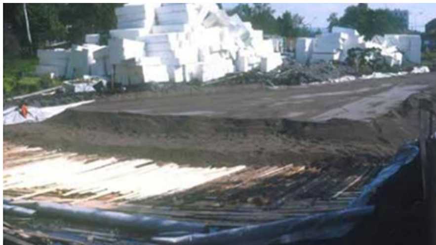
Figur 4.41 Bruk av bakhun som armering i fylling på E18 Fornebukrysset /3/ (Foto: Roald Aabøe)
