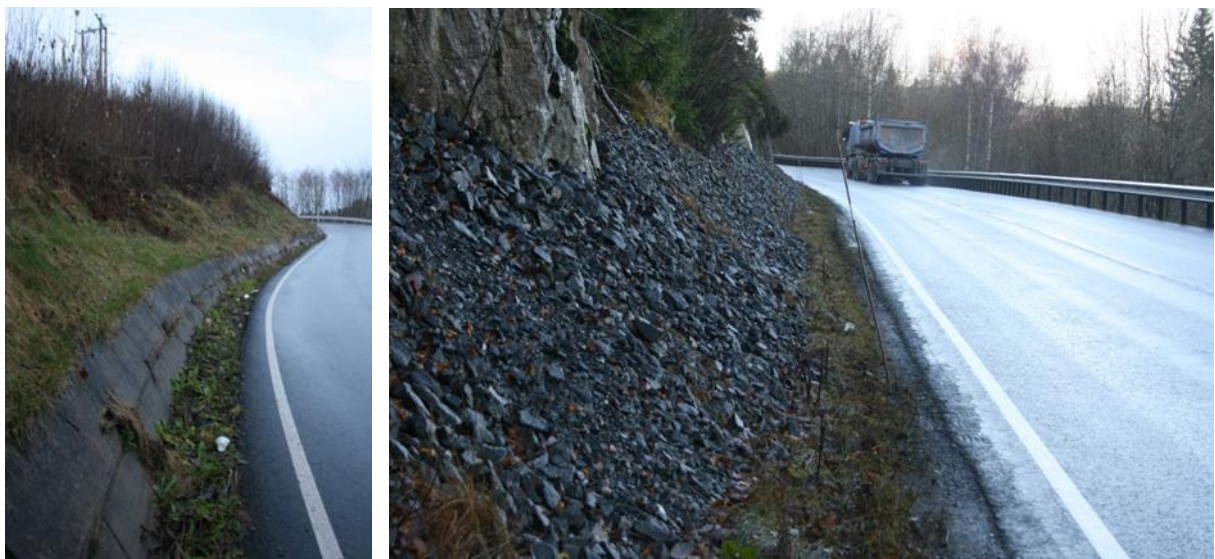
Figur 11.8 To eksempler på veger hvor tilfredsstillende håndtering av overvannet er en utfordring /2/
