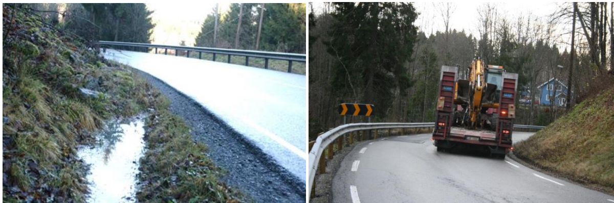
Figur 11.15 Behov for punktvis utbedring av grøft og grøfteskråning (t.v.). Smal veg, manglende grøft og tunge kjøretøy gir rask nedbrytning av vegen (t.h.)
