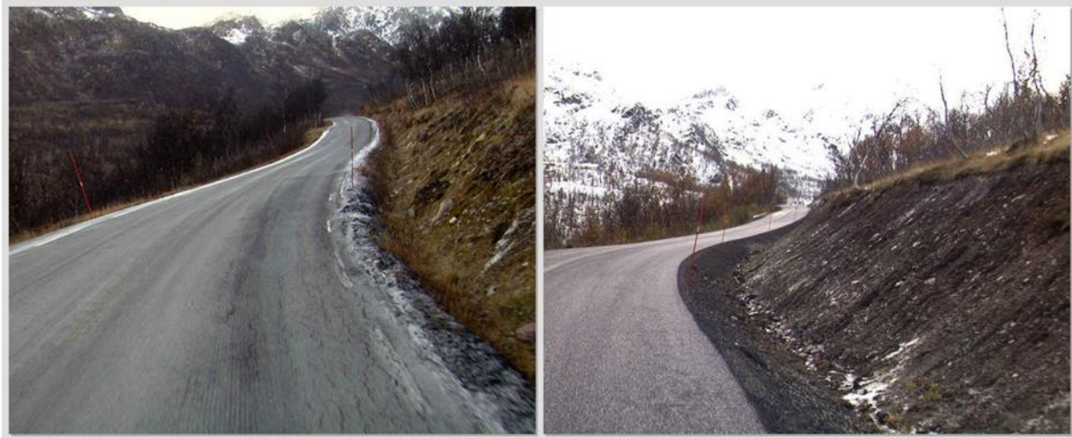
Figur 10.7 Kjørefelt/hjulspor nærmest skjæringssiden vil ofte ha mer telehiv og/eller flere dekkeskader (krakelering mv) enn den delen av vegen som ligger mot fyllingssiden. Grunnvannstanden senkes med åpen/dyp sidegrøft eller lukket drenggrøft. (Foto: Statens vegvesen)
