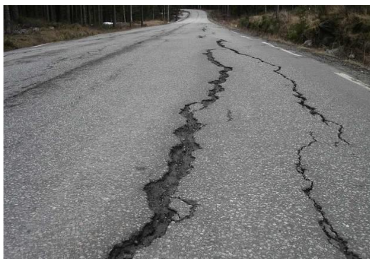
Figur 6.40 Langsgående telesprekker (Foto: Statens vegvesen)
