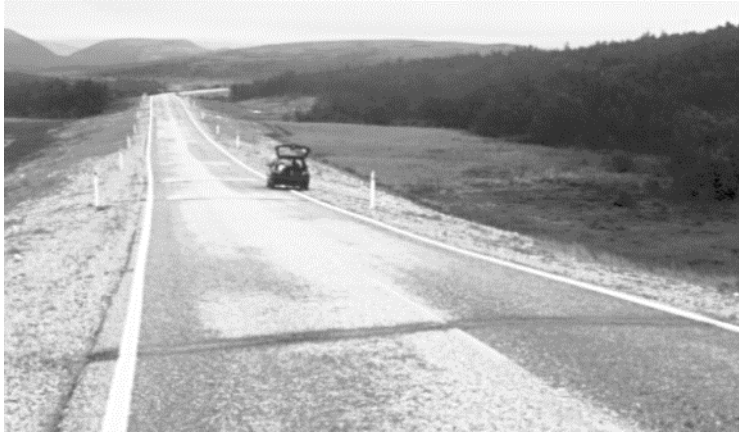
Figur 6.41 Tverrsprekker pga. lav vintertemperatur, Finnmark (Foto: Eivind Andersen)
