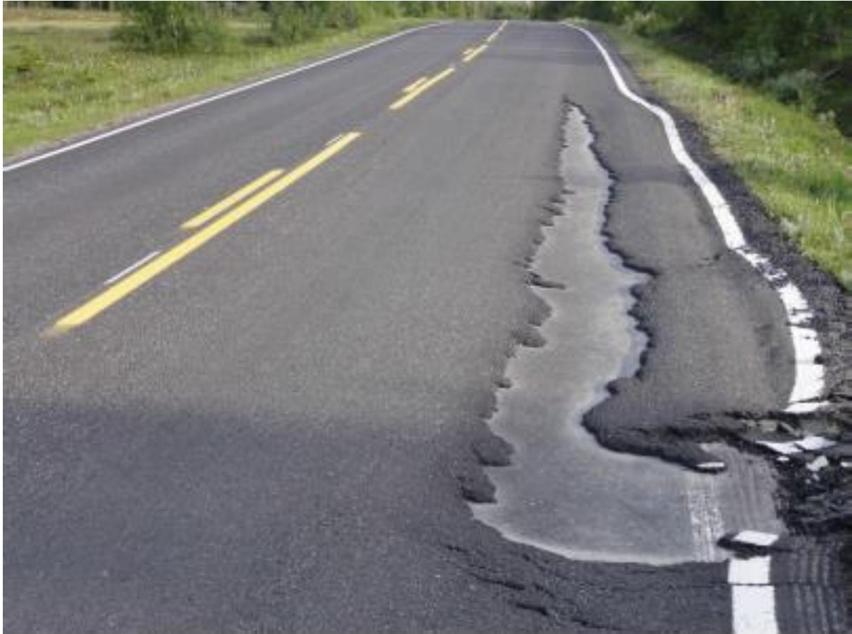
Figur 10 Mangelfull klebing fører til en rekke skader på asfaltdekkene
