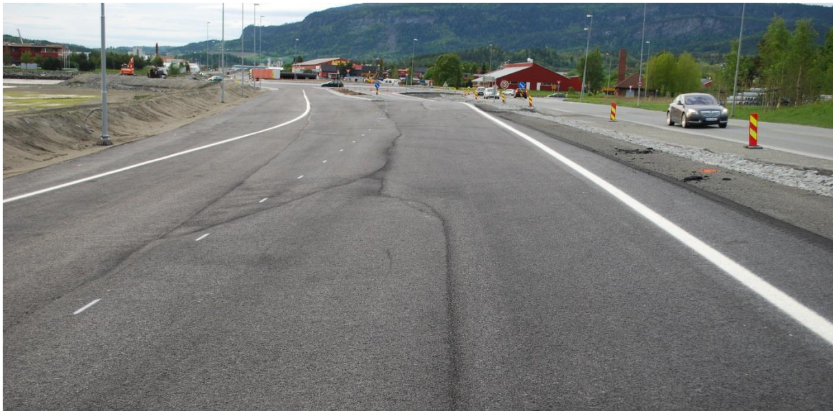
Figur 8 Dårlig planlegging og utførelse av asfaltdekker er den hyppigste årsaken til feil og mangler
