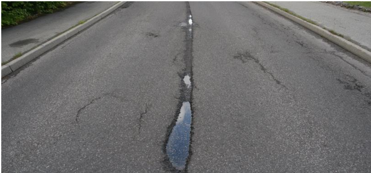
Figur 12 Eksempel på dårlig utført midtskjøt i kombinasjon med dårlig klebing (foto Roar Telle)
