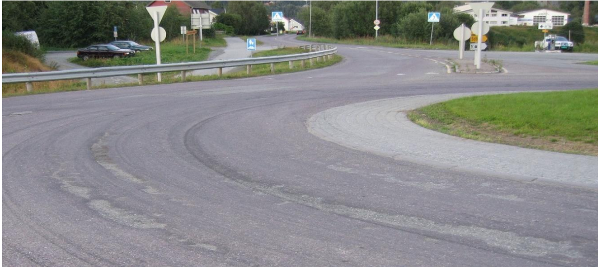
Figur 24 Eksempel på dekkeskade i rundkjøring. Bruk av PMB er et tiltak som kan benyttes for å redusere dette problemet (foto Leif Bakløkk)
