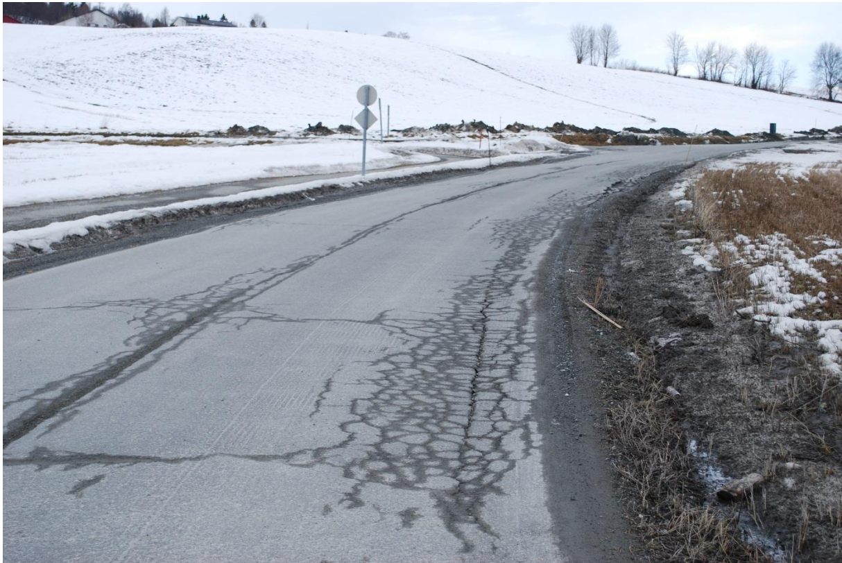
Figur 32 Skader på grunn av feil dimensjonert overbygning kommer ikke til syne før etter noen år (foto Leif Bakløkk)
