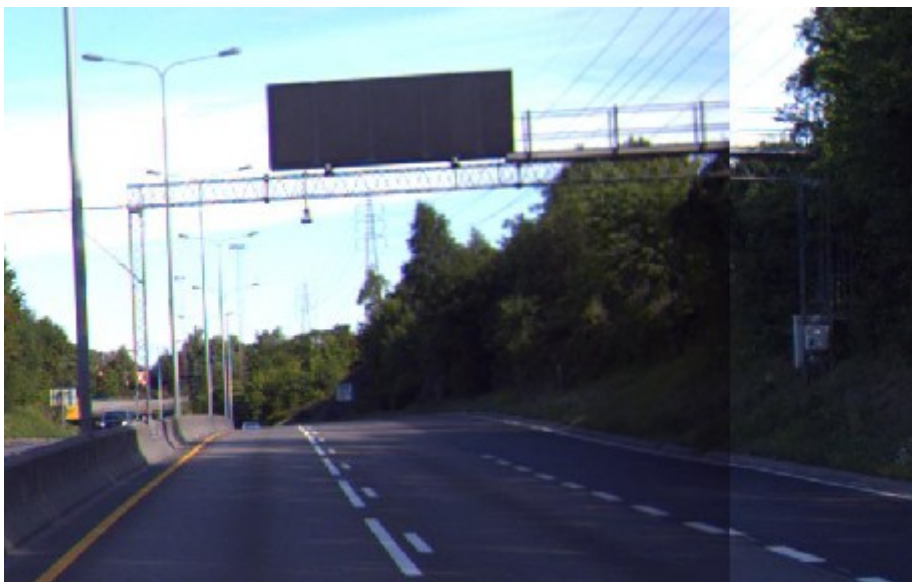
Figur 8 Reisetidsleser ved Teisen i nordgående retning. Trafikk i påkjøringsrampen til høyre detekteres ikke. Kilde: Vegbilder.
