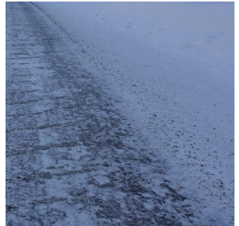
Figur 42: Strekning 1. Løse steiner havner etter hvert på skuldra. Bildet er tatt dag 2.
