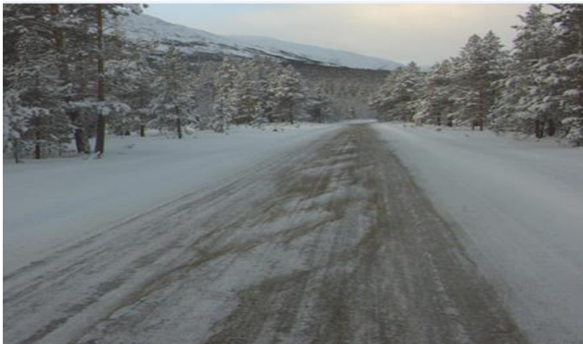
Figur 55: Strekning 8. Tørrsand Kårbøseter. Ujevn utlegging.
