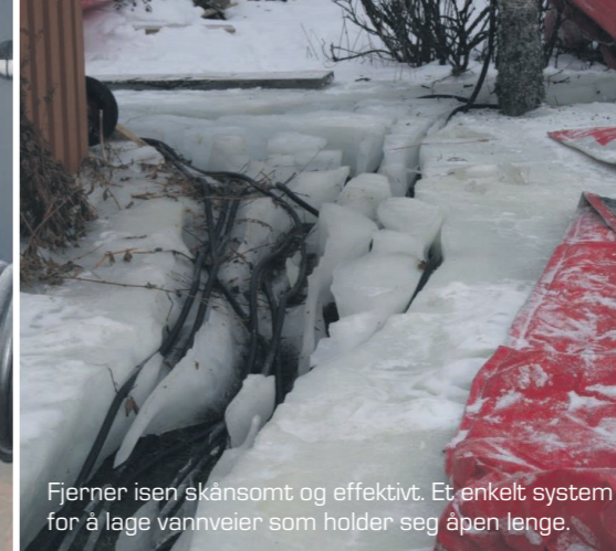
Vanntilførsel ved smoltanlegg frøs, HW leverer løsning som sikrer driften, og holder vanntilførsel åpen.
