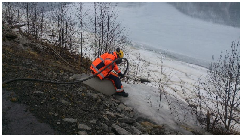
Figur 28. Glatt og risikofull adkomst til stikkrenneåpningen. Foto Lars Olaf Bratland, Mesta
