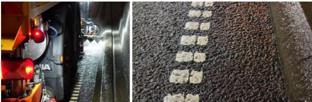
Figur 18: Drag 1, felt 2 og 3. Vasking med spylebom, koster og oppsug i Freifjordtunnelen (Foto: Dagfin Gryteselv)
