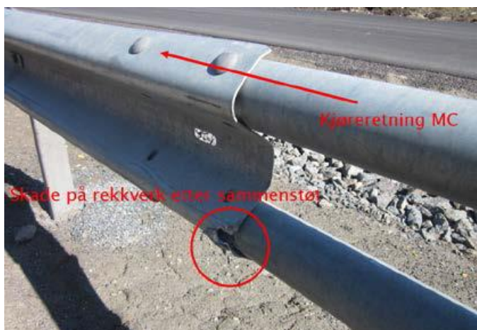
Bilde 1: Overgang mellom skinner på ettergivende rekkverksende.
