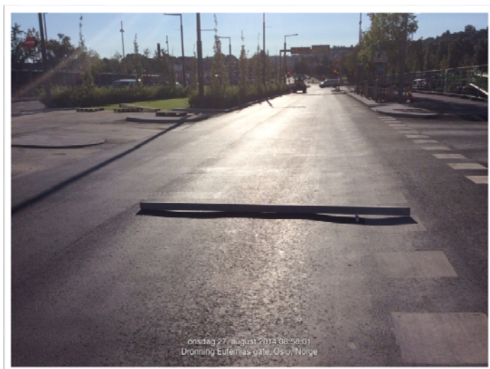
Figur 10-8 Hjulspor i asfalten etter en sommersesong skyldtes for mye finstoff i massen
