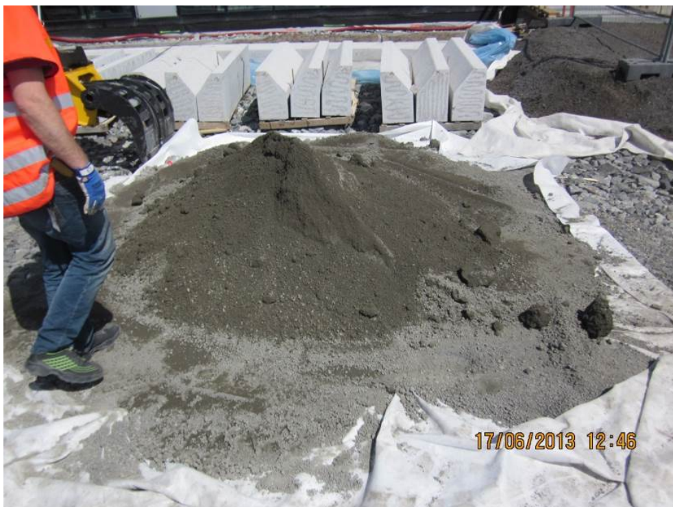
Figur 5-26 Jordfuktig mørtel som ikke er holdt tildekket i lagringsfasen, skal IKKE brukes!
