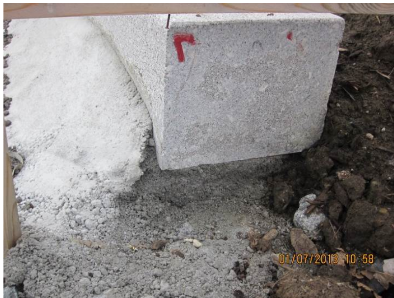
Figur 5-28 Tørr mørtel tilsatt vann og glattes ut. Den gode overflaten kamouflerer dårlig støp under.
