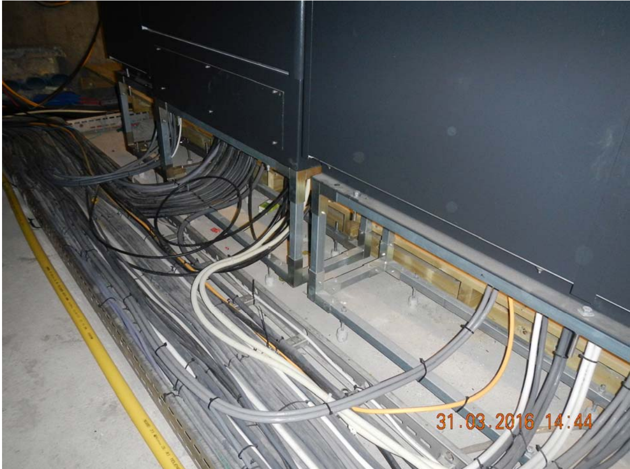
Figur 9-12 I teknisk rom under Nylandsveien bru ble elektroskapene montert på isolatorer slik at E-verksjord ble isolert fra jernbanejord.
