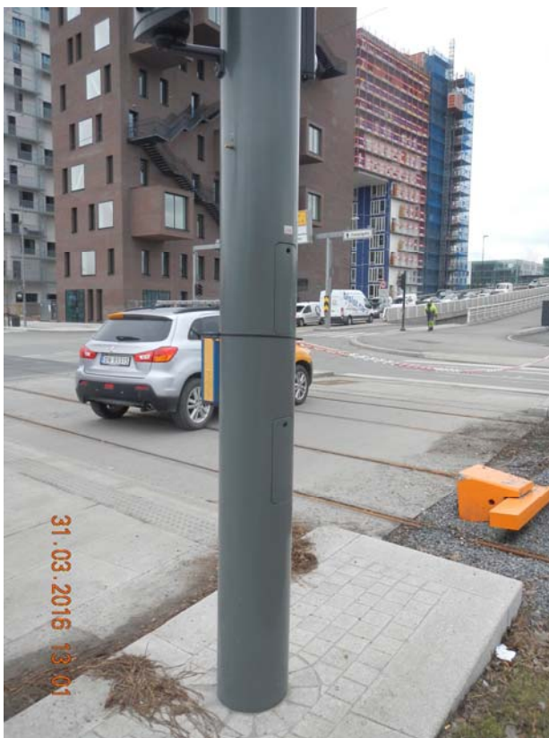
Figur 9-6 Koblingsluke til trafikklis og KL-mast
