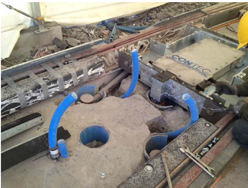
Figur 13-3 Tilpasninger i trikkeplata på plassen på grunn av manglende tverrfaglig kontroll under prosjektering.
