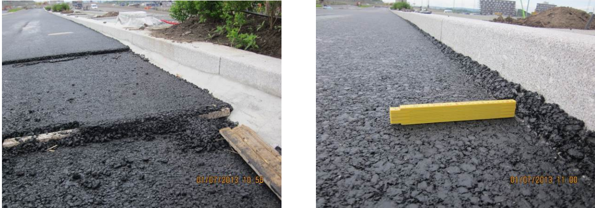
Figur 5-16 For mye forstøp i forhold tilsluttende asfalt
