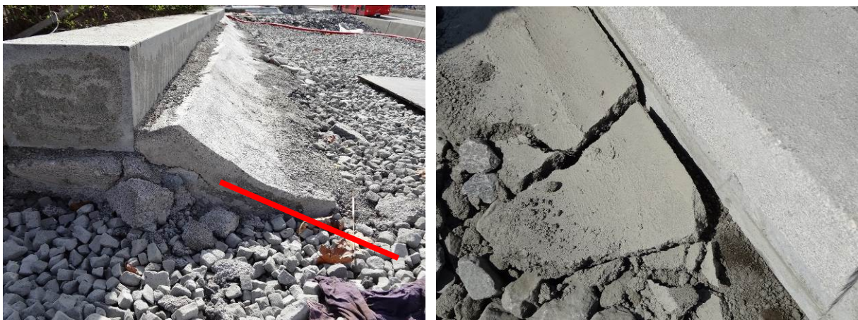
Figur 5-29 Det skal aldri legges fersk mørtel på dårlig støp. Da kan resultatet bli som dette.
