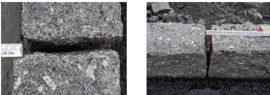
Figur 5-13 Avvik i dimensjonstoleranser på kantstein råhogde flater gir ujevn linjeføring, sprang mellom stein og kilefuger.
