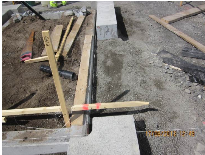
Figur 5-27 Manglende tildekning under utførelse med pause i arbeidene (lunsj?), mørtelen må fjernes!
