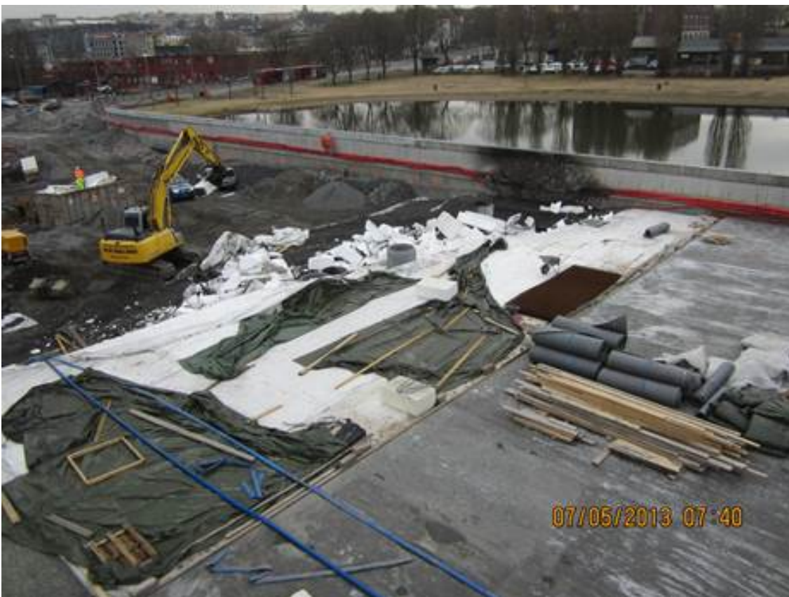
Figur 10-4 Brann i isoporfylling på tent av ulovlig bruk av nødbluss. Isoporen smeltet bort i flammene. Nederste bildet viser opprydding etter brannen og soten på betongmuren.
