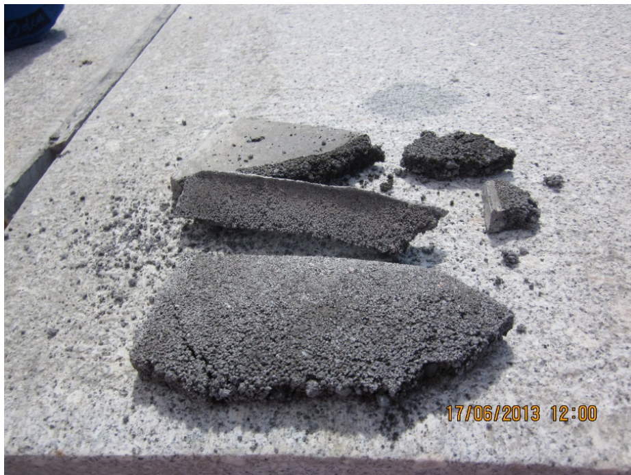
Figur 5-23 Dårlig selvblandet fugemørtel
