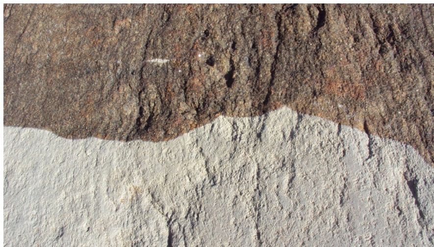
Figur 19. Det kvite aluminiumsbelegget blei effektivt fjerna ved trykkspyling (Foto: Per Hagelia).
