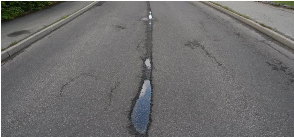
Figur 10 Eksempel på dårlig utført midtskjøt som rakner
