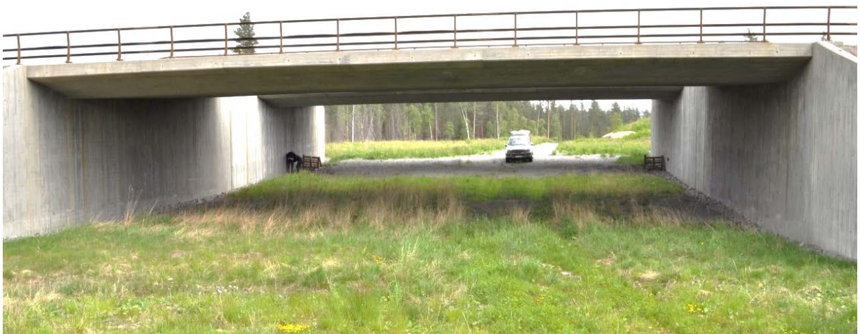
Figur 2.2.3. Europaller plassert nær monterte viltkamera ved undergangen « Sørli » langs E6 i Stange kommune. Dette presser mindre vilt ut fra veggene i undergangen og muliggjør at alt vilt registreres på kamera. Kameraene er her plassert ca. 1 meter over bakken. Foto: Ole Roer.
