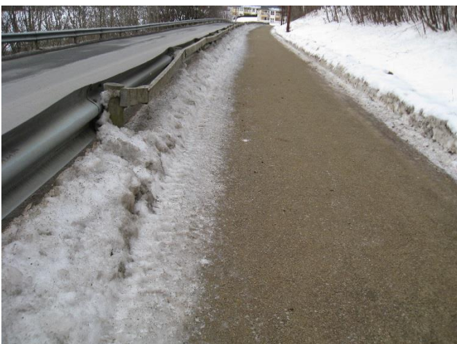
Figur 16. God friksjon etter sandstrøing. Foto: Øystein Larsen, Statens vegvesen
