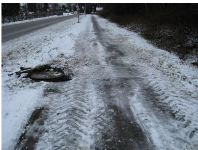
Figur 17 Problem med for høyt kumlokk. Foto: Øystein Larsen, Statens vegvesen
