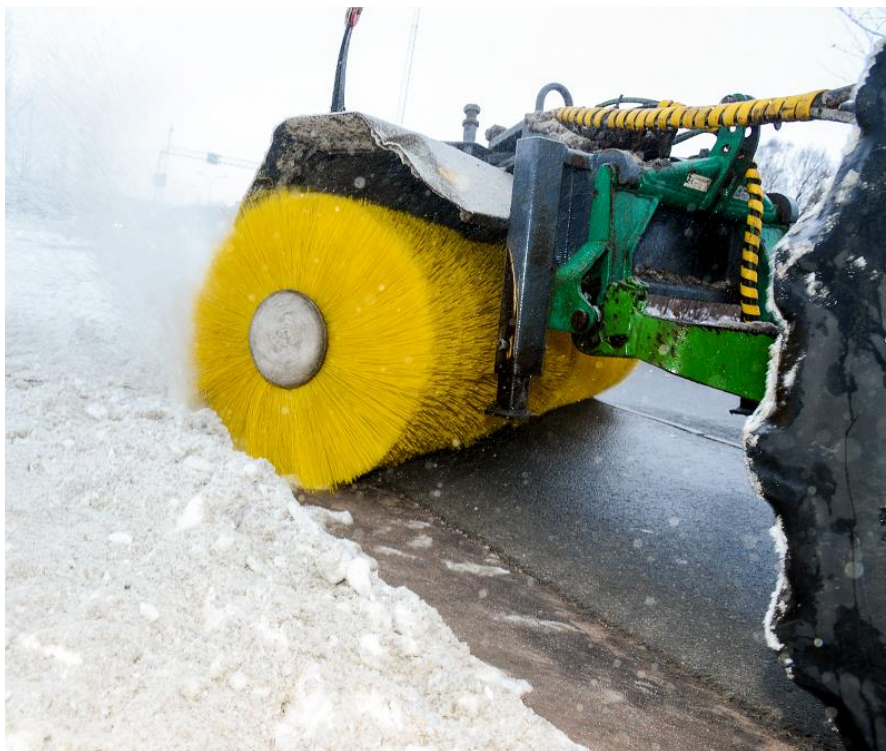
Figur 3. Godt resultat med bruk av kost. Foto: Knut Opeide, Statens vegvesen
