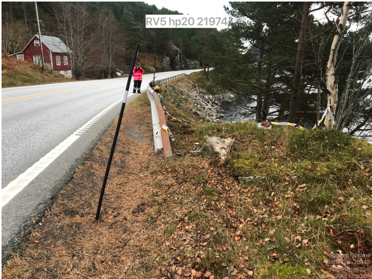
Figur 30 Bilde viser uheldig rekkverksavslutning. Kilde Statens vegvesen
