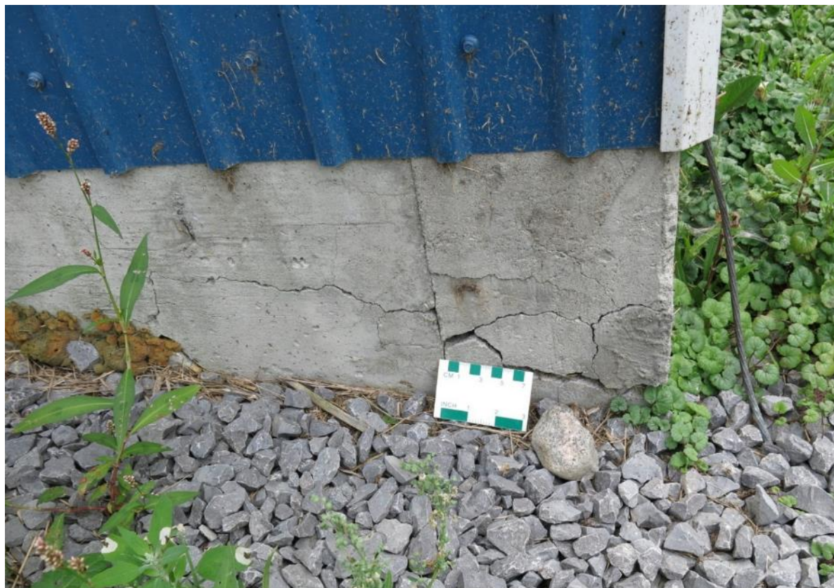
Figur 23 Nærbilde av skade på grunnmur. (Foto: Bård Pedersen)
