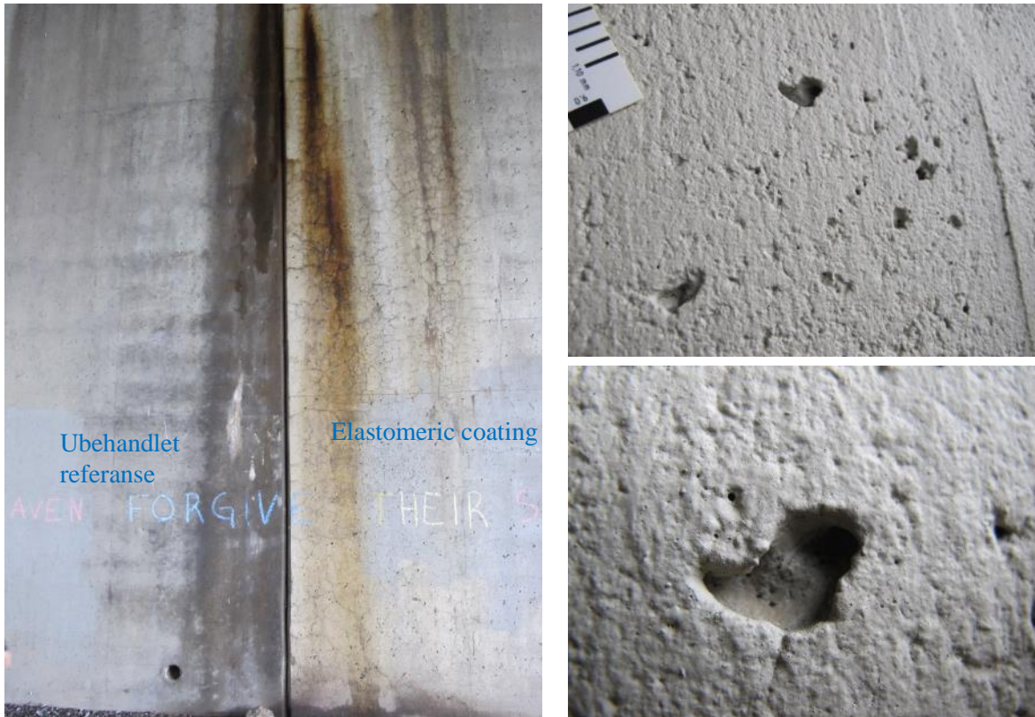
Figur 48 I-395 over Main Street. Landkar mot vest. Til venstre: Overgang ubehandlet/belagt område. Til høyre: Nærfoto av overflater med Elastomeric coating. Belegget virket tynt og fyller ikke porer i overflata. (Foto/ill.: Eva Rodum)
