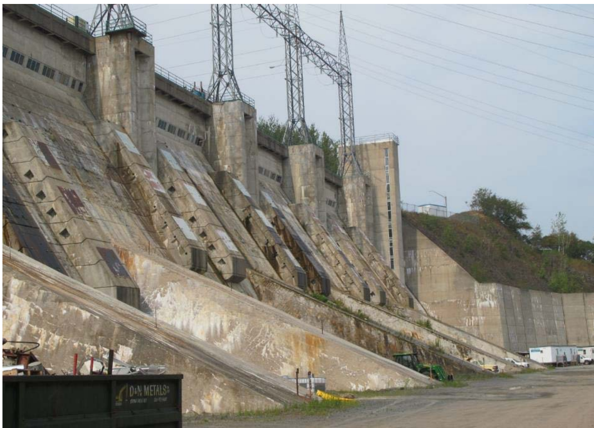
Figur 63 Foto av deler av dammen, se markering i Figur 62. Omfattende oppsprekking og kalkutfelling. (Foto: Eva Rodum)
