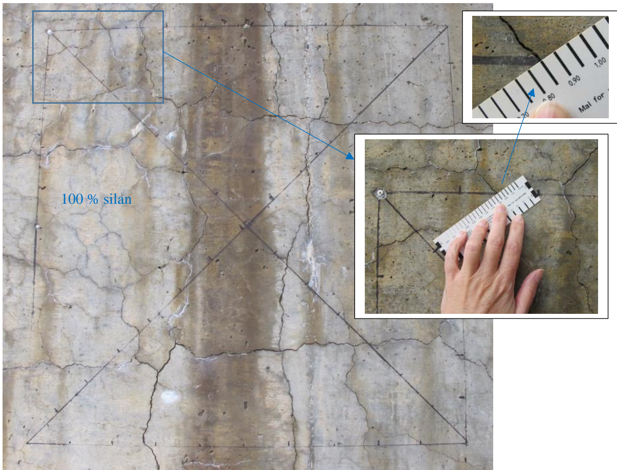
Figur 39 5th Parkway (Robertson Road) bridge over I-396. Site 6 (100 % silan). Rissvidde målt til 0,85 mm. (Foto/ill.: Eva Rodum)
