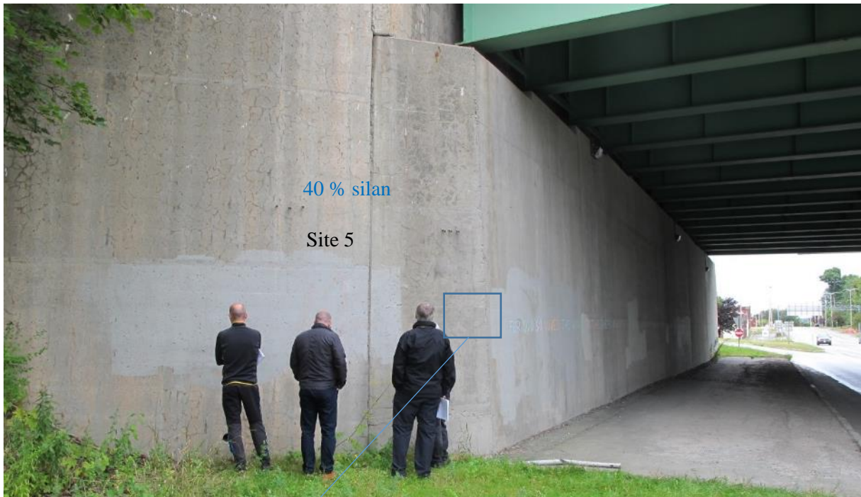
Figur 50 I-395 over Main Street. Oversikt landkar mot øst, område behandlet med 40 % silan. Nærfoto av område markert med firkant er vist i Figur 51. (Foto: Eva Rodum)
