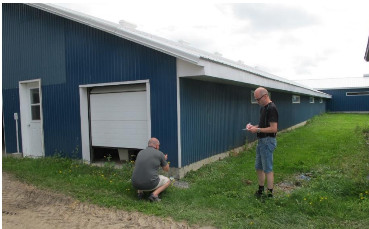
Figur 22 Fjøs bygd 2005. Ekspansjon og opprissing i grunnmur pga sulfatreaksjoner i betongen. (Foto: Eva Rodum)
