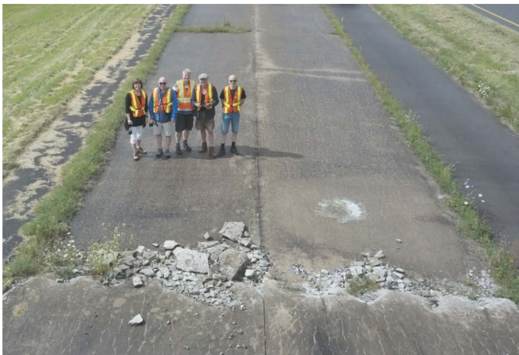
Figur 14 Oversiktsbilde. Deformert fuge i forgrunnen. (Dronefoto: Børge J. Wigum)
