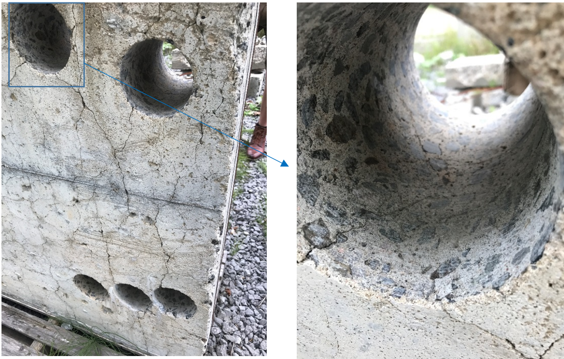
Figur 21 Til venstre: Foto av tilsaget element fra opprinnelig fuktig eksponert yttervegg, etter utboring av kjerner. Til høyre: Nærbilde av øvre venstre borhull, merk intern opprissing. (Foto: Jan Lindgård)
