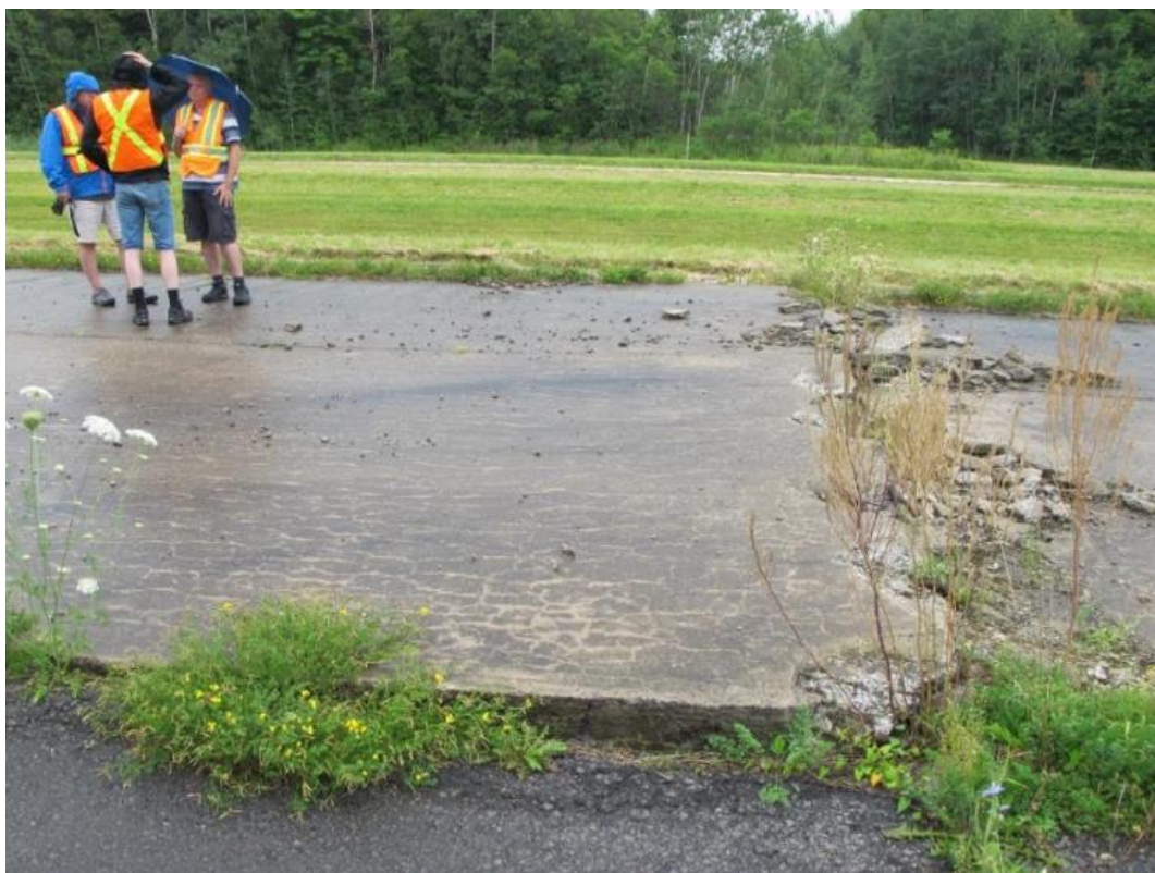
Figur 15 Støpt fuge med dybler. Kraftige deformasjoner. (Foto: Eva Rodum)
