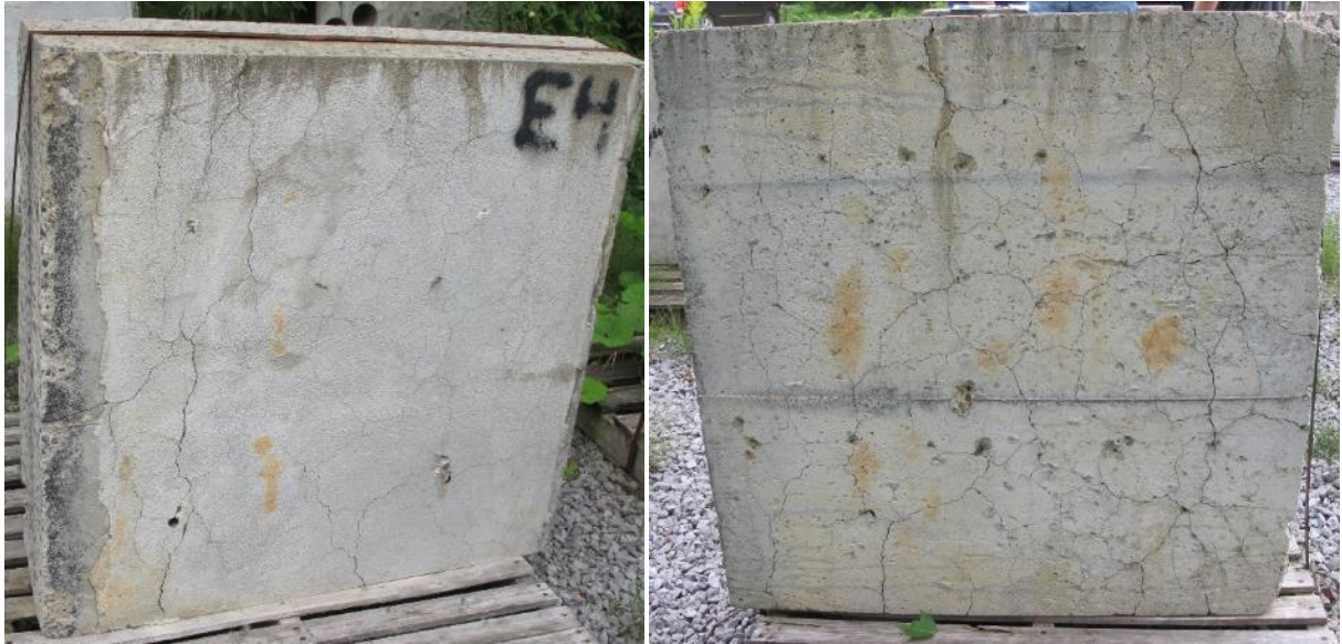
Figur 20 Kraftig opprisset element, saget til fra yttervegg - slemmet overflate (ytterside) til venstre, ubehandlet overflate (innerside) til høyre. (Foto: Eva Rodum)
