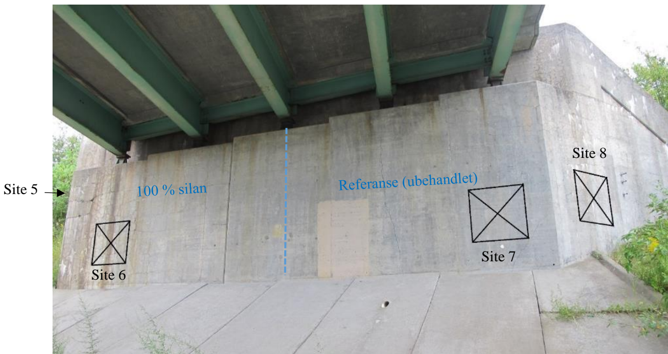
Figur 37 5th Parkway (Robertson Road) bridge over I-396, landkar mot nord. Venstre halvdel er behandlet med 100 % silan, høyre halvdel er ubehandlet referansefelt. Målelinjer for rissvidder (Site 6, 7 og 8 iht. /23/) er forsterket på fotoet. (Foto/ill.: Eva Rodum)
