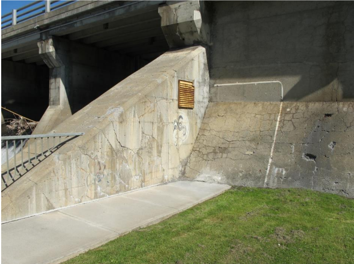
Figur 31 Skadesituasjon i 2017. Skråpilar til venstre er den samme som avbildet i 1987, se Figur 30. (Foto: Eva Rodum)
