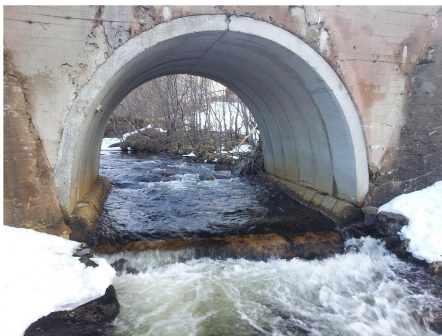
Fig. 76. Kulverten i Storelva ved Tromvik (Tromvikvassdraget). Høy vannhastighet og sprang ved utløpet. Bildet ble tatt på middels vannføring (Foto: Lars Aage Gade-Sørensen).
