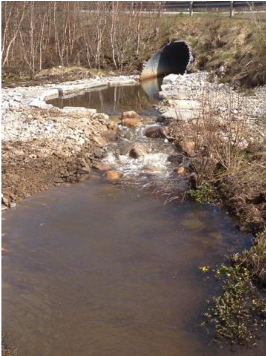
Fig. 64. Solid steinplastring langs sidene og terskel etablert på brekket. Vannspeilet står inn i kulverten og resulterer i gode vandringsforhold for fisk. I fiskerennen opp til terskelbassenget er steiner strategisk plassert med hensikt å bryte vannstrengen og lette vandringen for fisk opp i bassenget (Foto: Kenneth Fox).
