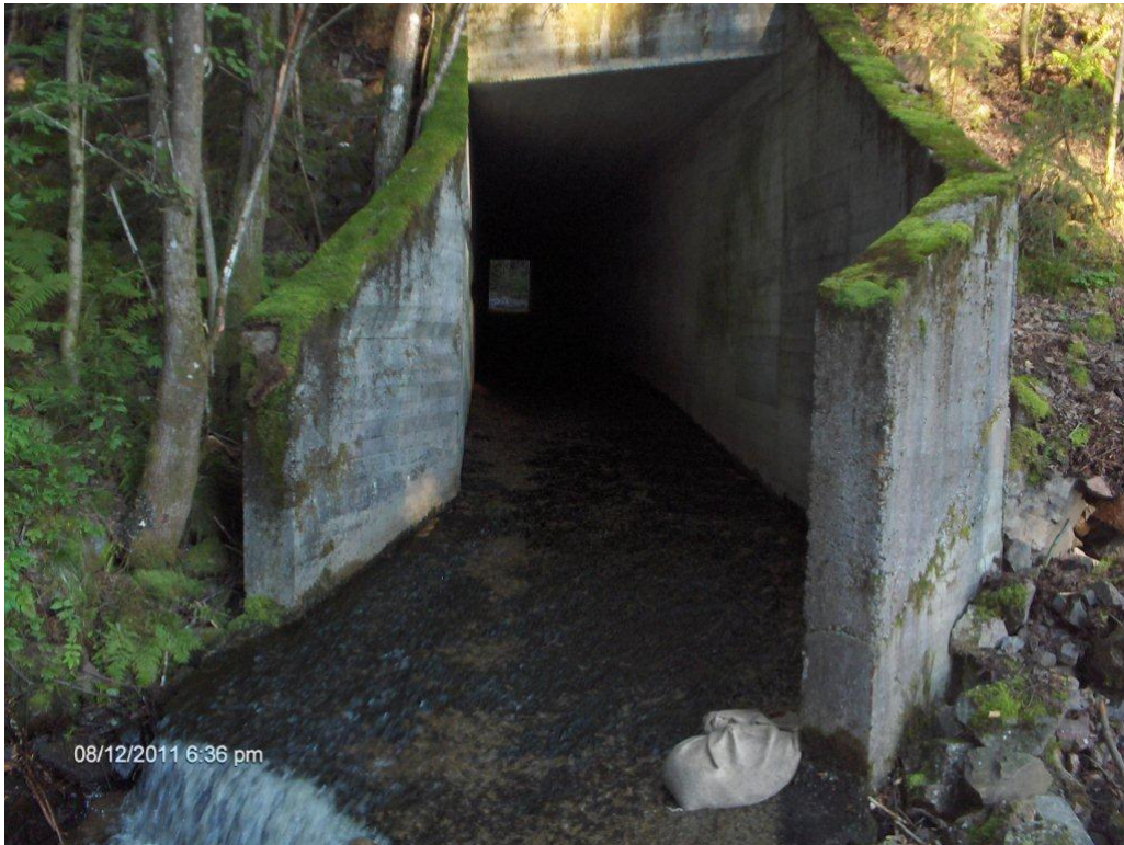
Fig. 32. Flat betongkulvert i Sarumelva. Høy vannhastighet gjennom kulverten og vanskelige vandringsforhold for fisk (Foto: Torleiv Inge Kili).
