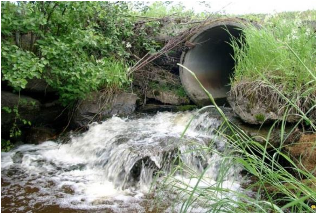
Fig. 54. Høyt fall og stein ved utløpet hindrer for fiskeoppgang gjennom kulverten i Hamremselva (Foto: Statens vegvesen Region midt).
