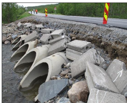
Fig. 23. Underdimensjonert hydraulisk kapasitet på kulvertene kan resultere i store skader på vegkroppen ved innløpet til kulvertene (Foto: Øyvind Haugland).
