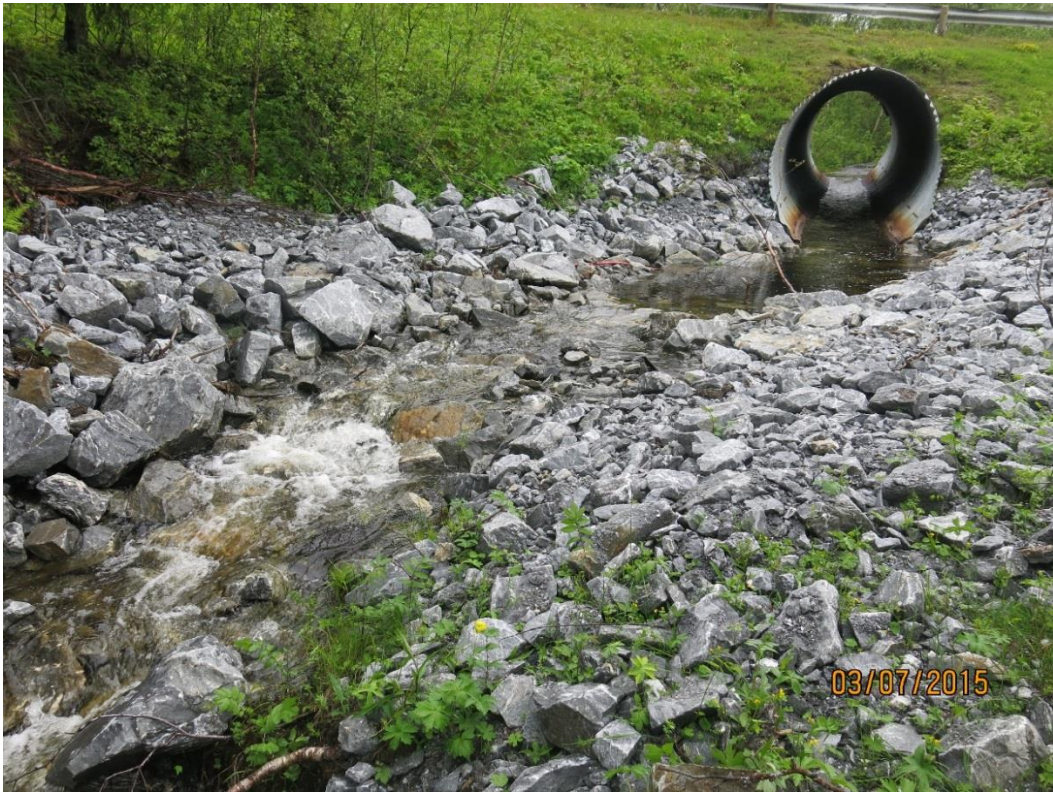
Fig. 2. Nedstrøms kulvertutløpet er det anlagt en terskel med en fiskerenne opp til terskelbassenget (Foto: Lars Aage Gade-Sørensen, Statens vegvesen Region nord)
