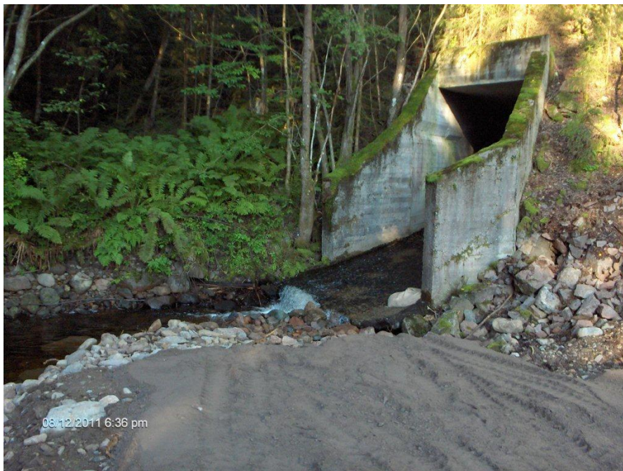
Fig. 31. Betongkulvert med flat bunn og ved utløpet dannes et sprang. Grunn kulp under spranget fra kulverten (Foto: Torleiv Inge Kili).
