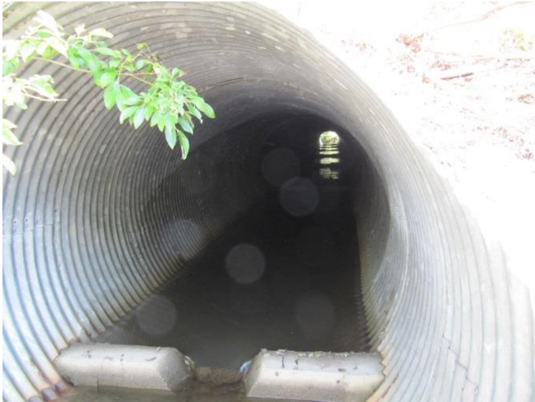
Fig. 28. Oppmurte fisketrapper montert inni kulverten (Foto: Sigrun Børresen).
