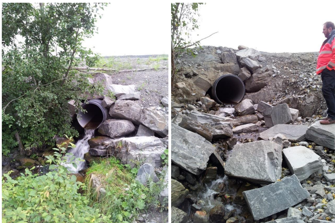
Fig. 51. Høyt sprang ved utløpet av kulverten og mye stein nedstrøms kulvertutløpet hindrer for fiskeoppgang (Foto: Statens vegvesen Region Midt).
