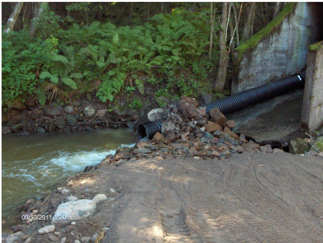
Fig. 33. Bekken ble ledet gjennom rør under hele byggeprosessen (Foto: Torleiv Inge Kili).
