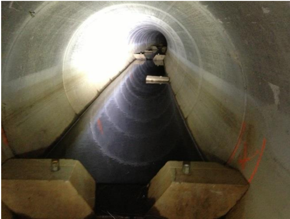
Fig. 42. Fisketrappene er montert på betongsåle inni kulverten (Foto: Paul Ridola).
