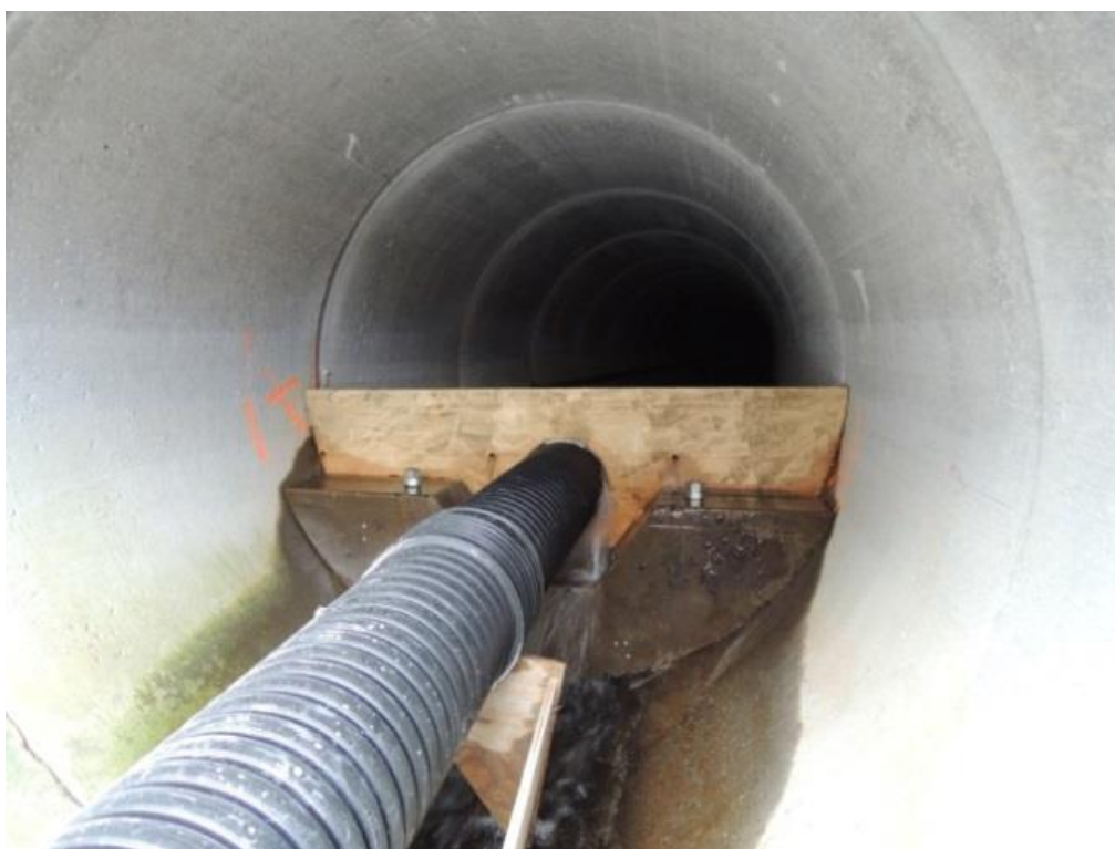
Fig. 39. Underveis i byggefasen av tersklene inni kulverten. Vannet i bekken ledes gjennom rør i hele anleggsperioden (Foto: Paul Ridola).
