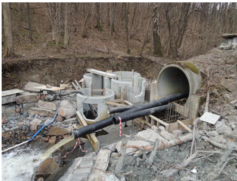
Fig. 40. Anleggsområdet ved utløpet av kulverten. Flere rør brukes for å lede vannet i bekken gjennom anleggsperioden (Foto: Paul Ridola).
