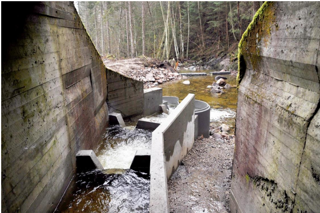
Fig. 35. Betongrør med åpen kant ved utløpet av laksetrappen. Bildet viser laksetrappen (til venstre) og vandrekana for andre dyr på høyre side (Foto: Statens vegvesen Region sør).
