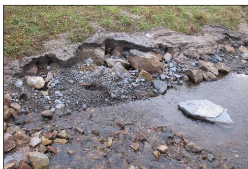
Fig. 24. Dårlig erosjonssikring langs sidene nedstrøms kulvertutløp, kan føre til store skader på vegkroppen og kantsonen (Foto: Øyvind Haugland).
