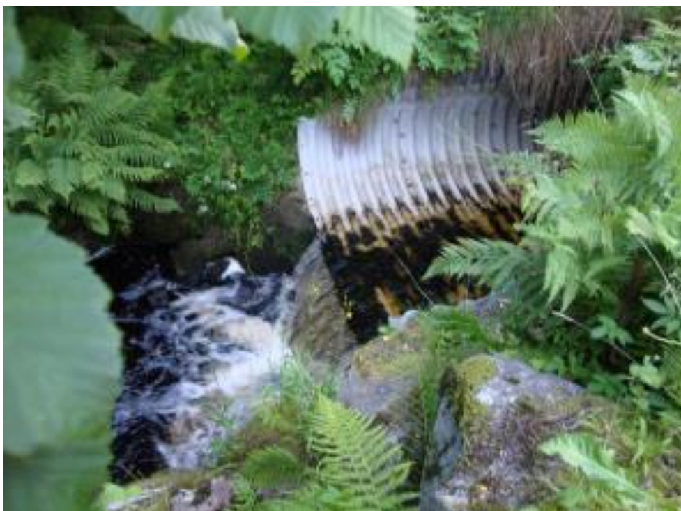
Fig. 48. Høyt fall ved kulvertutløpet utgjør betydelig vandringshinder for fisk (Foto: Statens vegvesen Region midt).
