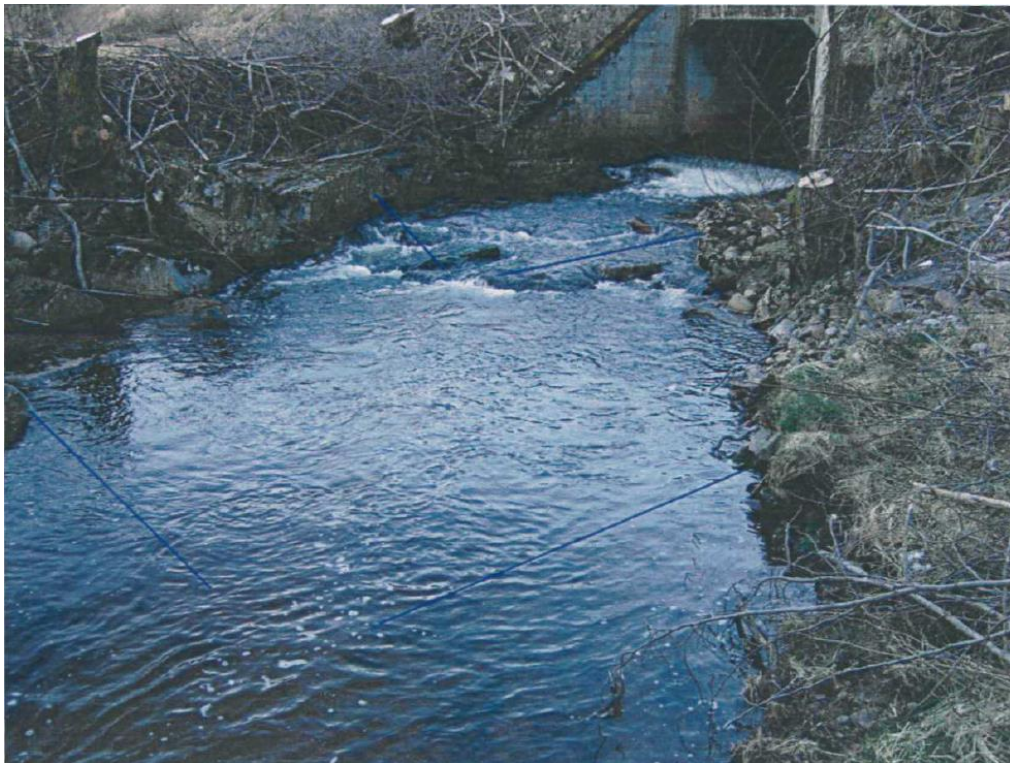
Fig. 44. Kulverten og kulpen nedstrøms kulvertutløpet i Breibeck (Foto: Alf Magne Midtbø Versland).
