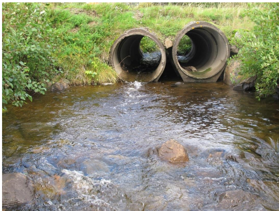
Fig. 69. To betongrør som ligger høyt i fyllingen og utgjør et betydelig vandringshinder for fisk. Vannstrømmen har erodert bort støttemasser under kulvertene (Foto: Øyvind Haugland).
