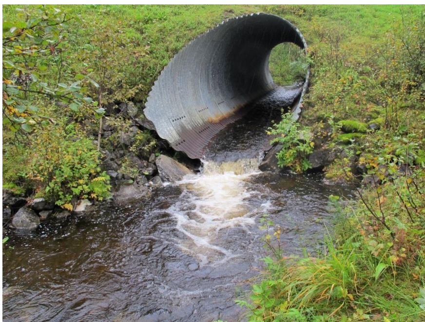
Fig. 1. Kulvert med høyt sprang ved utløpet og stor vannhastighet gjennom kulverten. Dårlige forhold for fiskevandring (Foto: Øyvind Haugland, Statens vegvesen Region nord).
