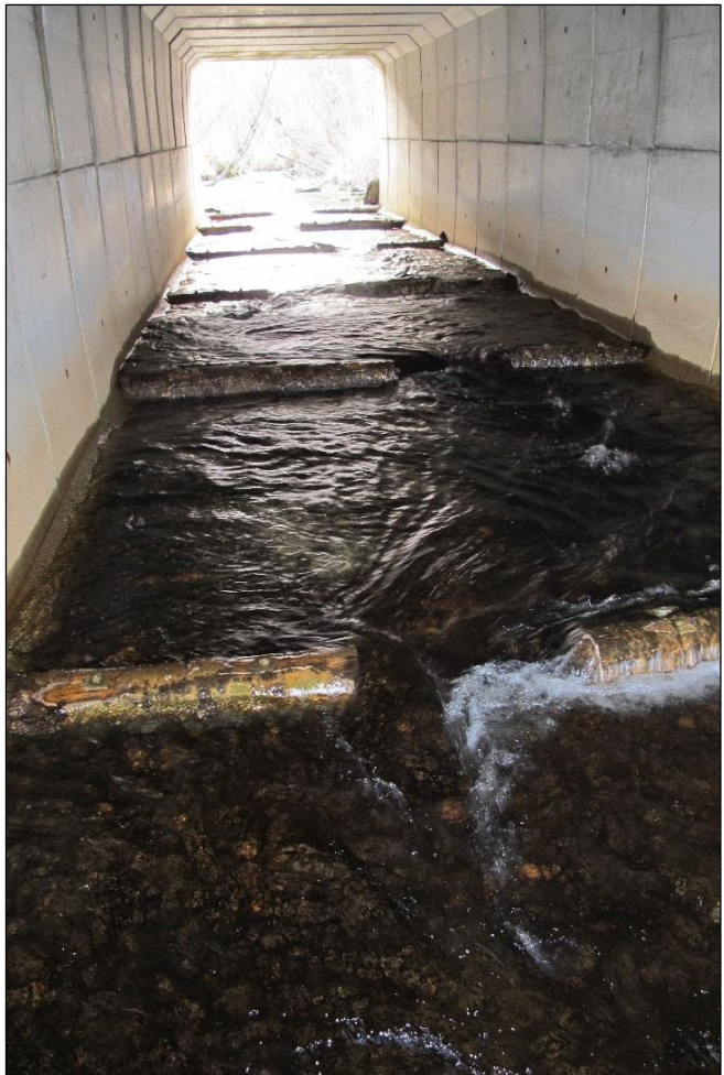
Fig. 20. Kulvert med ospestokker som fisketrapp (Foto: Øyvind Haugland).
