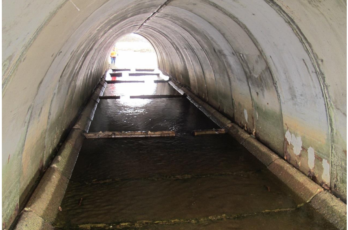
Fig. 61. Ospestokkene bremser vannhastigheten inne i kulverten og gjør oppvandringen for fisk lettere. Bildet er tatt på fjære og ved lav vannføring (Foto: Øyvind Haugland).
