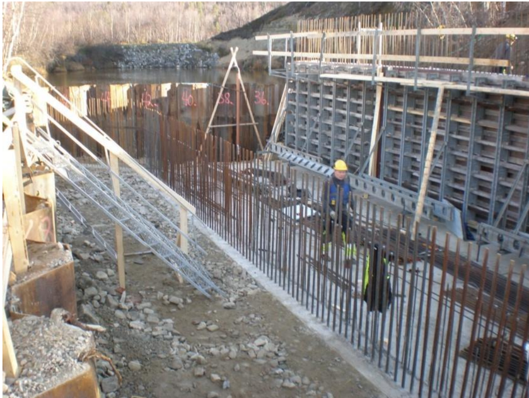
Fig. 82. Støping av betongkulvert i Savkadasjohka. Spuntet byggegrop ble brukt i prosjektet og gjør det mulig for entreprenøren å jobbe tørt (Foto: Haile Garmann Hansen).
