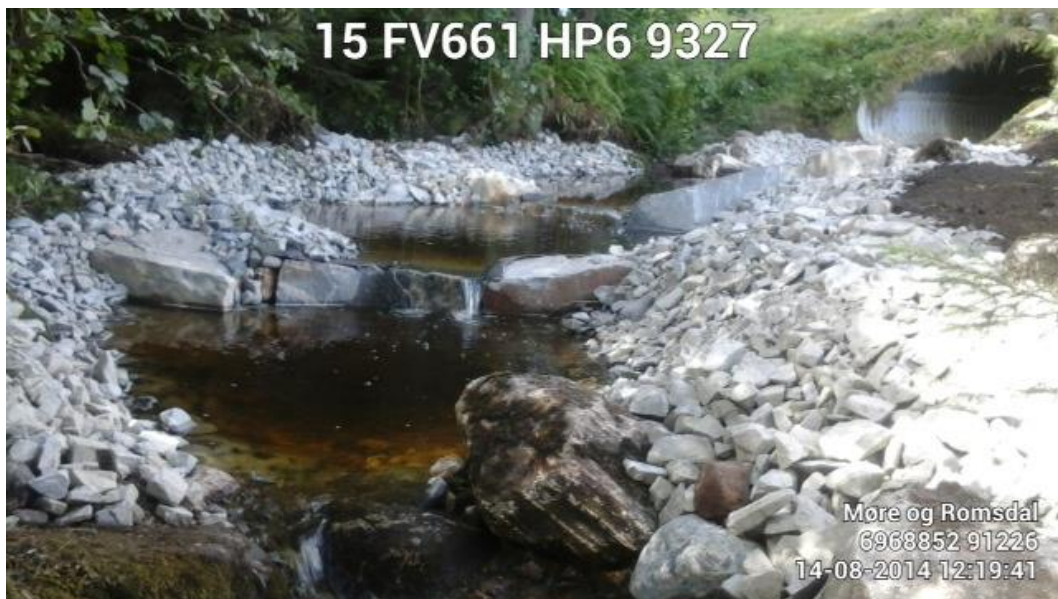
Fig. 50. Tre terskler er anlagt nedstrøms kulvertutløpet i Stokkelandsløken. Vannspeilet står inn i kulverten. Sprengstein er brukt som erosjonsikring langs sidene (Foto: Statens vegvesen Region midt).
