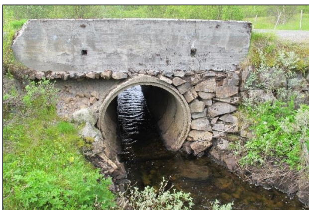
Fig. 25. Dårlig fundamentering og sikring ved innløpet til en kulvert kan føre til at massene rundt kulverten eroderes bort ved høy vannføring, flom og isgang (Foto: Øyvind Haugland).
