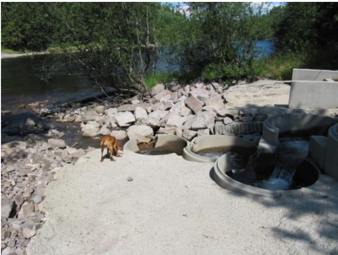
Fig. 29. Betongringer med åpning montert nedstrøms kulvertutløp. Utløpet til Numedalslågen til venstre i bildet (Foto: Sigrun Børresen).
