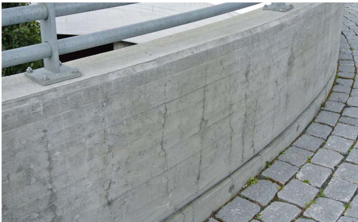
Figur 3 Eksempel på riss i kantbjelke pga. fastholding fra det tidligere støpte brulegemet [2]
