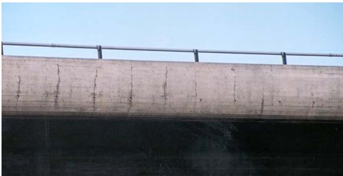
Figur 2 Eksempel på riss i kantdrager pga. fastholding fra det tidligere støpte brulegemet (foto: Steinar Helland)
