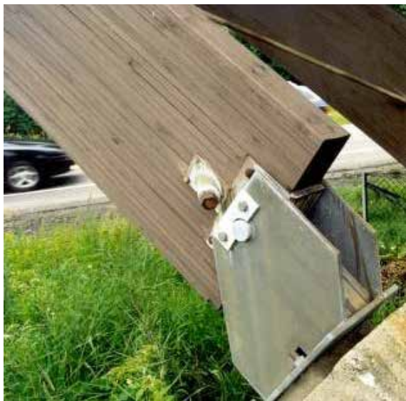
Figur 12-1: 30 år gammelt, tørt og oppsprukket CCA-impregnert limtre Figure 12-1: 30 years old, dry and cracked CCA-treated glulam timber
