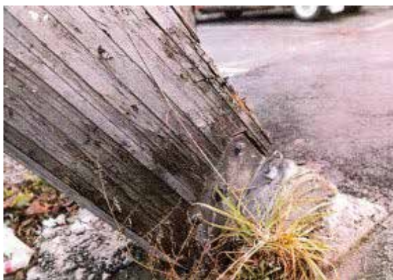
Figur 10-23: Opplager med oppsprekning, delaminering, mekanisk skade og tilgroing
