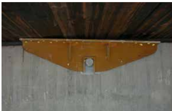
Figur 7-14: Sidestyring ved hjelp av åk og innstøpt bolt. Sundbyvegen bru Figure 7-14: Lateral support by means of yoke and cast-in bolt. Sundbyvegen Bridge
