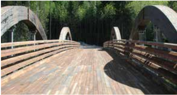
Figur 7-19: 12 år gammelt slitelag av kreosotimpregnert plank. Daleråsen bru Figure 7-19: 12 years old wearing course of creosote treated planks. Daleråsen Bridge
