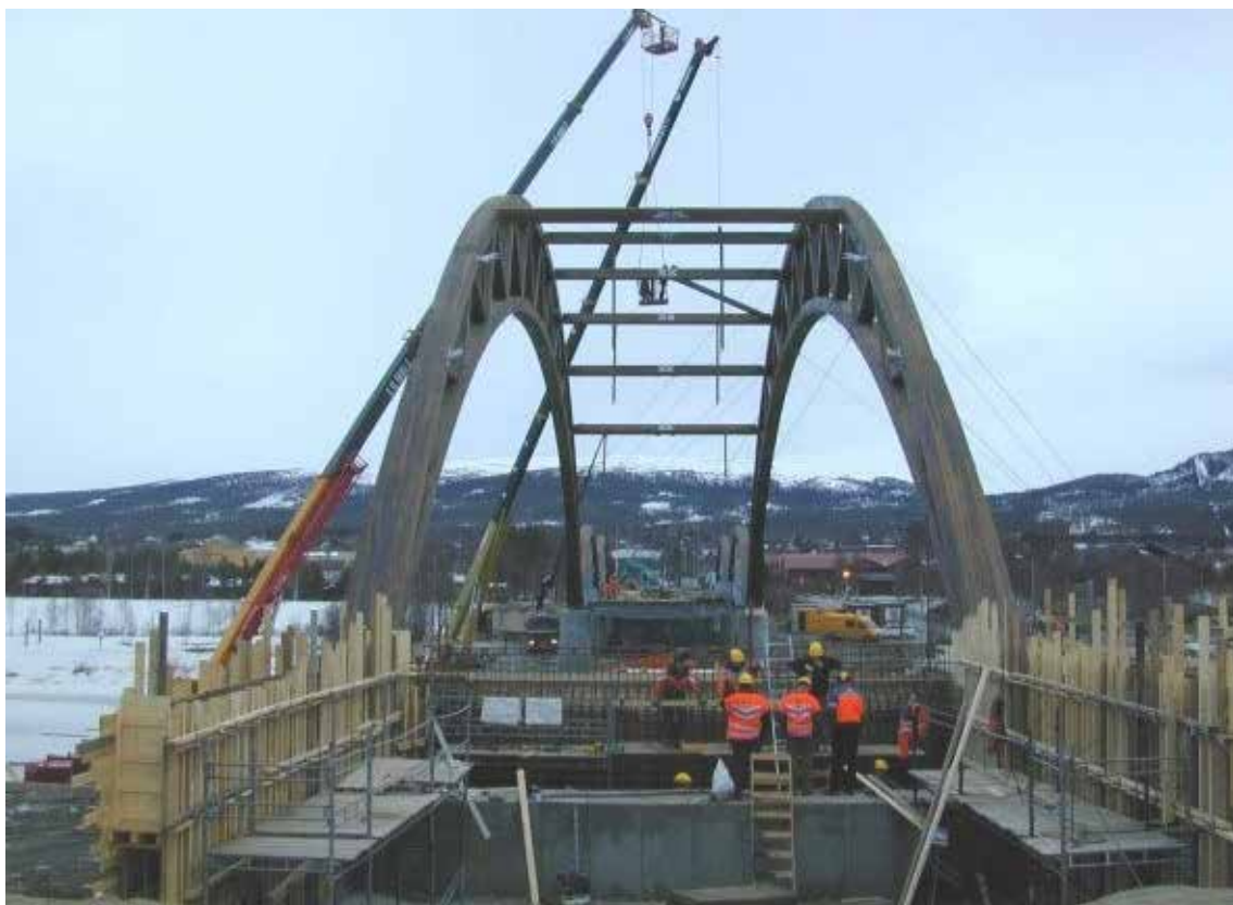
Figur 11-3: Montasje av fagverksbuer på Tynset Figure 11-3: Erection of trussed arches at Tynset
