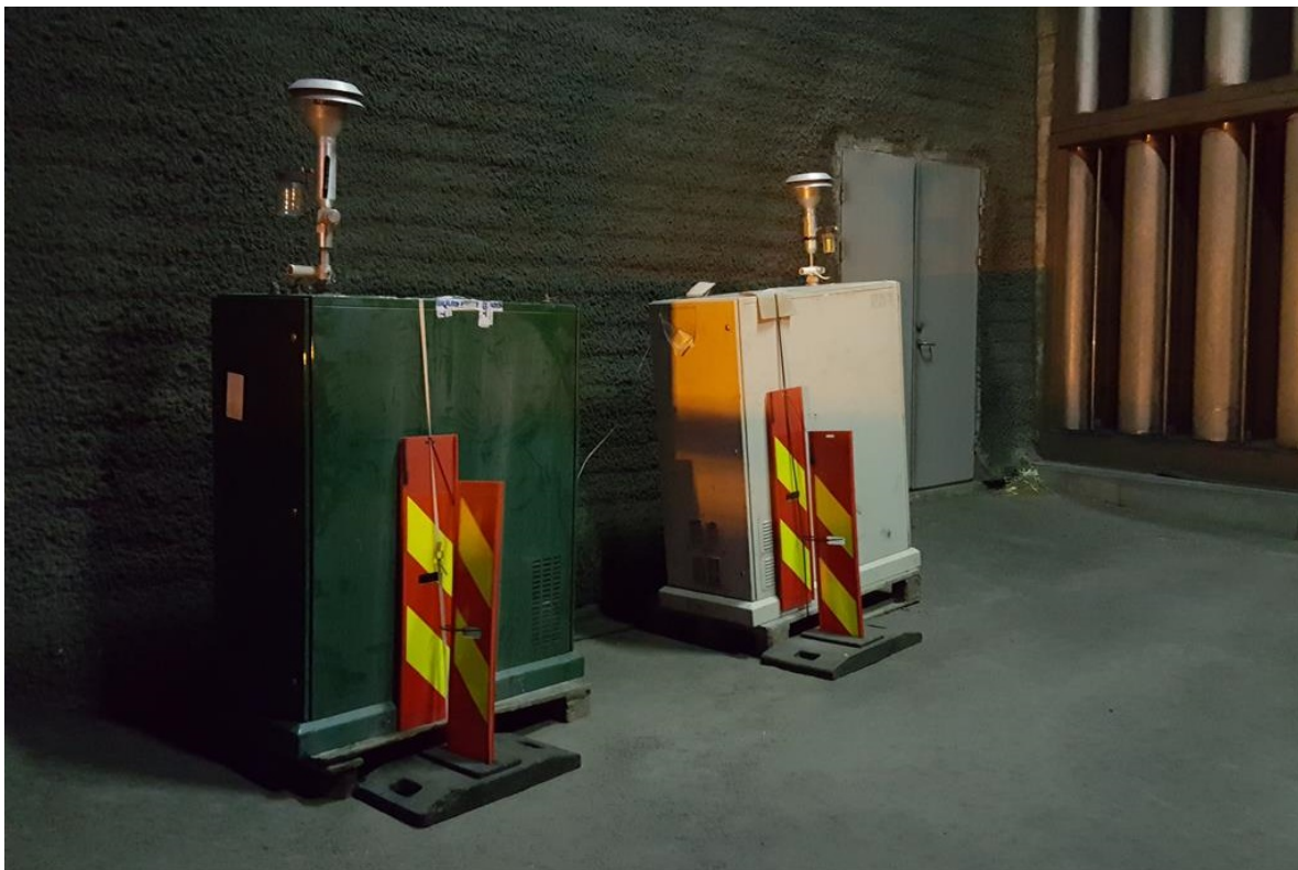
Figur 110: Måleutstyr for PM2,5 og PM10 ved avtrekksjakta i Karmøytunnelen
