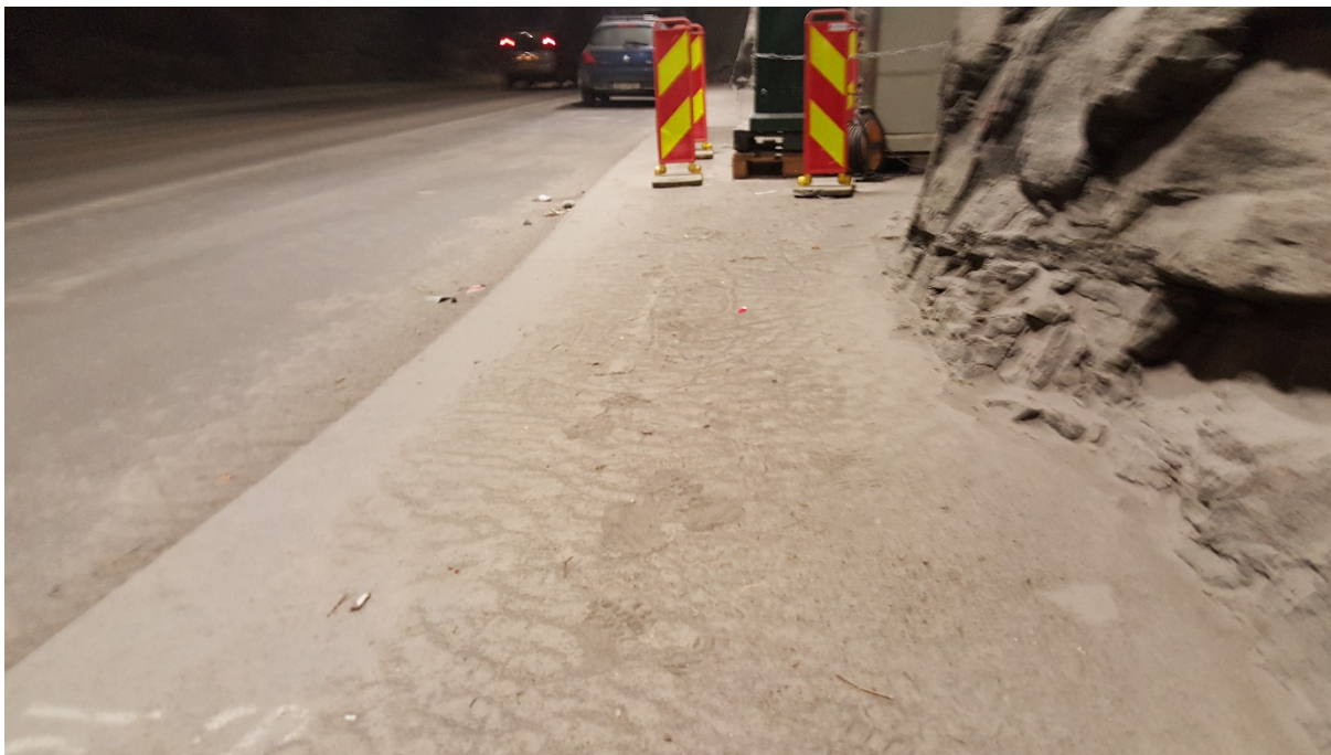
Figur 10: Sanddyner på sidearealet er eit vanleg syn i norske tunnelar om vinteren (Rv. 5 Fatlatunnelen)
