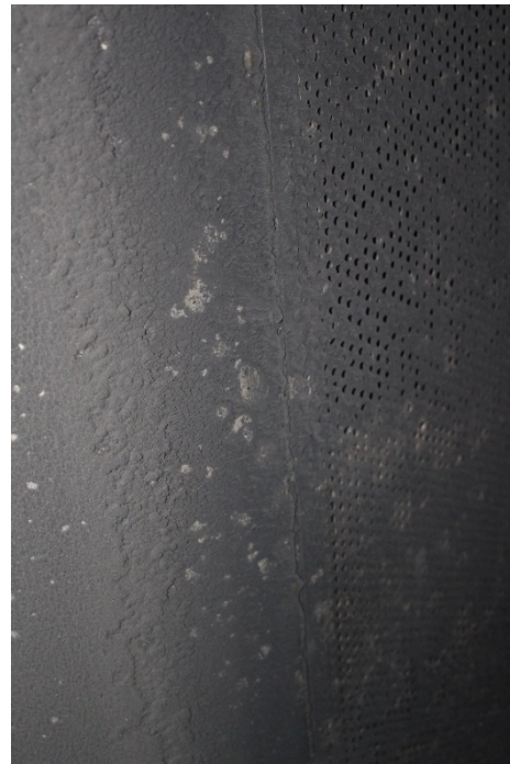
Bilde 5. Ansamling av støv på lydfelle ca. 2,5 m over gulvplan høyre side av kjøreport. Støvvavleiring på de perforerte platene og på utløps siden.
