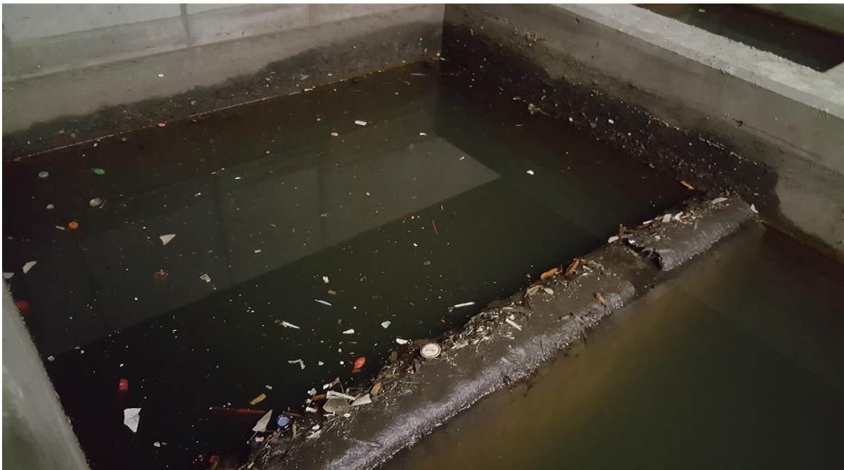
Figur 164: Eksempel på slamavleiring på toppen av delevegg i slam- og oljeavskiljar
