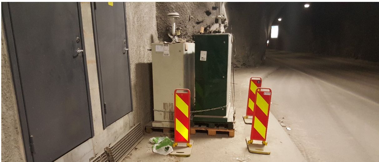
Figur 26: Måleutstyr for støv er plassert på sidearealet i ei havarinisje
