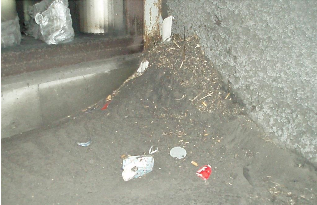
Figur 117: Ventilasjonsanlegget transporterer store mengder fin sand, papir og plast langs bakken
