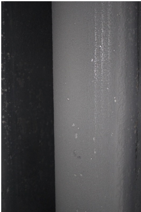
Bilde 4. Støv på utløpssiden av lydfellen ca. 1,5 m over gulvplan, høyre side i forhold til kjøreport.
