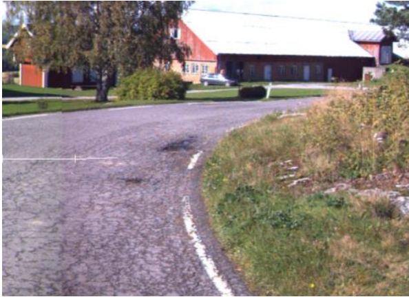
Figur C8 Krakelering på Fv 238 Hp 1
