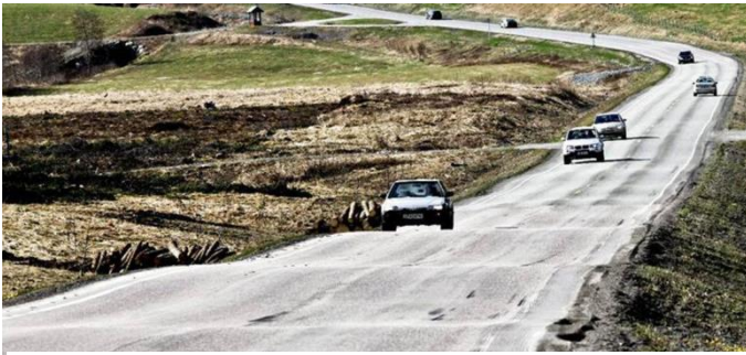
Figur B6 Veg på myr. Ujevn veg som følge av setninger. Oppretting og nytt slitelag er sjelden den beste løsningen. Mer omfattende tiltak er nødvendig.
