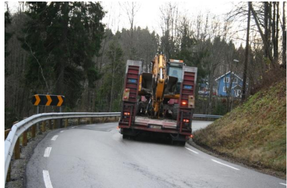
Smal veg, manglende grøft og tunge kjøretøy gir rask nedbrytning av vegen
