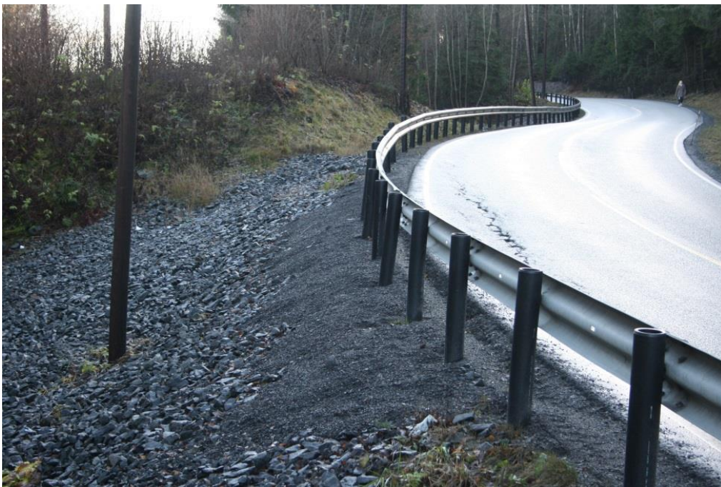
Figur A41 Alvorlige langsgående sprekker til tross for kult og skråning slakere enn 1:2
