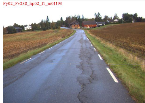
Figur C9 Kantskader på Fv 238 Hp 2
