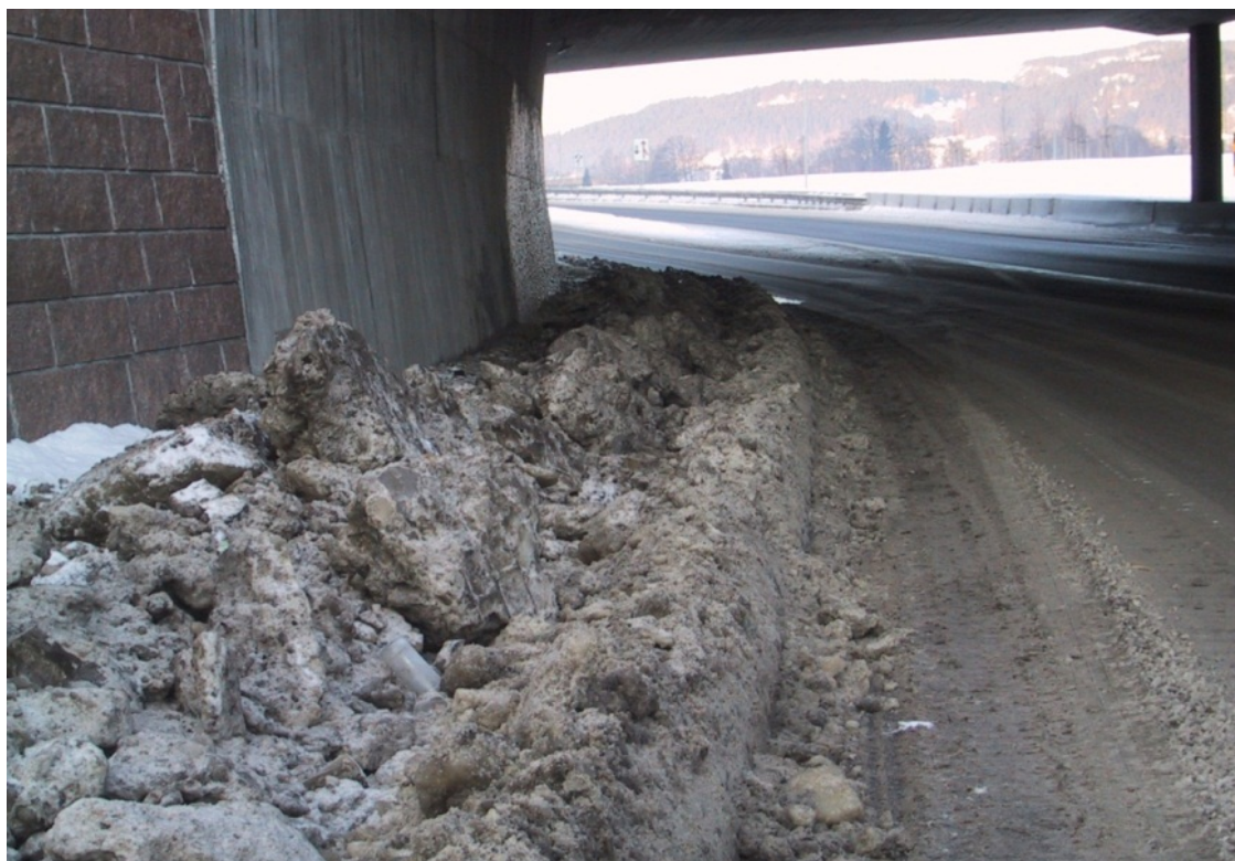
Figur 2-39 Ubrøytet fortau i undergang (Foto: Statens vegvesen)
