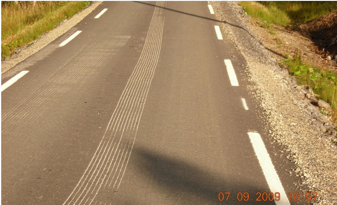
Figur 1-2 Skade på veg skal unngås
