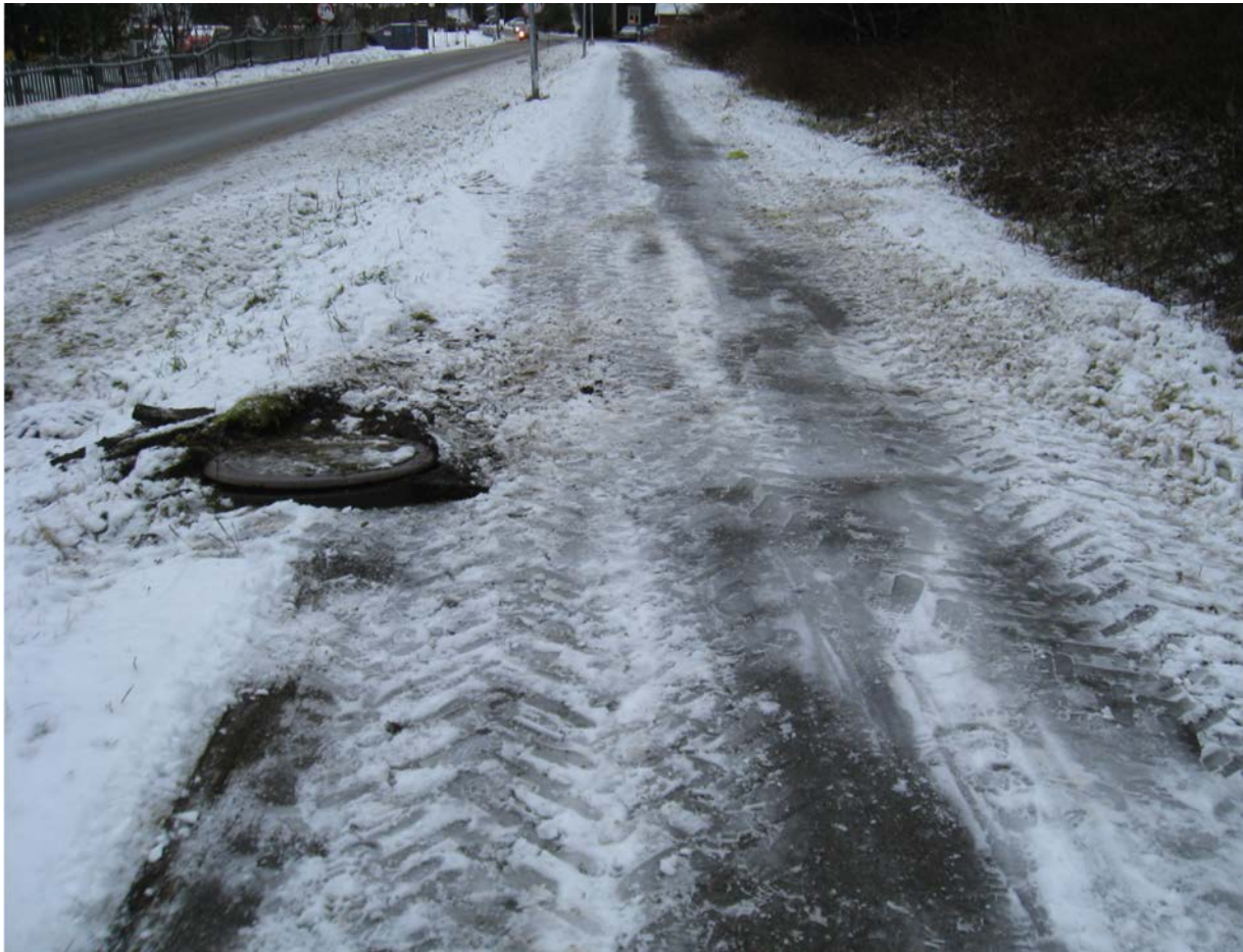
Figur 9-14 Skade på kummer/sluk (Foto: Øystein Larsen)
