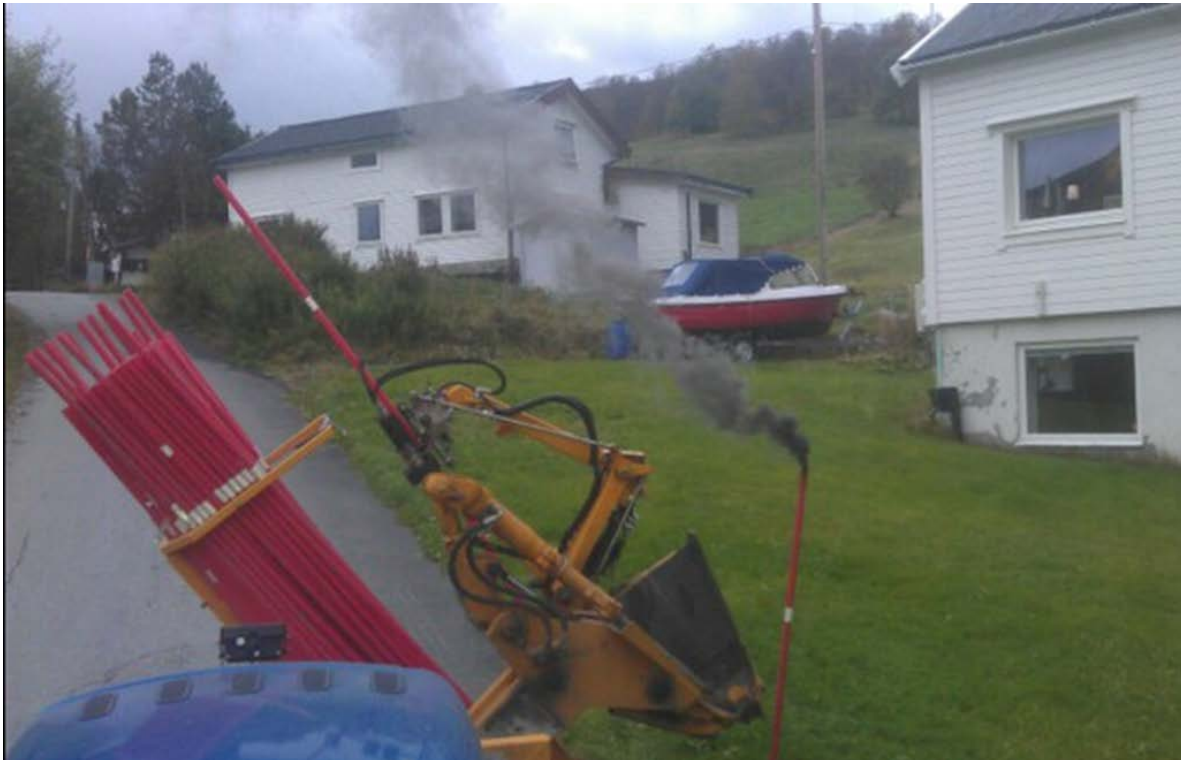
Figur 9-7 Stikksetter treffer høyspentkabel. (Foto: Harstad Kommune)
