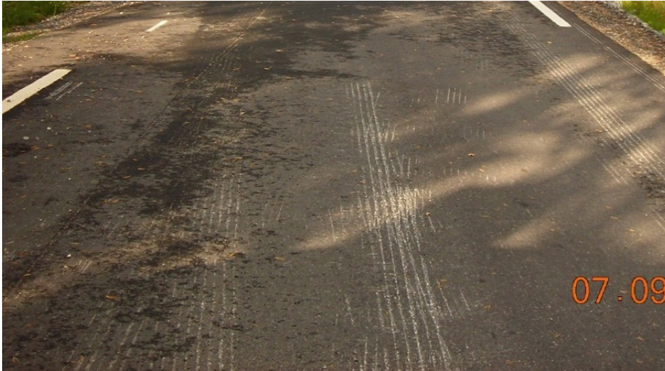
Figur 4-41 Skader på fast dekke (Foto: Statens vegvesen)
