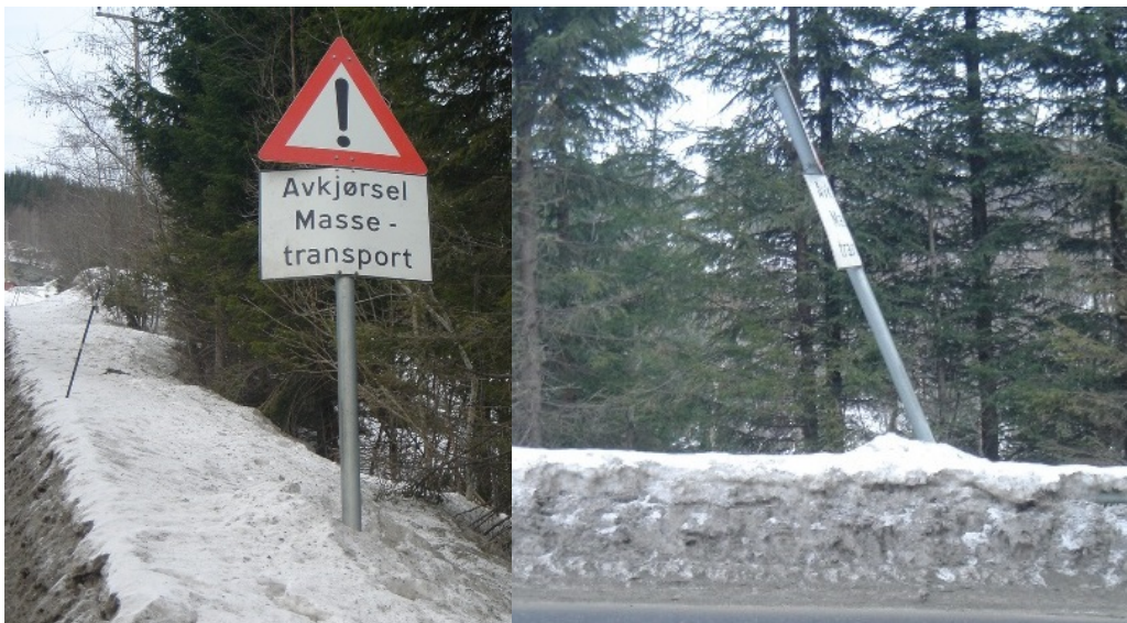
Figur 9-12 Skade på skilt (Foto: Statens vegvesen)
