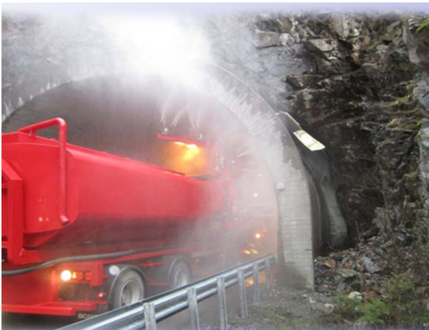
Figur 9-34 Tunnelvask (Foto: Veimas)
