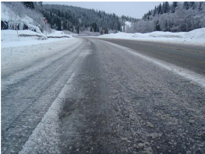
Figur 8-12 Dårlig brøyting vil gi dårlige kjøreforhold og høyt saltforbruk (Foto: Bård Nonstad, Statens vegvesen)
