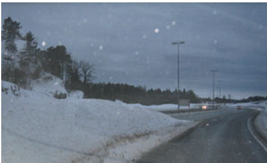
Figur 2-58 Ikke tilstrekkelig sikt fra påkjøringsrampe til motorveg (fartsgrense 100 km/t) (Foto: Arild Nærum)
