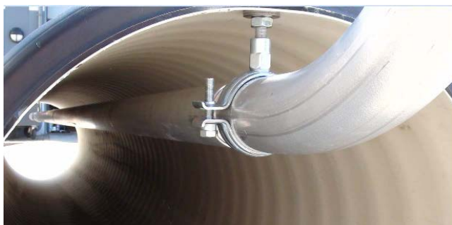
Figur 9-20 HeatWork. Tinerør montert inni stikkrenne (Foto: HeatWork)
