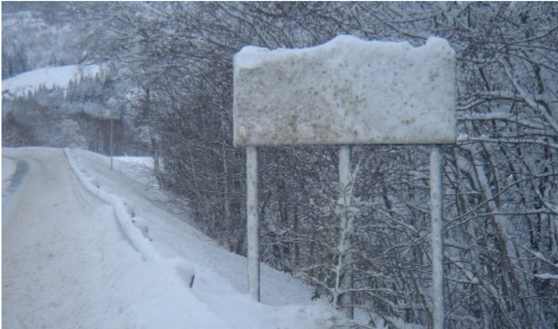
Figur 9-8 Snø på skilt som følge av sprut etter brøyting.
