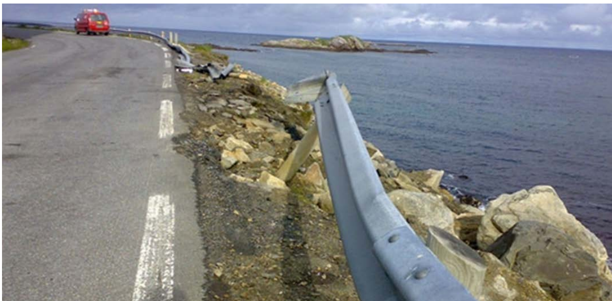
Figur 9-13 Skade på rekkverk (Foto: Statens vegvesen)
