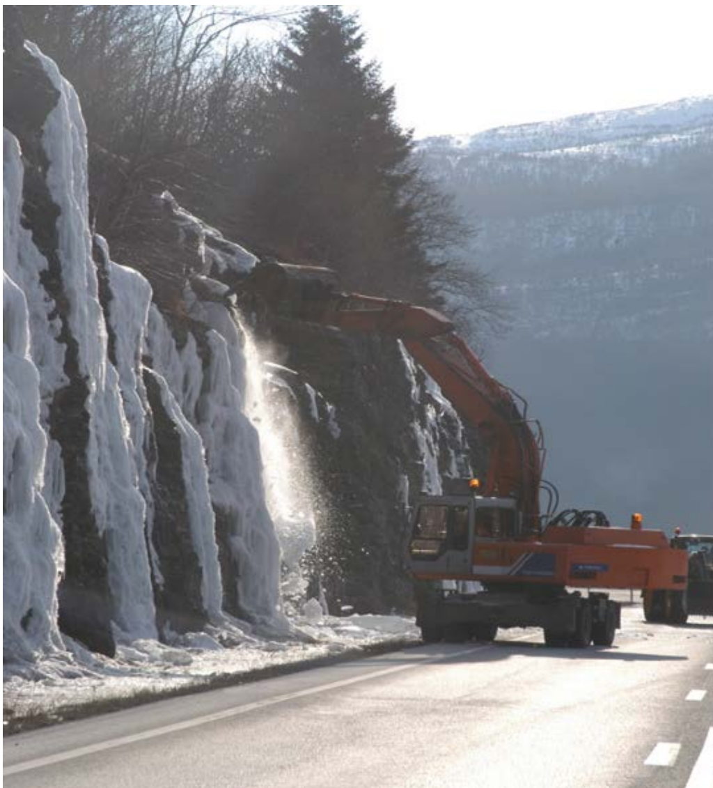
Figur 9-26 Rensk av is i skjæring. (Foto Statens vegvesen)
