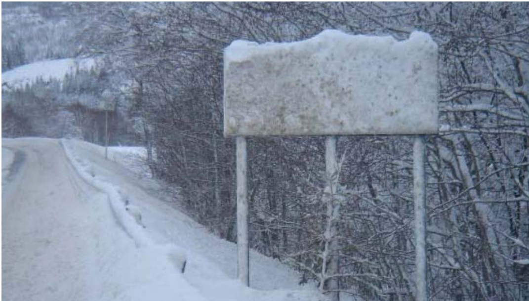
Figur 4-83 Nedsprutet trafikkskilt (Foto: SINTEF). Brøytefart over 40 km/t øker problemet med snø- og sløpesprut som dekker til skilt, og skader skilt, kantstolper, brøytestikk og andre installasjoner langs vegen.
