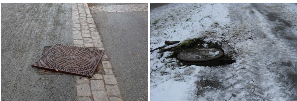
Figur 4-4 Kumlokkkramme ute av stilling (t.v.), kum med overhøyde(t.h.). Fare for hekting. Foto: Ø. Larsen
