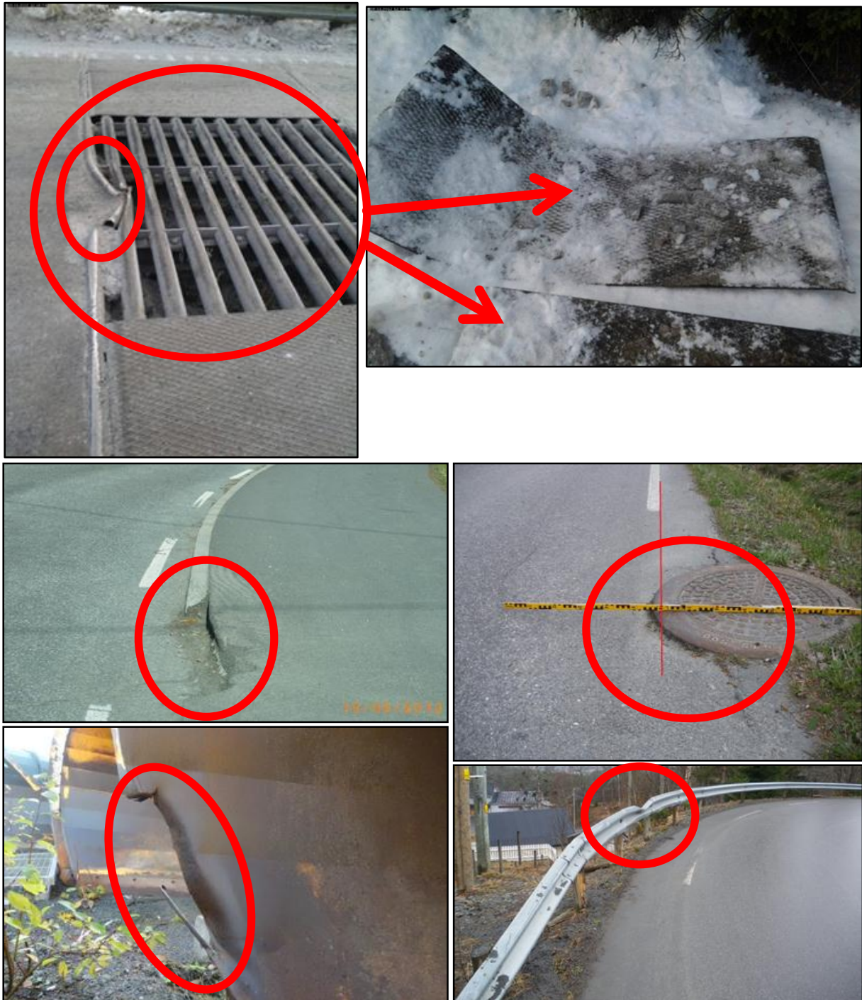
Figur 2-1 Eksempler på kritiske punkter og resultat av uønskede hendelser. Øverst: hekking/skade på ferist fra brøyting/høvling (venstre) og løsrevet dekkplater til ferist (høyre). Midten: Skade på kantstein fra brøyting (venstre) og oppstikkende kum, fare for hekking av plog/skjær (høyre). Nederst: Skade på plog etter påkjørsel (venstre) og skadet rekkverk (høyre). (Foto: Tom Roar Sveen og Statens vegvesen).
