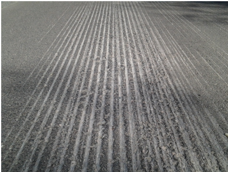
Figur 4-78 Dekkeskade grunnet uforsiktig høvling. (Foto: Håkon Svendsen)
