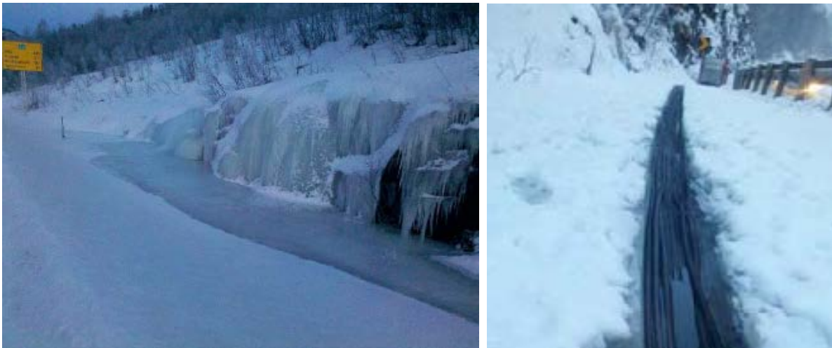
Figur 9-21 Problemer med is i grøfter og bruk av slanger for tining (Foto: Håkon Svendsen og Karl Olav Dahlberg, Mesta)
